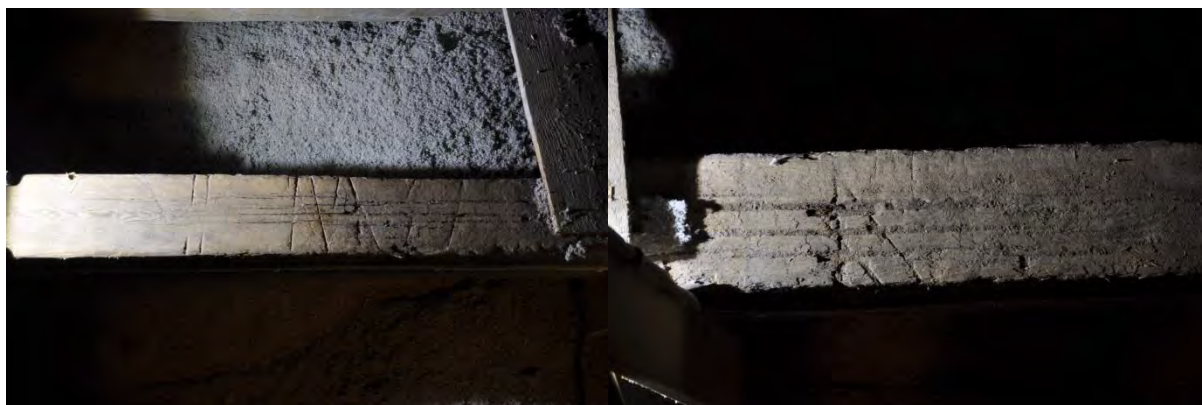
En av bindbjälkarna har märkliga skärningar på sin ovansida.
