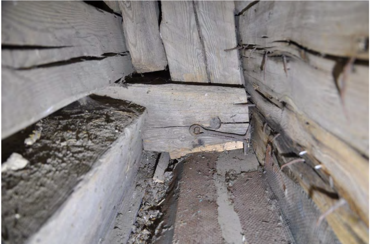
Detalj av takfoten. Änden på en bindbjälke med en sparre som ansluter uppifrån. Bindbjälkens undersida är uppvinklad och remstycket har en liten hylla där den ursprungliga takfotsbrädan suttit. Lägg märke till järnkroken i bindbjälken, en likadan finns även i en annan bjälke.
