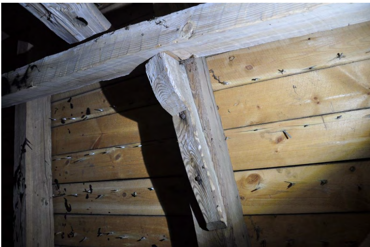
Överliggarna har på ett par ställen stöd av konsoller, spikade på sparrarna. Det kan vara en indikation på att sparrarna rests innan ramverket.
