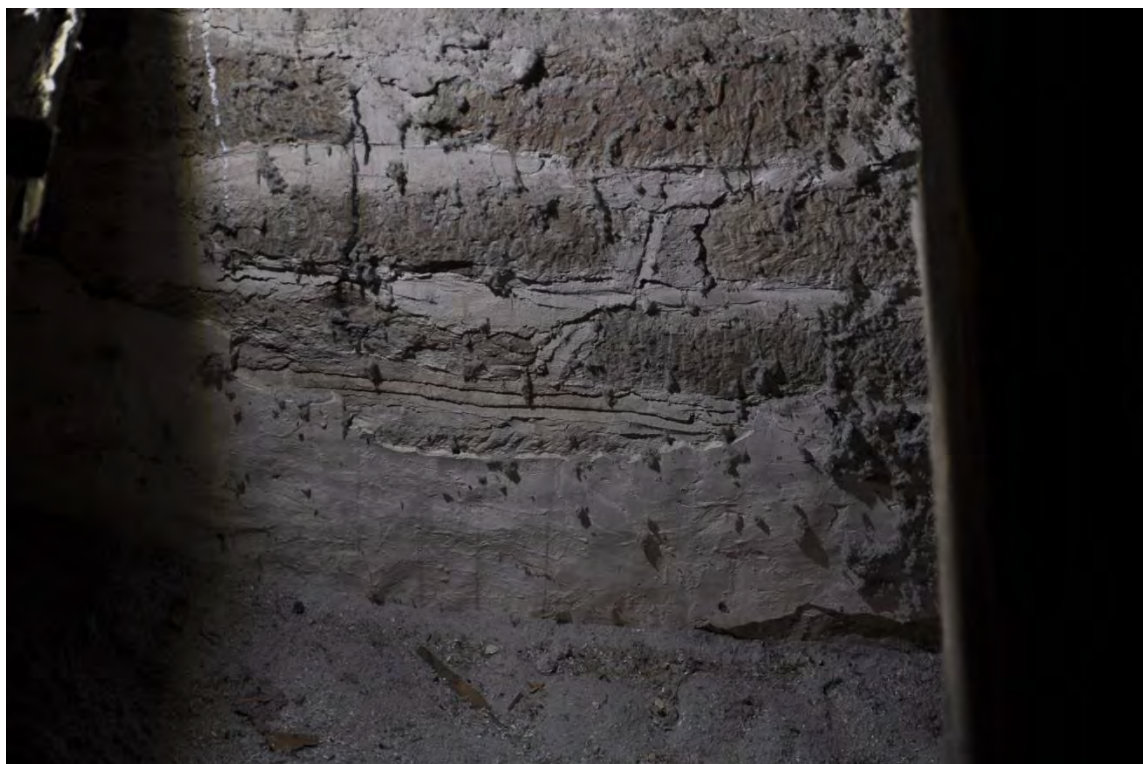
Längst ned i bild syns den lösullsisolering som täcker valven. På murväggen finns rester av en troligen medeltida puts. Där putsen fallit bort kan man se murfogarna med dubbla ritsar.
