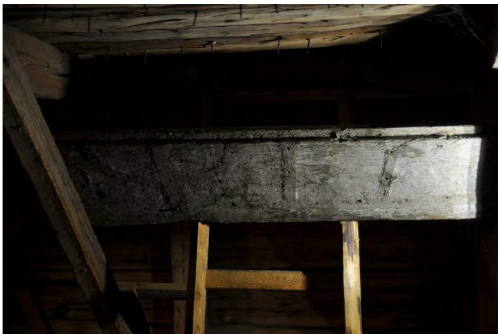
Del av ett mycket gammalt dörrblad. Erosionen har gjort att avtrycken från smidesdetaljerna framträder tydligt.
