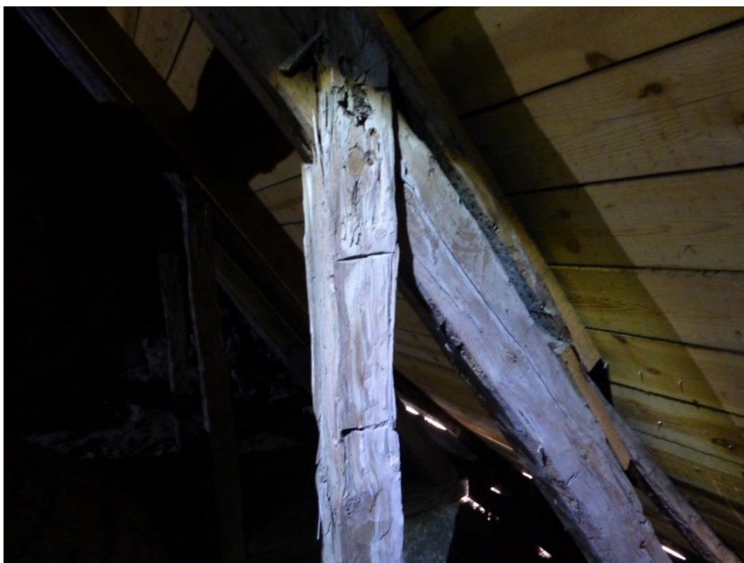
Sorunda kyrkas taklag har stickbjälkar med inbygg från svallbuggningen kvar, samt grov och slarvig behuggning, typisk för 1600-talets senare del. Bildnummer LP_2015_00069. Foto Bengt Bygdén
