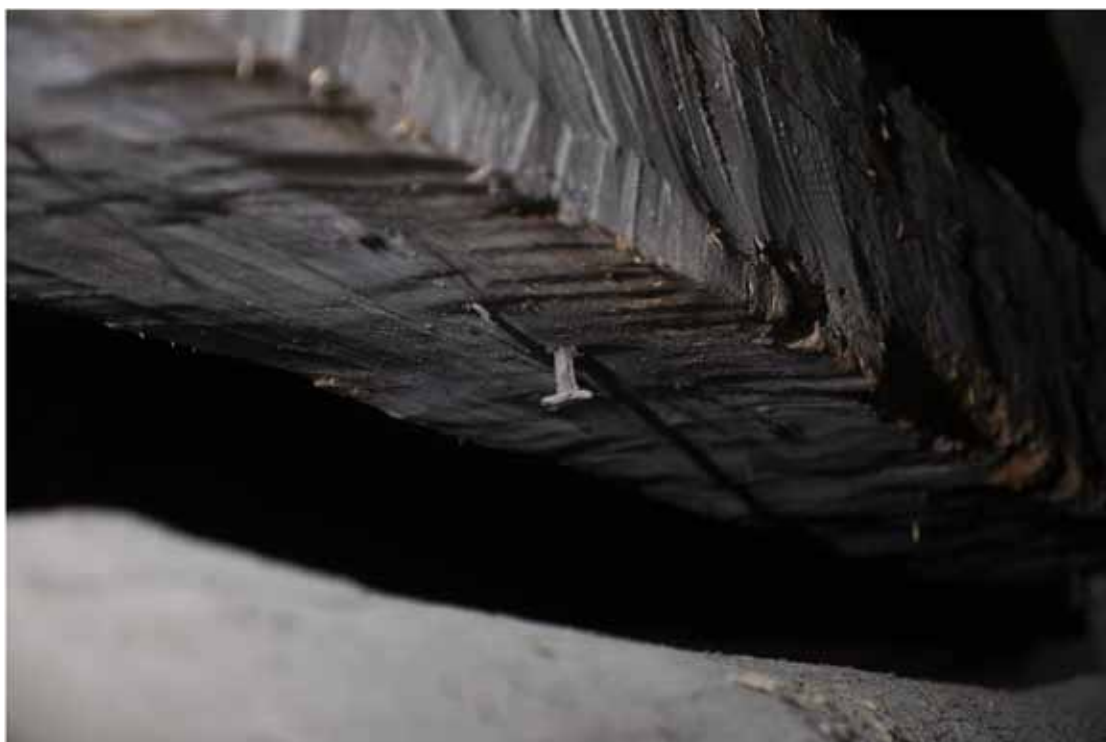
Kyrkorummet har under en tid haft ett plant innertak. Spikar finns fortfarande kvar på bindbjälkarnas undersida.
