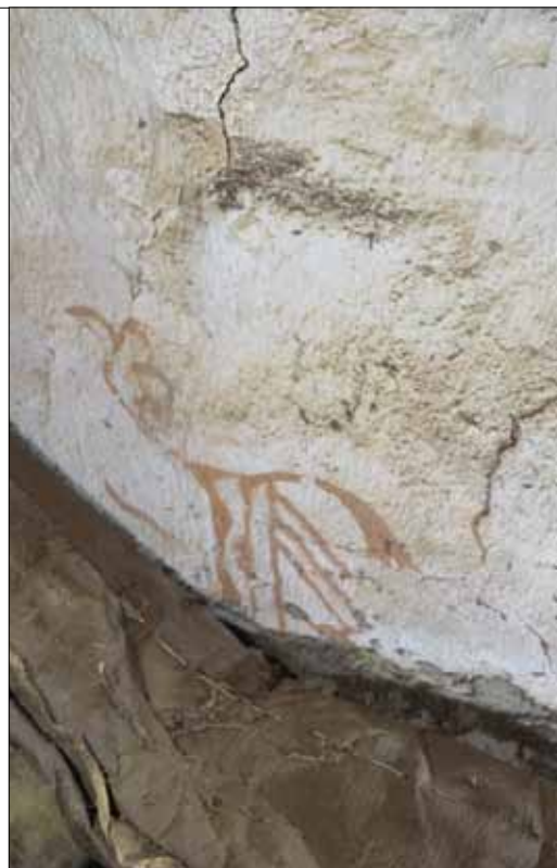
Fragment av kalkmåleri på östra gavelväggen (SLM D2015-1496).
