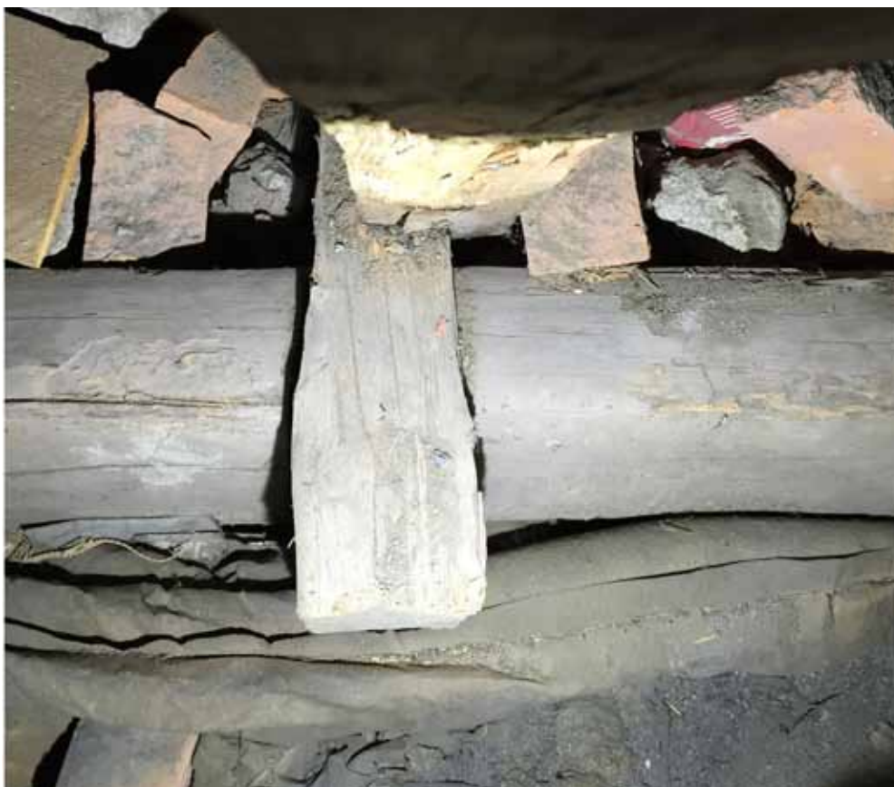
Här en stickbjälke laxad i remstycket. Valvbågens nedre virke står långt innanför remstycket. Märkligt, är det omgjort vid något tillfälle? Fotografi: Daniel Eriksson
