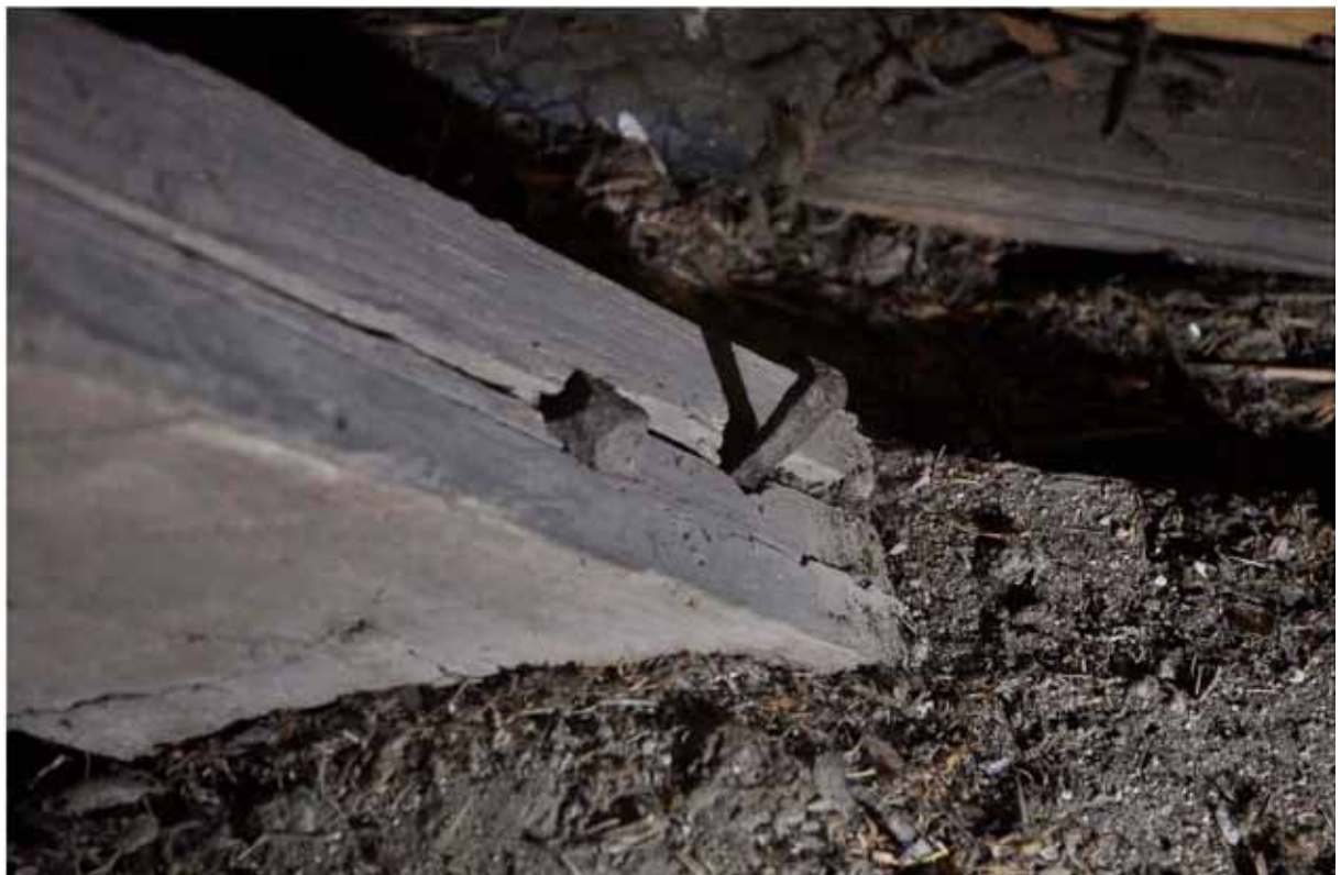
Nedtill står vissa av strävorna i ett tapphål medan andra bara stöter mot och är spikade. Observera att det är två olika typer av spik. Fotografi: Daniel Eriksson
