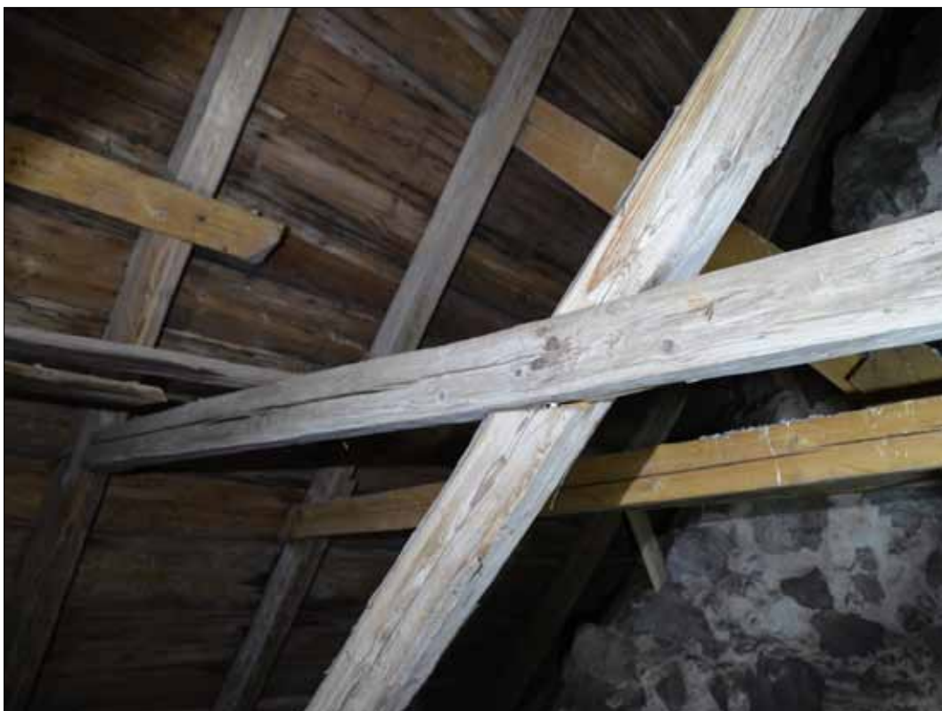
Hela takkonstruktionen har i östra delen vält kraftigt mot öster varför hela konstruktionen i sen tid förstärkts med påspikade reglar och plank (SLM D2015-1393).
