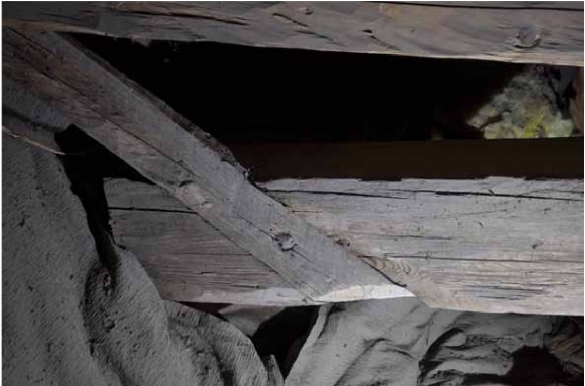
Resterna av ett stödben finns fortfarande kvar. Knuten är en genomgående bladning med spik. Alltså ej husad. Fotografi: Daniel Eriksson
