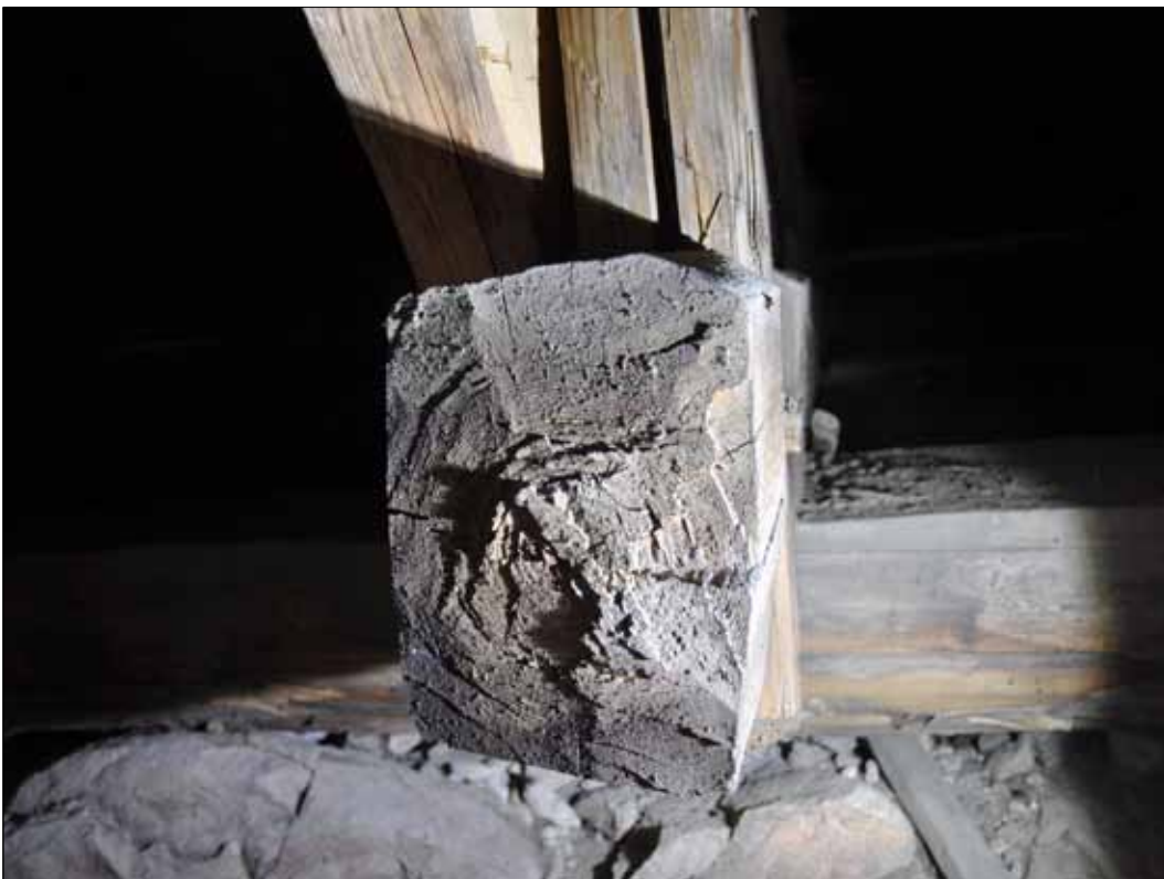
Änden på en tass som kapats med yxa innan montering vilket syns eftersom huggen kommer från alla fyra sidor, även underifrån där man inte kommer ut att hugga i befintligt läge. Tassarna är alltså inte ursprungliga bindbjälkar som kapats (SLM D2015-1513). Foto: Daniel Eriksson
