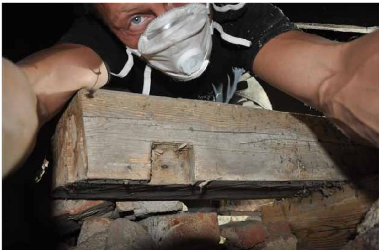
Här en bild på en bortkapad bit av en bindbjälke som ligger lös på vinden. Man kan se urtaget för ovan nämnda tvärbjälke, med ett spikhål. Det finns två bindbjälkar kvar på vinden. Den ena har suttit intill västra muren (bilden ovan), den andra intill östra muren. Detta kan man veta tack vare dessa urtag. Fotografi: Daniel Eriksson
