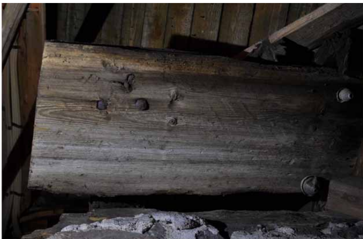
Underifrån ser man att den är fäst med tre spik, alla tre med en sammanhållen placering ganska långt ut i takfoten. Märkligt att det inte sitter någon spik längre in mot muren. Här ser man också att den är spröttäljd. Observera att brädans yttre kant har ett ljusare fält, som om det har varit skyddat av något. Se skiss längre ned. Fotografi: Daniel Eriksson
