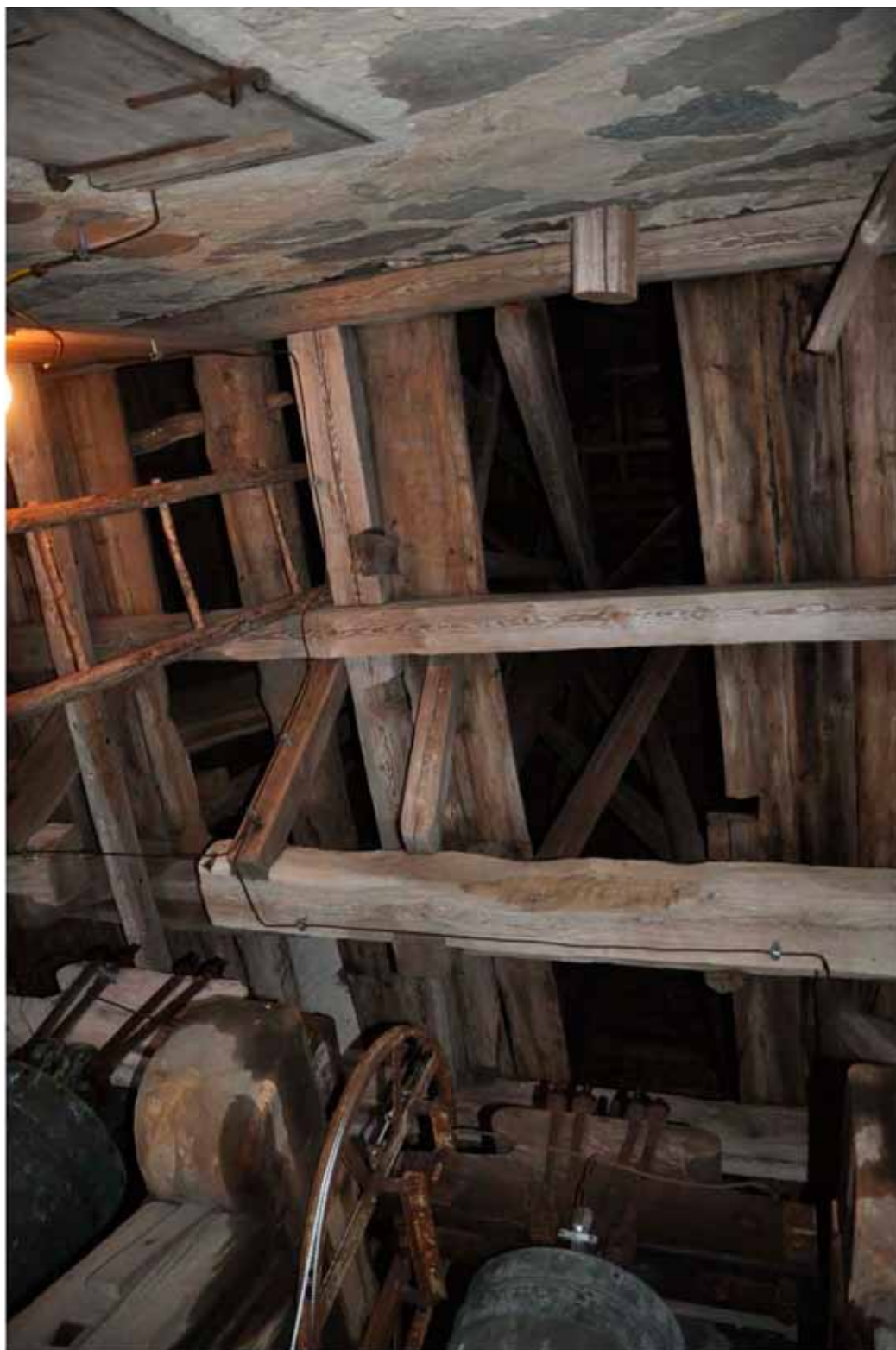
Ovanför de nuvarande klockorna finns det ursprungliga bjälklaget för klockupphängning. Det har från början bestått av fem stycken bjälkar i ek. Fyra av dem har kapats några decimeter utanför murlivet, den femte är fortfarande intakt bortsett från en kort bit som kapats bort för att få plats med den nya klockan. Bara en halvmeter ovan dessa bjälkar finns tornhuvens ursprungliga bjälklag som består av sprätthuggen fura. Detta bjälklag är helt intakt. Fotografi: Daniel Eriksson
