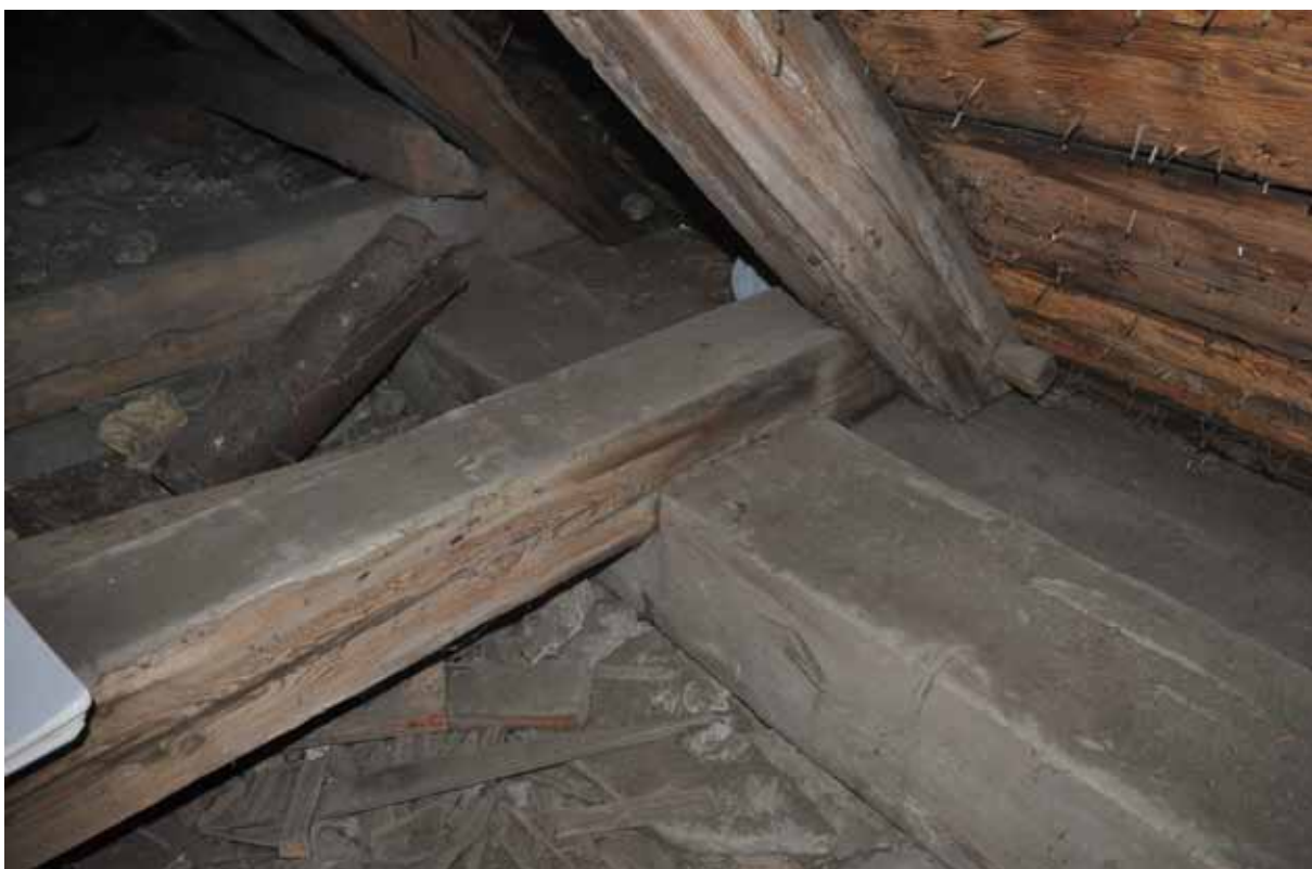
Högbenen/sparrarna varierar mycket i dimension B: 90-150mm H: 105-145mm. Många är huggna kraftigt ur vinkel, i tvärsnittet. De smalnar av från rot till topp och står med toppen uppåt. Knutpunkterna mellan högben/sparrar och bindbjälkar är ej konsekvent utförda. Det är en rak bladning, ibland halvt-i-halvt och ibland med blad endast på högbenet. De har kraftiga dymlingar som ibland är kilade på baksidan. Vissa har två dymlingar. Fotografi: Daniel Eriksson
