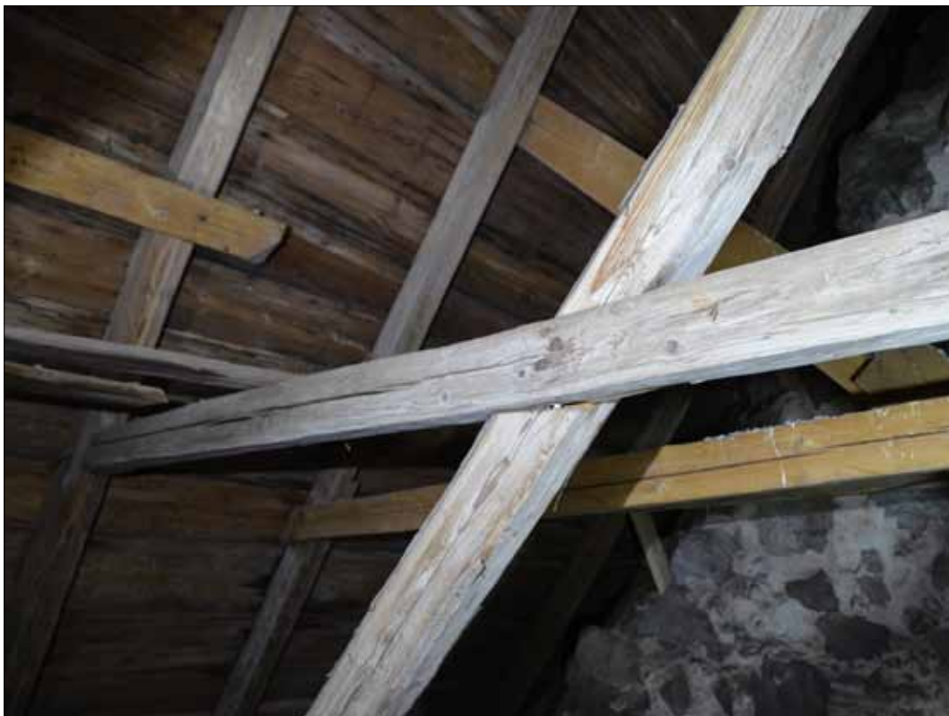
48 Hela takkonstruktionen har i östra delen vält kraftigt mot öster varför hela konstruktionen i sen tid förstärkts med påspikade regler och plank (SLM D2015-1393).
