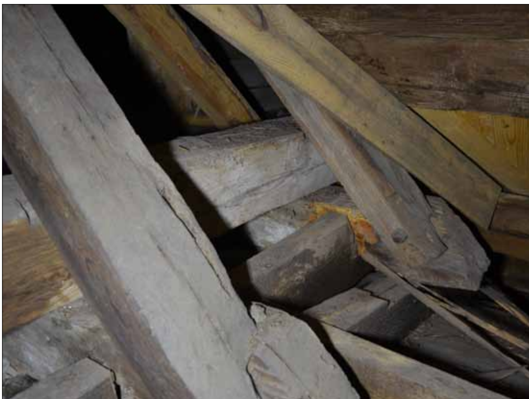
141 Takfoten på norra sidan av långhuset sedd från norra korsarmens vind. Remstycke av ek med hylla och spikskalledympling i mötet högben-bindjälke/tass (SLM D2015-1451).
