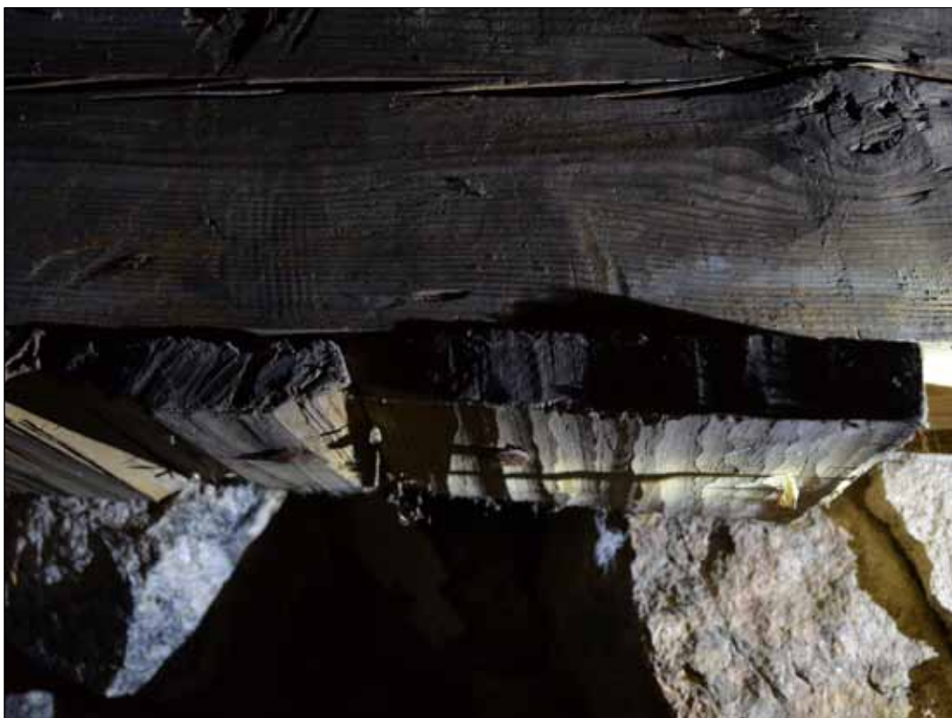
134 På takstolen längst i väster är större delen av bindbjälken kvar och på dess undersida finns det fortfarande kvar små rester av ett äldre platt innertak. Takbrädornas synliga yta är bearbetad med skave (SLM D2015-1447).
