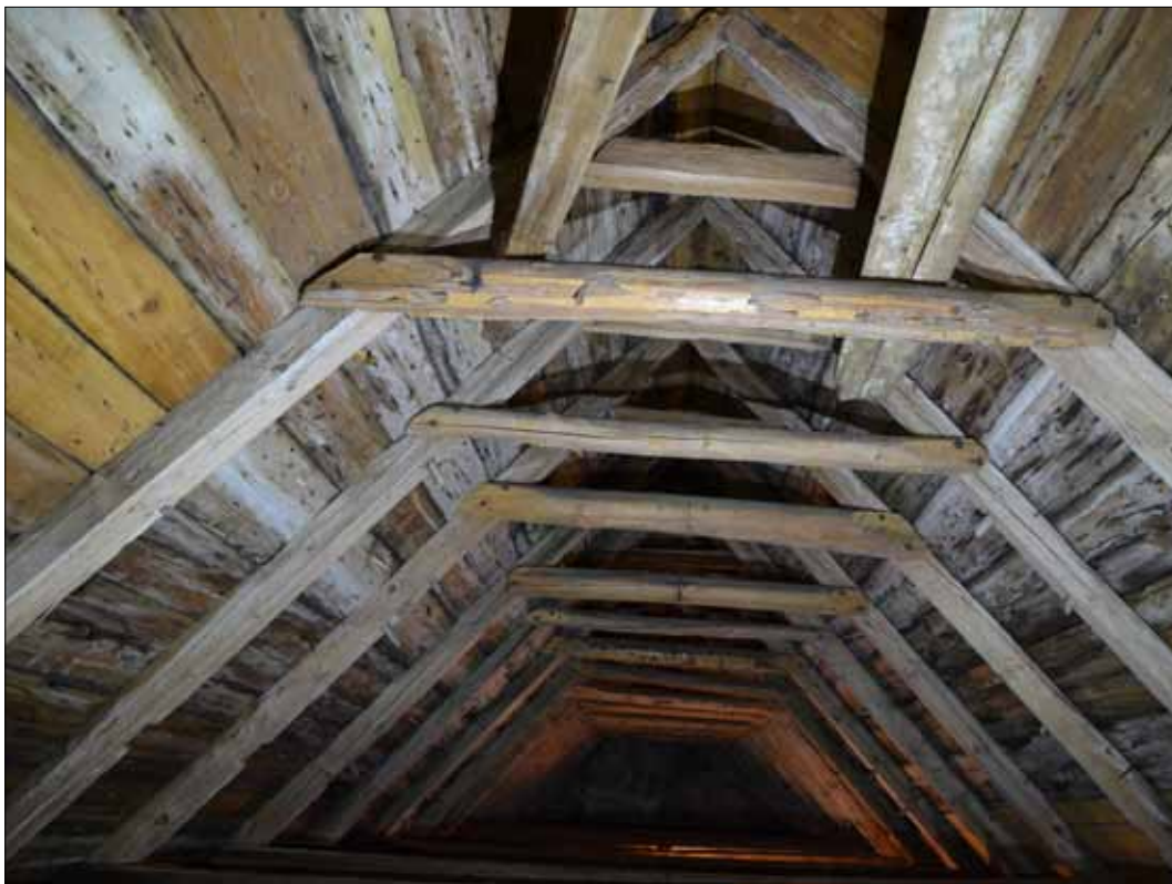
229 Långhusvinden sedd mot öster. Sprätthuggna högben med urtag för stödben och dymlingar för infästning av taktro. Delar av taktron är sprätthuggen och fastdymlad i högbenen (SLM D2015-1505).
