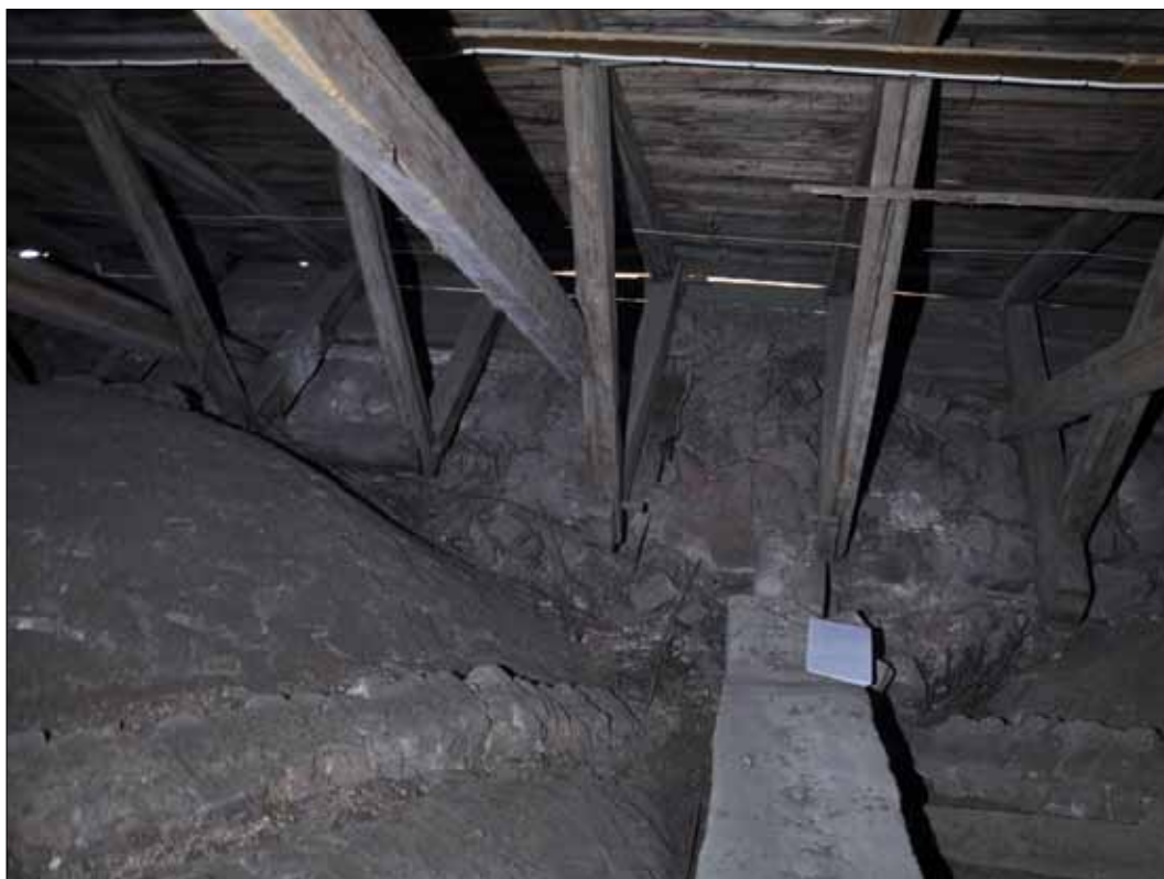
252 I murverket mellan takstol nr 11 och 12 syns tydligt skarven som uppstod då kyrkan förlängdes österut på 1300-talet. Den nyare muren är betydligt tjockare än den äldre. På murkrönen ligger en hel del byggskräp och annat som kan ge mycket information om byggprocesser och andra företeelser. Detta ka lätt försvinna vid städning. (SLM D2015-1523). Foto: Daniel Eriksson.
