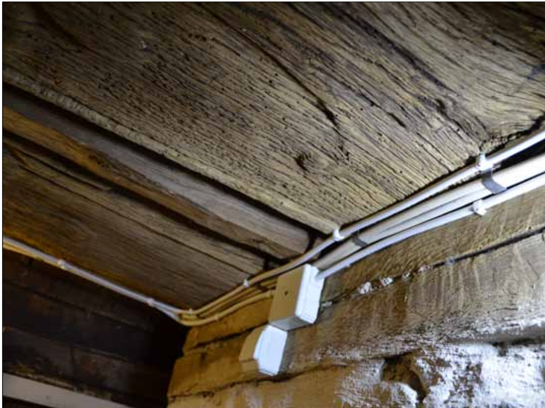
80 Okänsligt dragna elinstallationer. (SLM D2015-1415).
