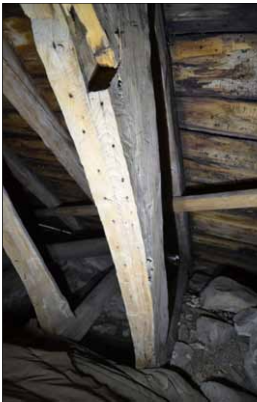
211 Fals med spår av spikning, takstol 18 (SLM D2015-1495).
