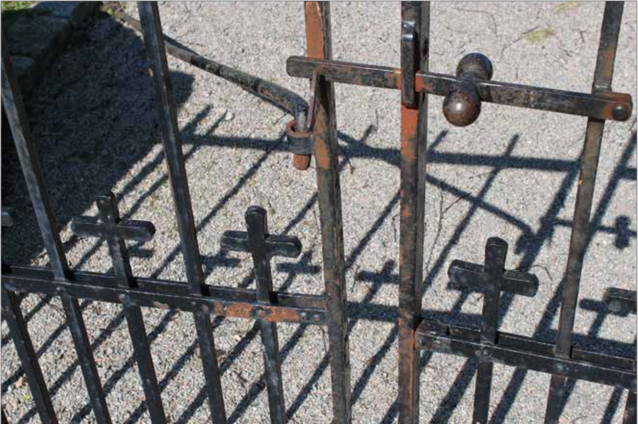
Rostangrepp på dubbelgrinden i den östra muren på den nya kyrkogården. Foto Karin Lundberg.
