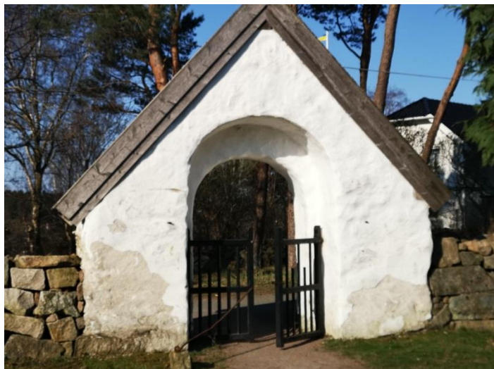
Före omputsningen var omfattande putssläpp.
