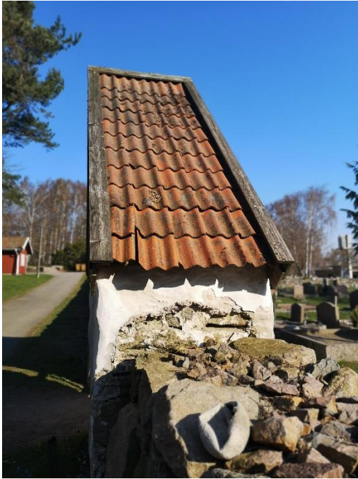
Stigportarnas tak var i behov av omläggning.
