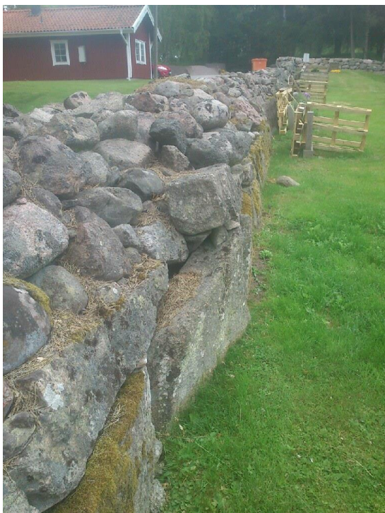
Nordvästra delen av kyrkogårdsmuren före åtgärd.
