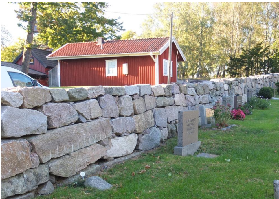
Några stenar bär spår efter klyvning, detta ska åtgärdas under våren 2017.
