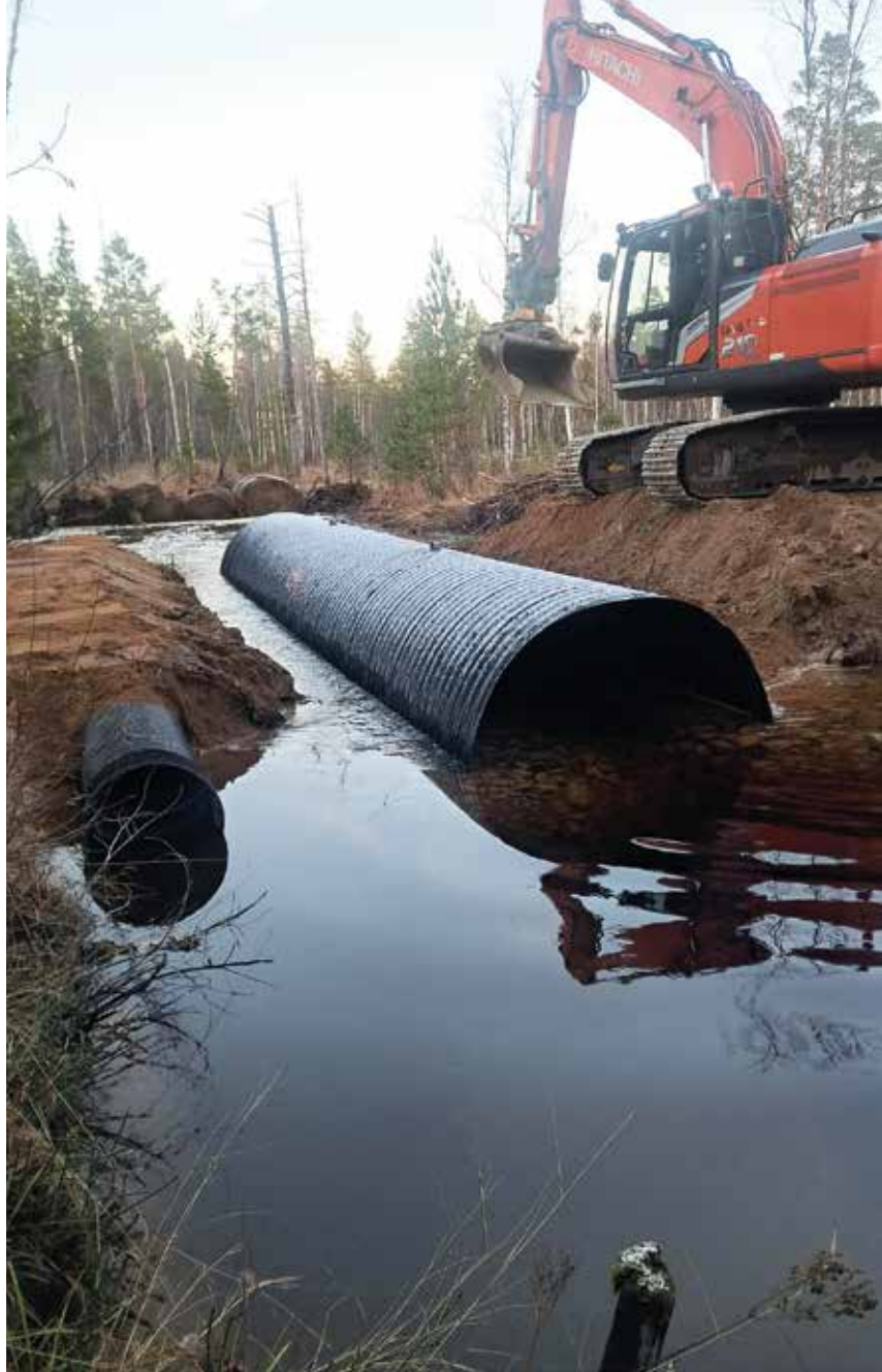
Läggande av valvbåge vid nybyggande av skogsbilväg. Valvbågen är väldigt bra för fisken att kunna vandra i.
