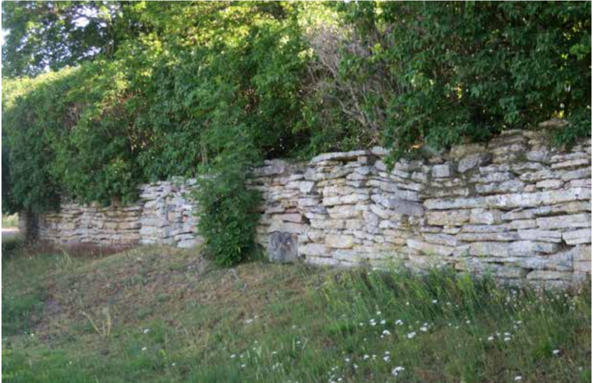
Kyrkogårdsmur av kalksten från 1780-talet. Mycket av fogbruket är bortfallet, men den snart hundraåriga syrenhäcken fungerar som armering av kärnan.
