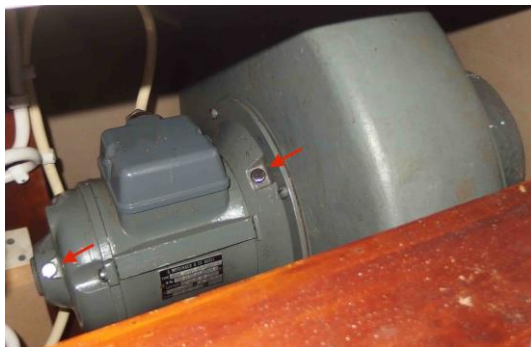
Äldre fläkt med lock vid pilarna som viks upp.
