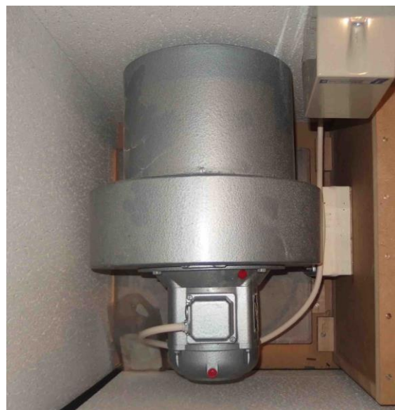
Nyare fläkt med röda plastproppar som tas bort.
