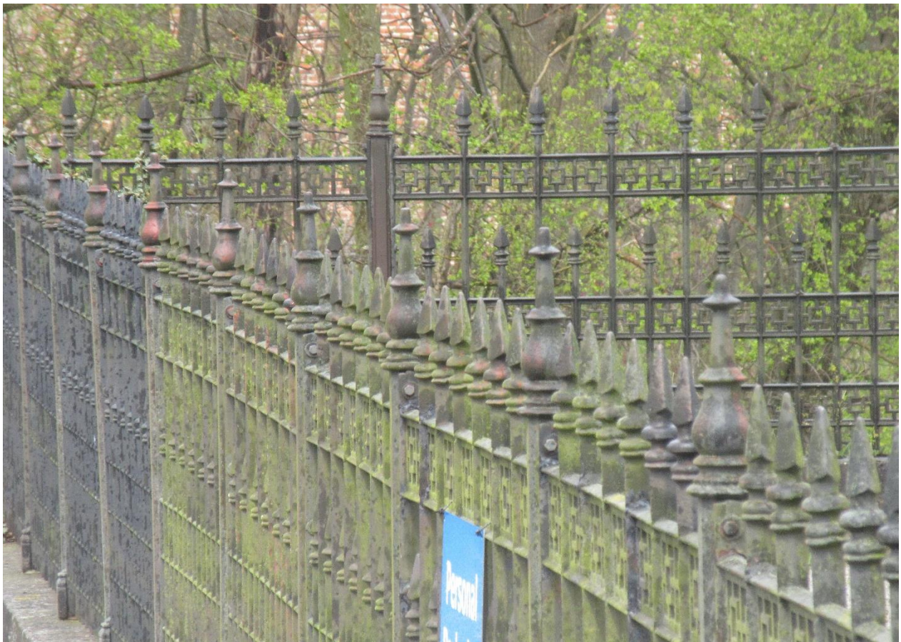
Det gamla järnräcket av målat gjutjärn har stort kulturhistoriskt värde och är i behov av ommålning.
