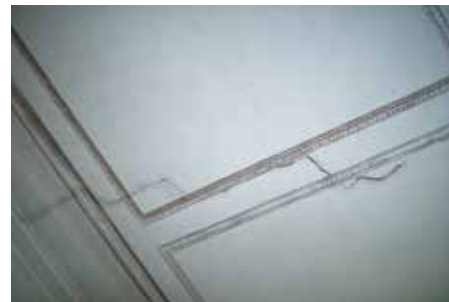
Ett beslut att stänga Fellingsbro kyrka har tagits på grund av sprickor i innertaket.
