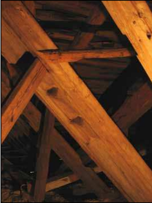
Takstol nr 13 har ursprungligen infattat långhusets gavelröste. Mitt på högbenen är dekorativa utsparningar.
