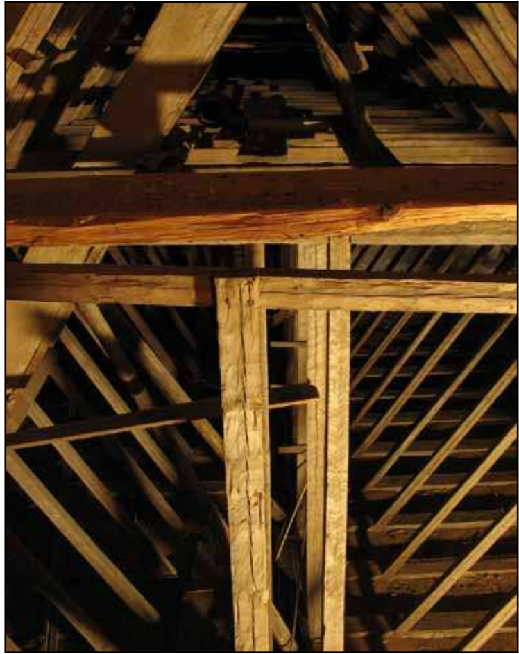
Långhusets taklag sett ovanifrån. Lägg märke till hur mittstolparna skiftar sida om styrbjälken, ett drag som även finns i Drevs gamla kyrka.
