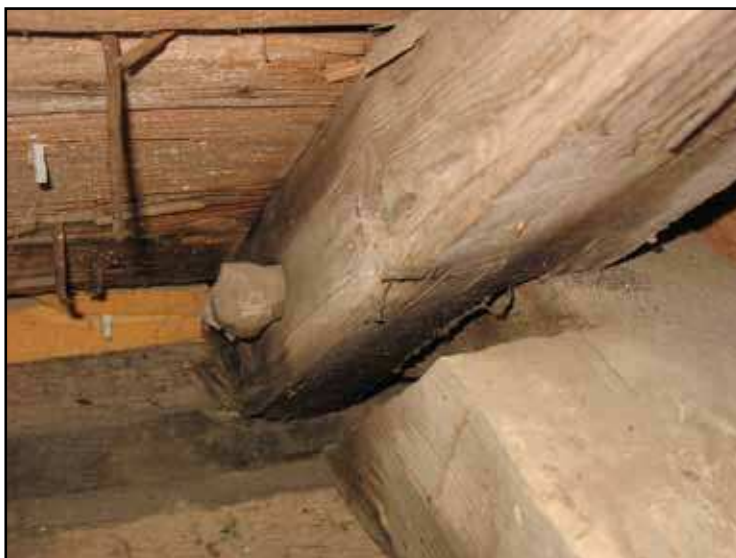
Den enda intakta ursprungliga sammanfogningen mellan högben och bindbjälke på nordsidan, med fint arbetad dymling.
