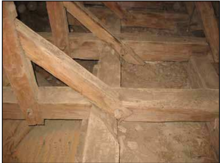
Sammanfogning mellan remstycken, tassar, sparrar och stödben. Notera urhuggningen i remstycket för infästningen av sparrarna. Kan detta vara ett tecken på att remstyckena är äldre?
