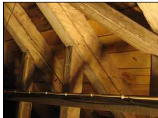
Vanlig lösning av kabeldragning på kyrkovindar.
