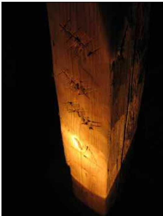
Korrigerad timmermärkning på norra stödbenet på takstol nr. 13.
