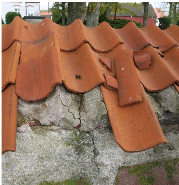
På ett par ställen har avtäckning av tegelpannor på den gamla muren spruckit och lossnat.
