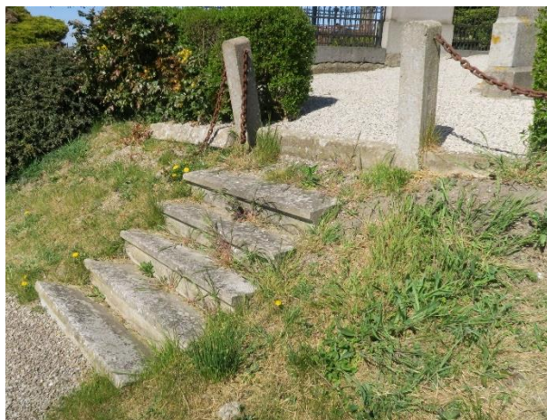
En av stentrapporna i sydväst med sättningar i stegen. Ovanför trappan rostiga och hängande kedjor.
