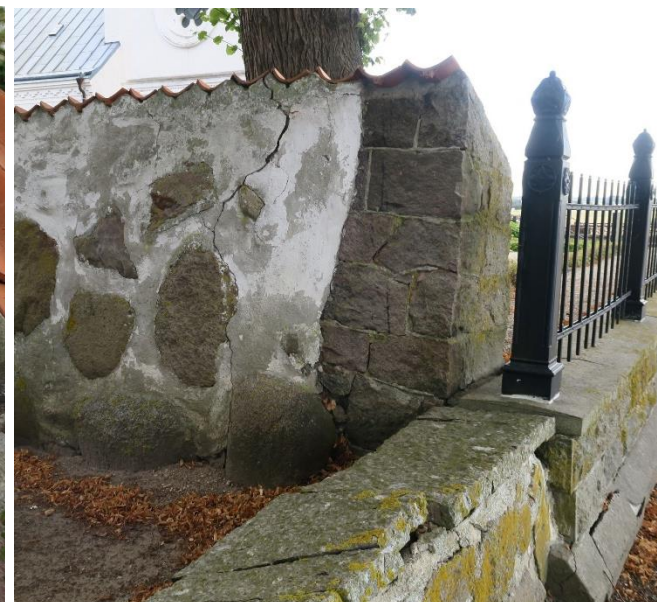
Här möts tre murar av olika ålder och med olika behov av åtgärder mot sprickor i muren, i avtäckningen och i betongdelar.
