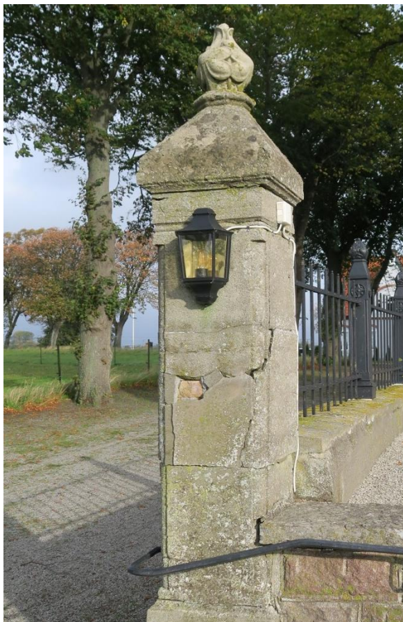
Pelare vid trappan till kyrkan med sprickor i ytskiktet.
