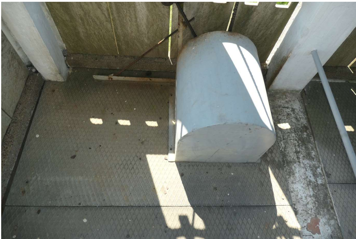
Figur 34 Motorn till klockorna är övertäckta med en plåthuv. Denna har varit fastskruvad men var vid besiktningstillfället löst placerad på motorn.
