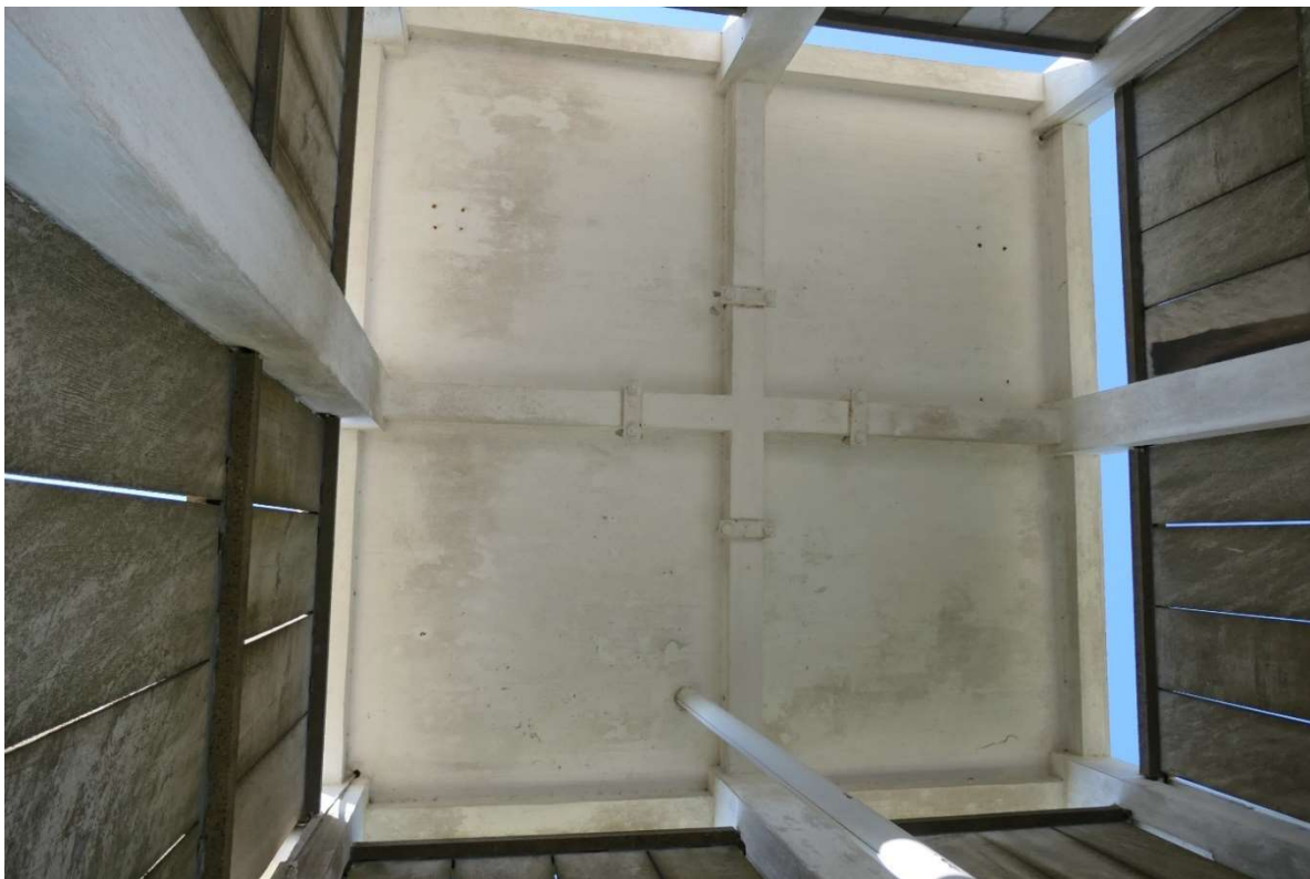
Figur 36 Det övre takbjälklaget sett underifrån. Takbjälklaget består av en gjuten platta med omgivande balkram och två korsande balkar i mitten är fogade till stolparna i sidorna. Järnen vid mitten utgör sannolikt infästning för krönbors. Svaga rostiga märken syns på några ställen i bjälklagets undersida. Dessa här okänd funktion. Ett stuprör avvattnar taket. Nederst till vänster och överst till höger syns åskledare.
