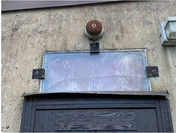
Figur 70 Ovan dörren till offentlig wc finns ett ljusinsläpp med likadana fönsterklamrar som på 1969 års byggnad. Ovan fönstret en larmanordning, kopplad till toaletten. Västra fasaden.
