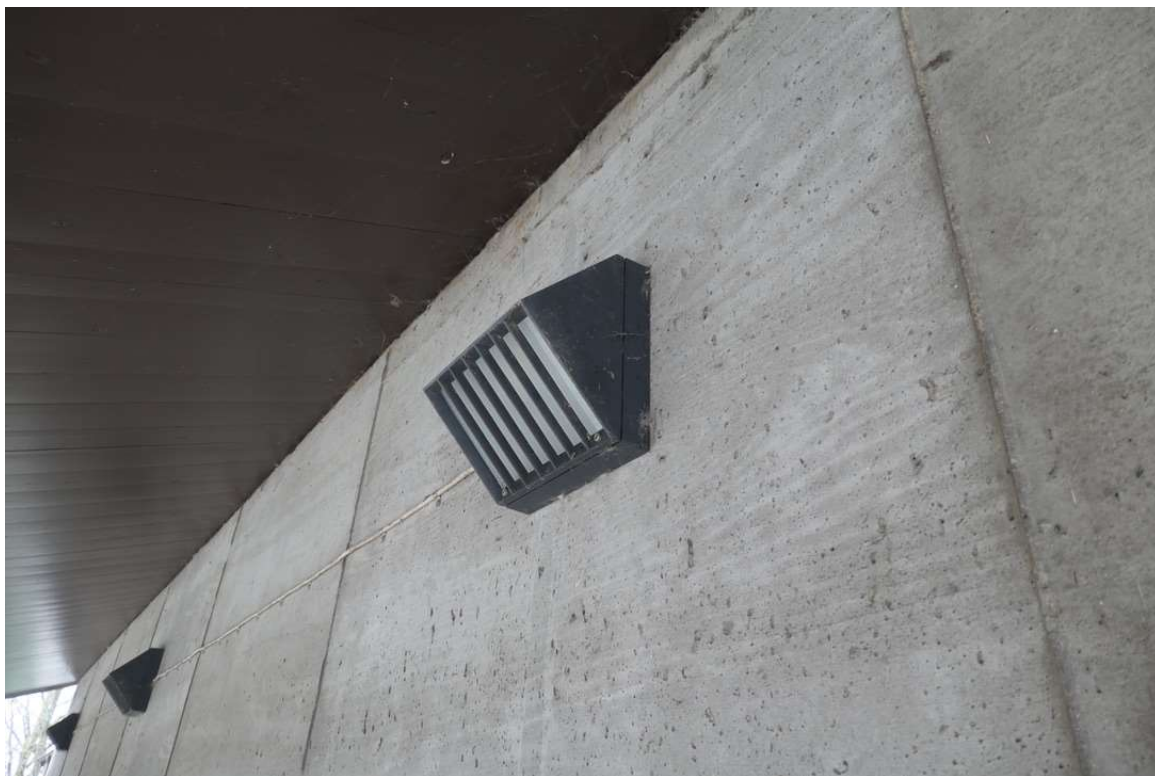
Figur 24 Senare tillkommen utomhusbelysning, monterad på södra och norra fasaderna.
