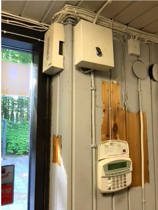
Figur 79 Eldon/larm vid ytterdörren åt söder.
