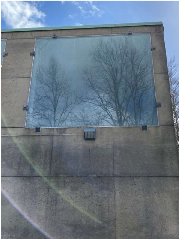
Figur 14 Ett av fönstren på norra fasaden.
