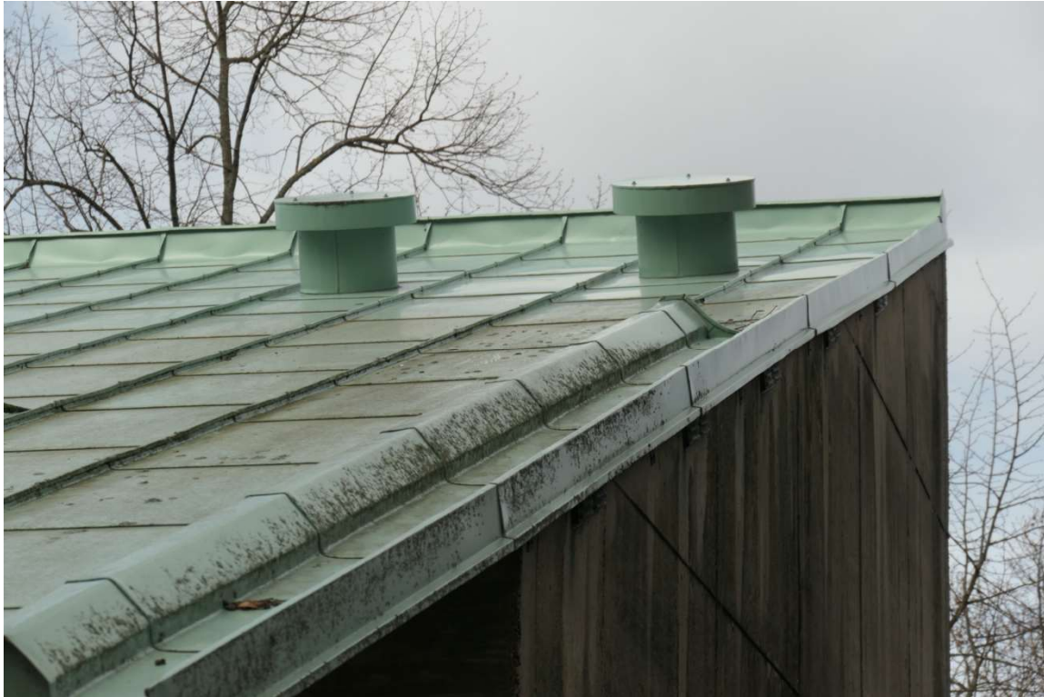
Figur 20 Detalj av ventilationshuvorna.
