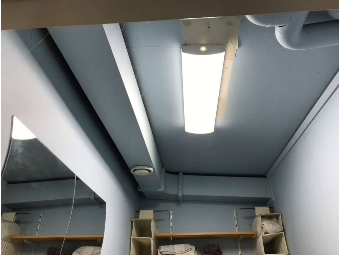
Figur 103 Ventilationstrumma, från hallen vidare till kontoret. Från kontoret till offentligt wc på västra fasaden.
