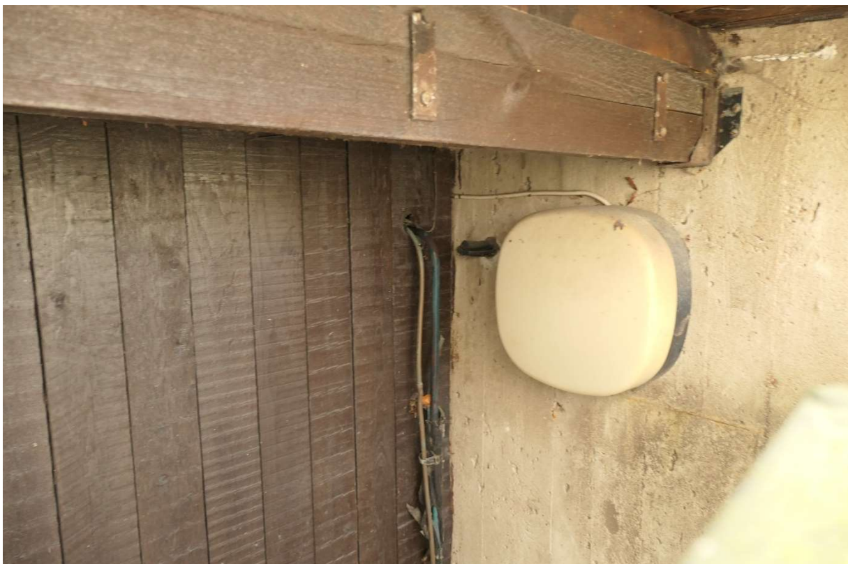
Figur 74 Utomhusbelysning och kabeldragning. Norra nischen.
