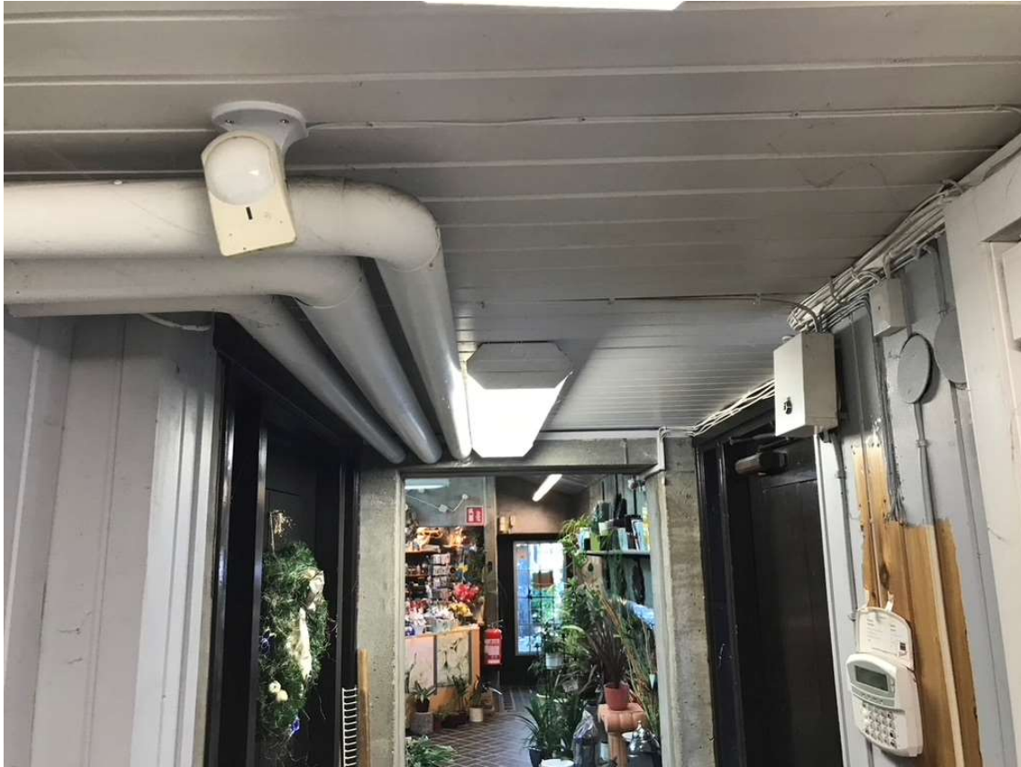
Figur 91 Vattenledningar som går längs med taket, från 1969 års byggnad in till 1979 års tillbyggnad.
