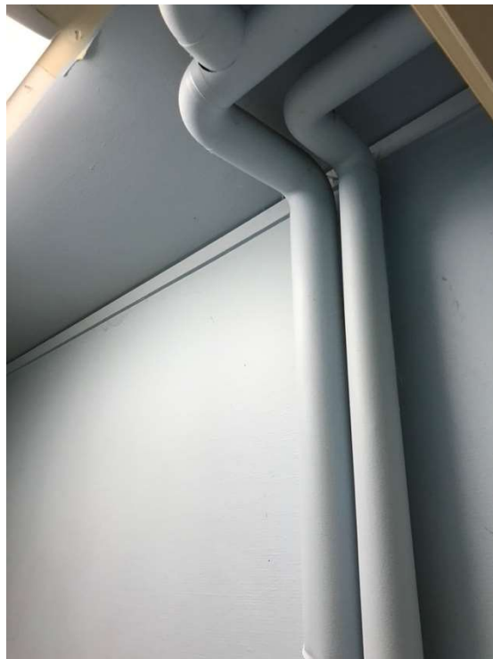
Figur 102 Vattenledningar, från hallen.
