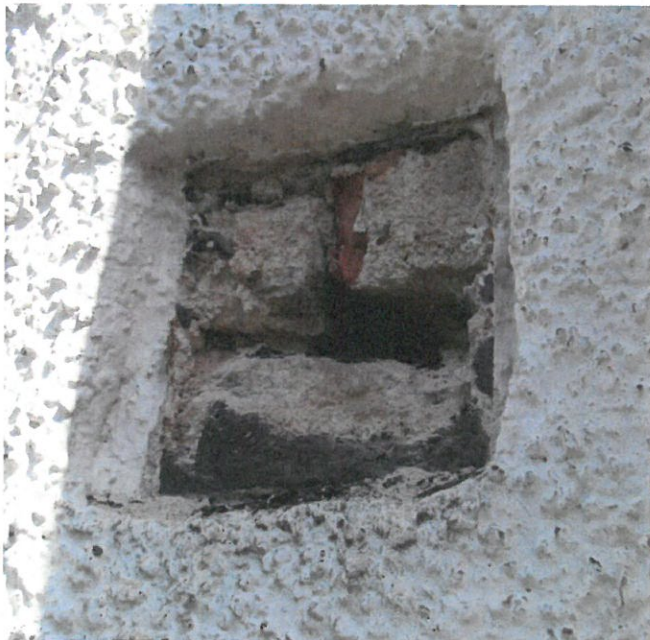
Bild 8. Infästningspunkt nr 2 i fasad för lossnat ankarjärn.
