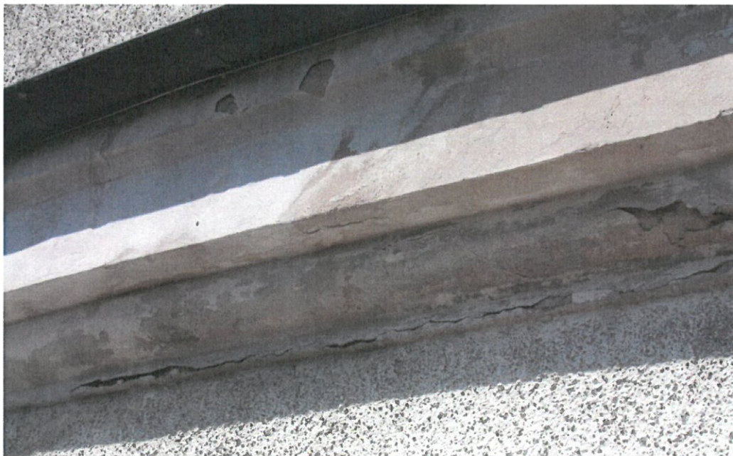
Bild 17. Sprickor i fasad mot söder.
