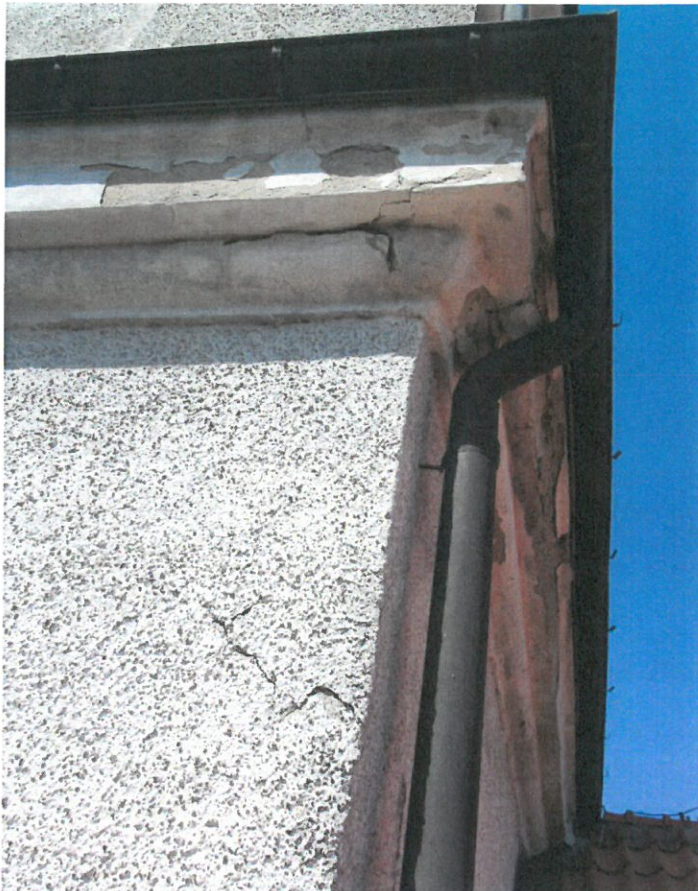
Bild 18. Sprickor i fasad, hörn mot sydöst.
