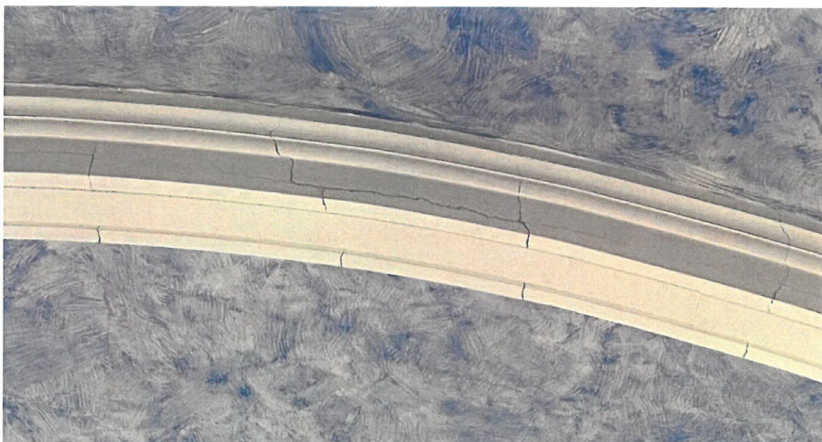
Bild 21. Sprickor i putsade takbalkar.
