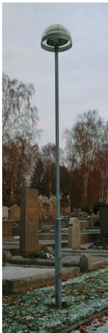
Planen ovan visar befintlig belysning och bilden visar befintlig stolpe och armatur.
