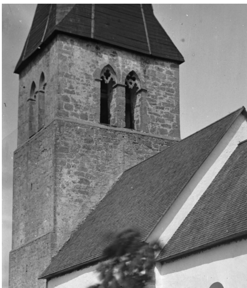
Detalj av föregående foto, visande avtryck av långhusets tidigare takresning, samt att långhus- och kortaken då var täckta av spån. Tornpanelen är ojämn och har glipor.
