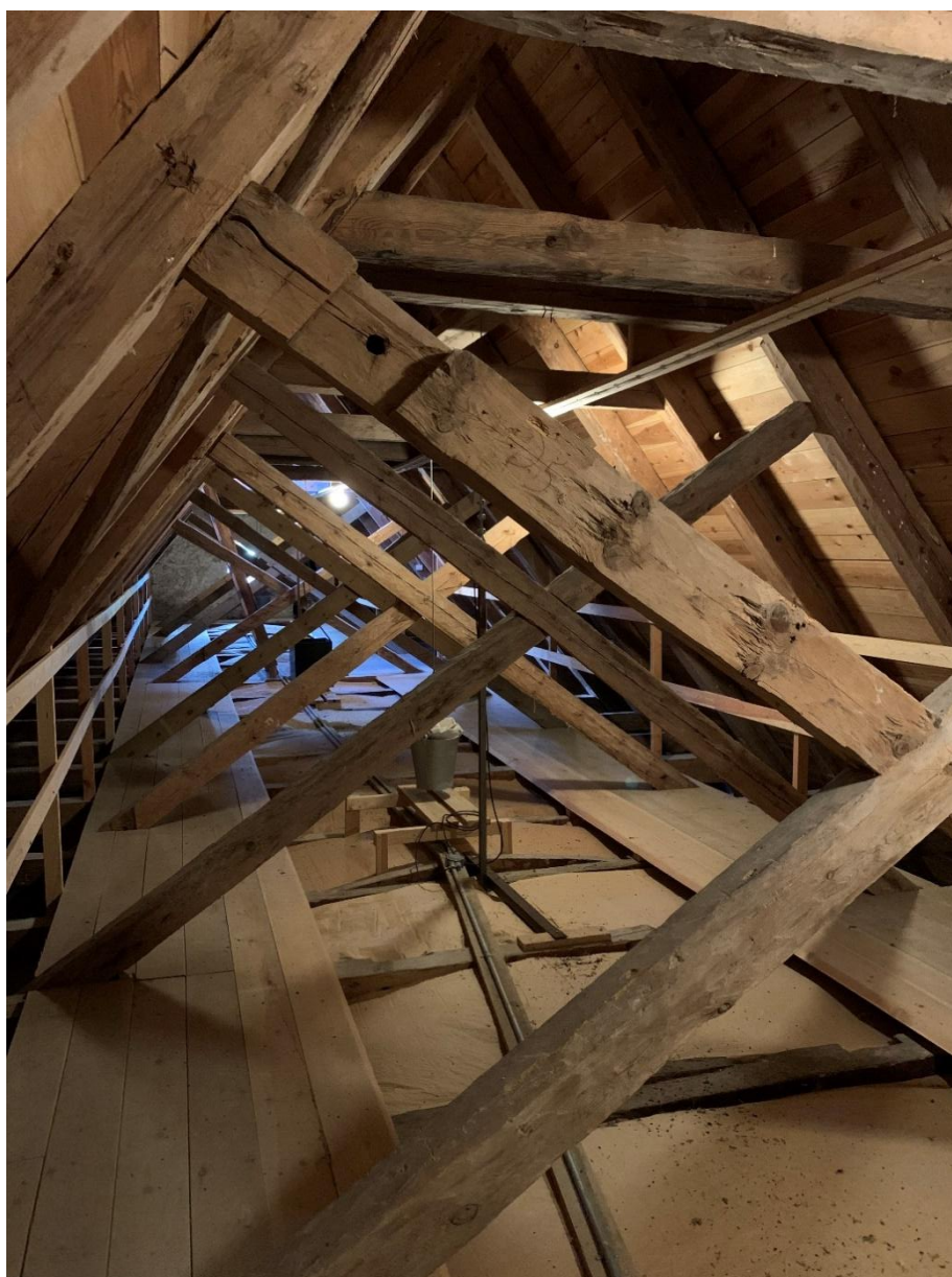
Ovan till vänster, södra delen av röstet ovanför det medeltida långhusets västgavel, visande vittrande skador efter brand. Ovan till höger, östra tornmuren med öppningens välvda båge sedda nedifrån mot väster. Till vänster kyrkvinden sedd mot öster. Foto JL 2022.
