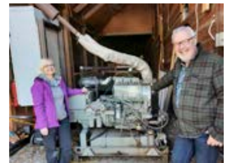
Helén och Mats vid det stora elverket, som i händelse av kris kan försörja Åvestbogården med el. Elverket provkördes under julmarknaden då man behövde ström till belysning och kokplattor.
