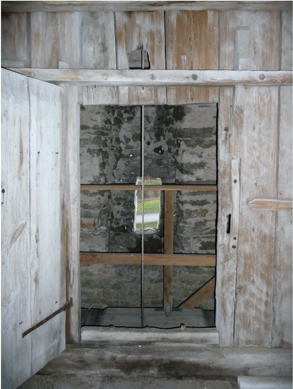
Tornets andra övervåning. Dörr från magasinet, vänd mot glugg i tornets södra mur med nisch som talar för att öppningen varit större och alltså fungerat som lastport. Foto ES 2019.
