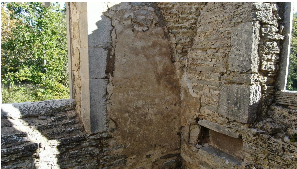
Korets sydöstra hörn. Skillnaden i fönsteromfattningarnas utförande har tolkats som att de är från olika tid, men triumfbågen har snarlik omfattning som det östra fönstret till vänster och skillnaden kan bero på annan värdighet. Foto Pär Malmros 2020. Visby stift.
