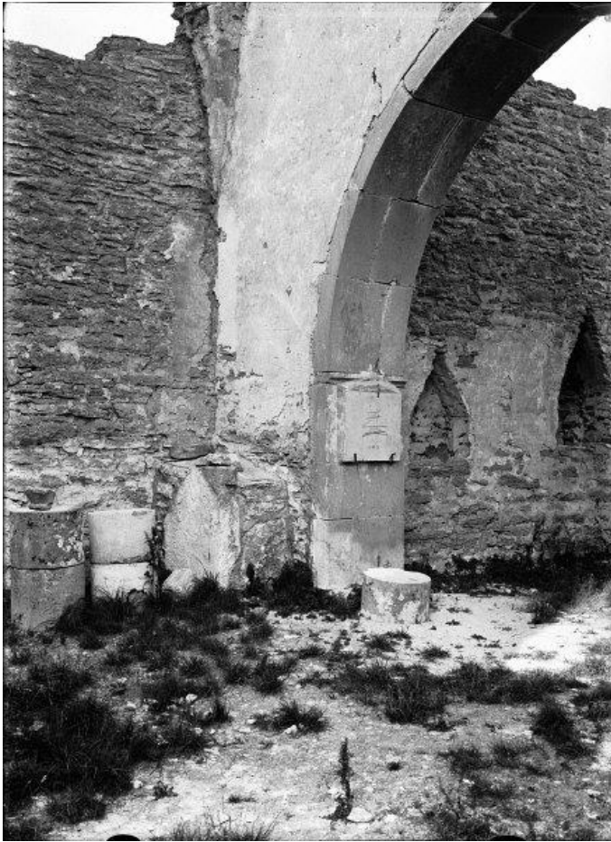
Långhusets nordöstra hörn med triumfbågens norra del efter konserveringen 1923. Ljusare partier nedtill på muren visar utsträckningen av borttagna rasmassor. Minnesstenen från kungaparets besök nyligen uppsatt. Observera den bevarade putsen på korets norra mur. Foto Alfred Edle 1925 i ATA. RAÄ, Kulturmiljöbild.
