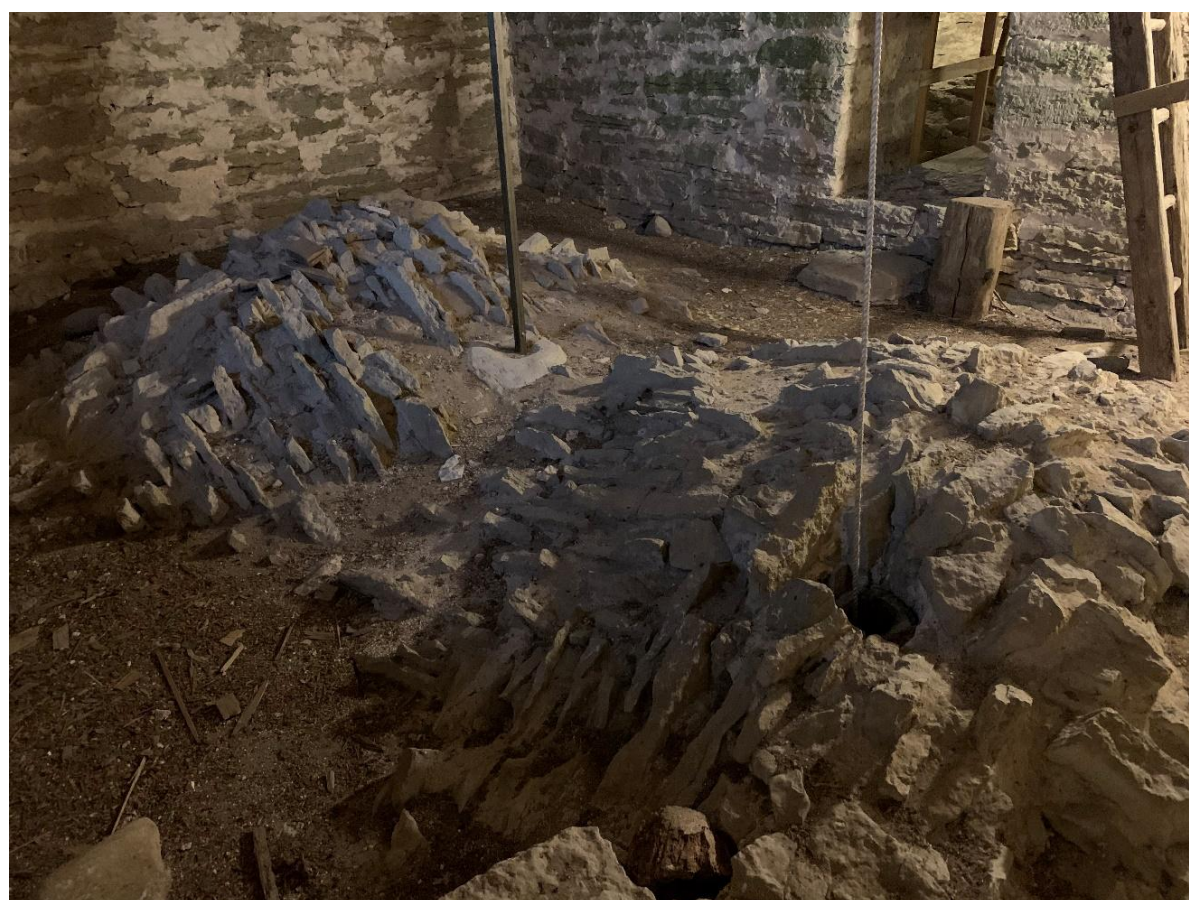
Valvens ovansida i tornets första övervåning, sett mot nordöst. Foto JL 2020.
