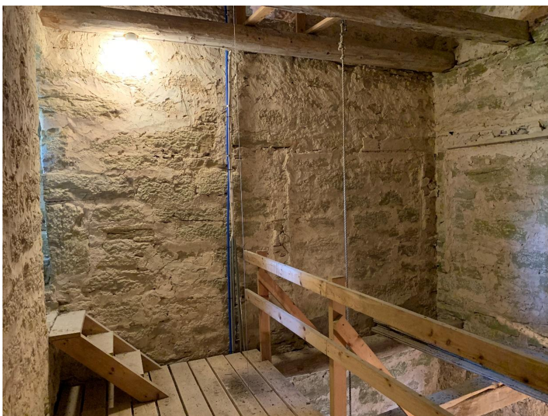
Tornets andra övervåning mot söder och norr. Avtryck finns på murarna av träkonstruktionen till ett tidigare magasinrum (?) längs med östra sidan. Att mindre murbruk ingår i murverket på södra sidan kan bero på att muren fuktskadades av den bortfallna puts som syns på foton före restaureringen 1957. Trägolvet förbinder murtrapporna. Foto JL 2021.
