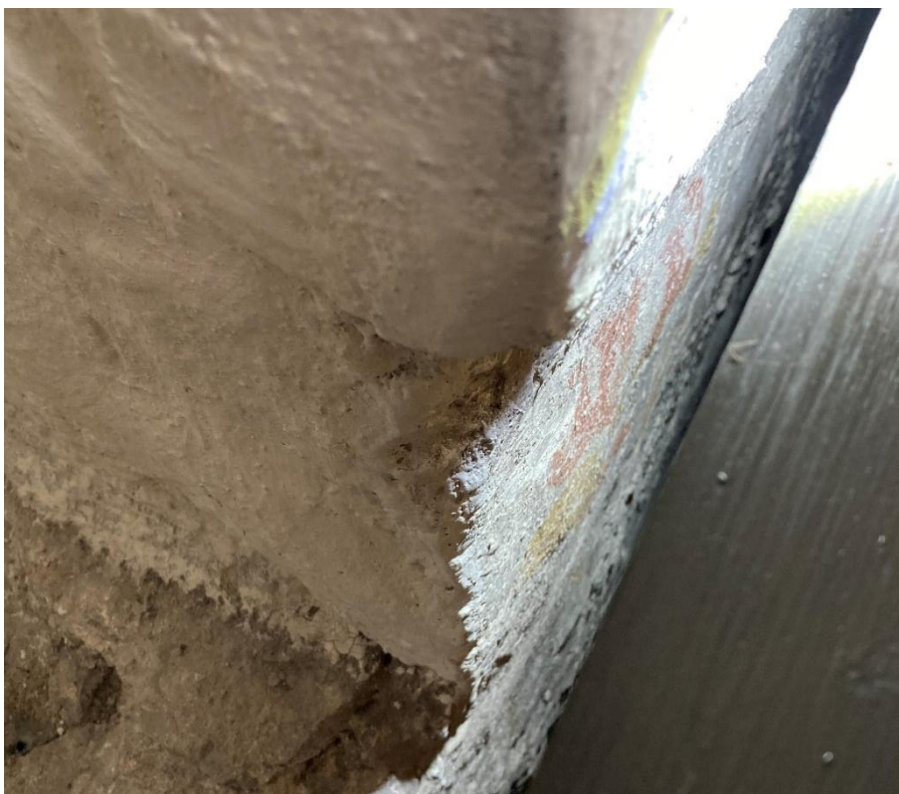
Spår av målningsdekor på norra långhusmuren, dold av bänkskärm. Troligen från en rankdekor av tidig 1700-talstyp. Foto JL 2023.
