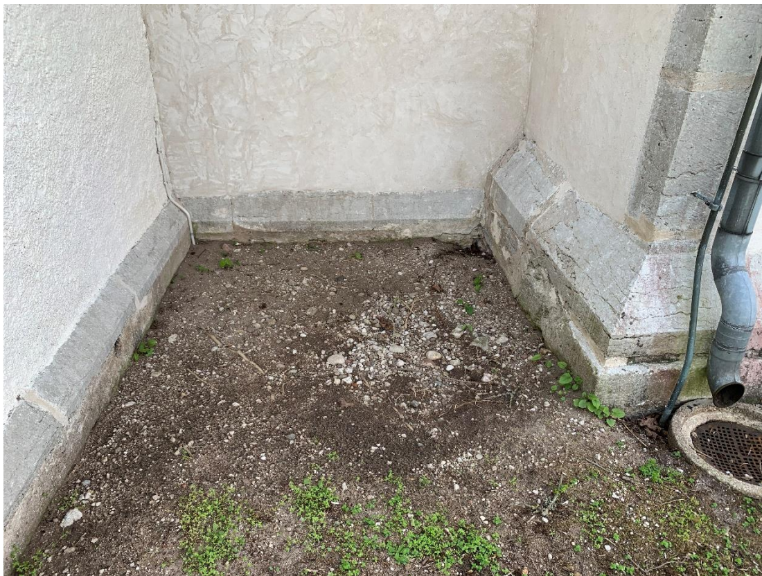
Hörnet mellan sakristian till vänster med sockel troligen från 1900-02, koret med sockel överförd från den äldre kyrkan samt till höger långhuset med sockel från byggnadstiden. Foto JL 2022.
