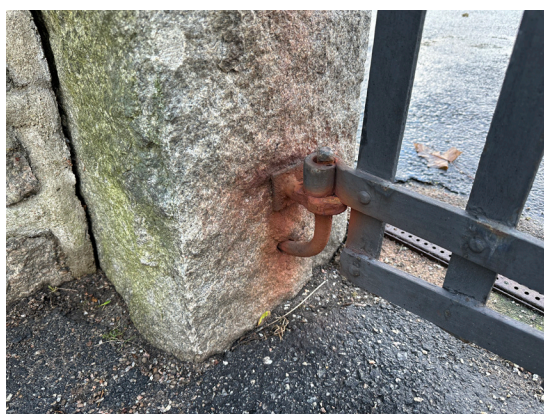
Rostangrepp på järngrind vid ingång i anslutning till parkeringsplatsen vid kyrkogårdsutvidgningen i nordöst.
