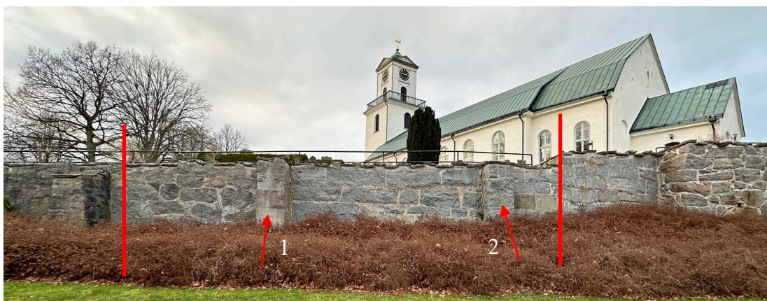
Den höga muren på östsidan av den äldsta kyrkogården söder om kyrkan är i behov av partiell reparation. Mursträckan mellan de röda strecken buktar svagt utåt och de två strävpelarna (pilar) har lossnat från muren, detaljbilder på nästa sida.
