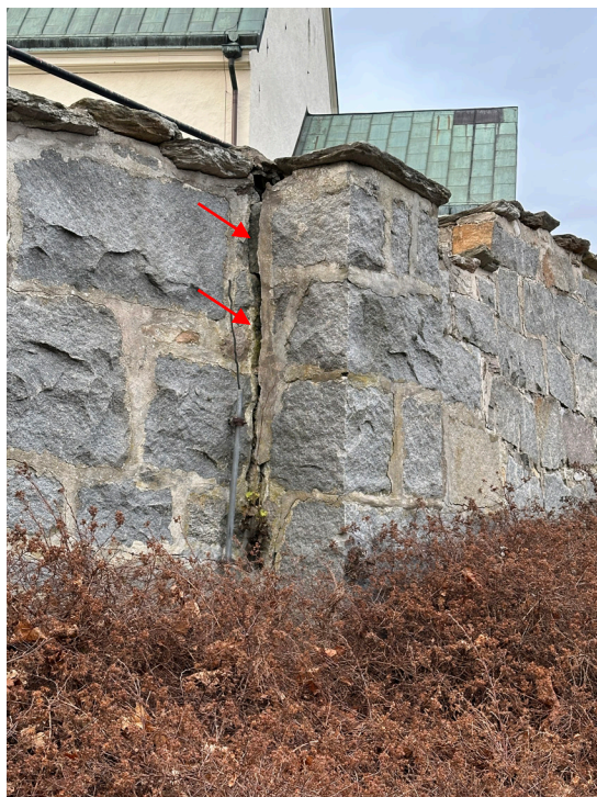
Spricka mellan mur och strävpelare 2 (se foto på föregående sida).
