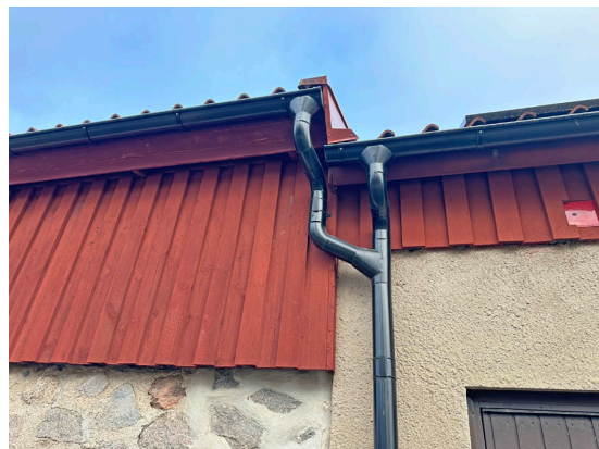
Misspdydande stuprör med moderna, pressade "böjar" på ekonomibyggnaden väster om kyrkan.
