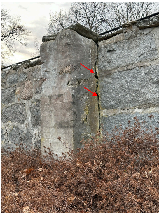
Spricka mellan mur och strävpelare 1 (se foto på föregående sida).
