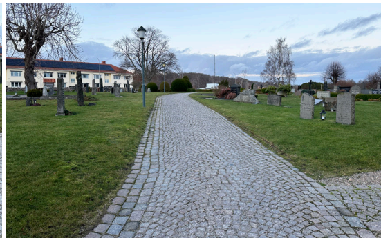
Bristfällig gatstensläggning med ojämnheter och alltför ”kupig/välvd” yta.
