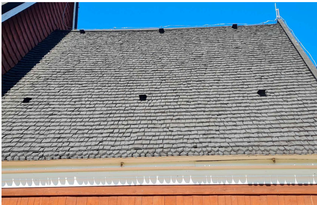
Figur 62 Automatiska sprinkler på yttertak och under takfot på en kyrka. Sprinklerna är anslutna till ett rörsystem på kyrkvinden. Foto: Tomas Godby, Brandskyddsbesiktning T Godby AB.
