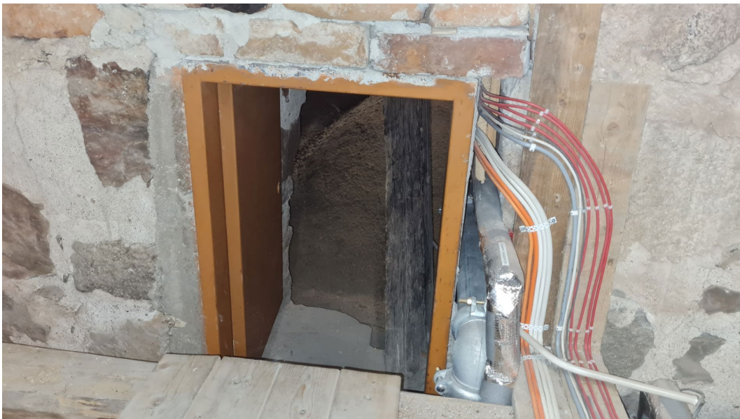
Figur 99 Förläggning av samplingsrör och sprinklerrör vid sidan av karmen till en mindre branddörr utan efterföljande brandtätning. Detta försämrar det passiva brandskyddet. Foto: Tomas Godby, Brandskyddsbesiktning T Godby AB.
