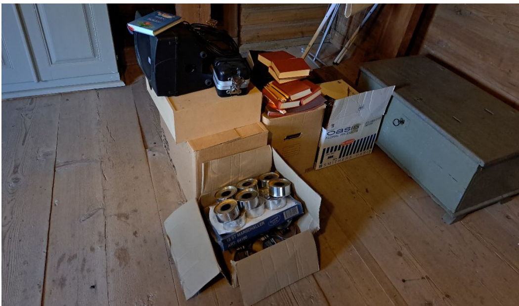
Figur 79 Lagring av brännbart material i en 1600-talskyrka som ökar sannolikheten för uppkomst av brand, intensifierar brandförloppet och försämrar möjligheten för sprinklersystemet att kontrollera branden. Utrymmet är tillgängligt för besökare. Foto: Magnus Arvidson, RISE.
