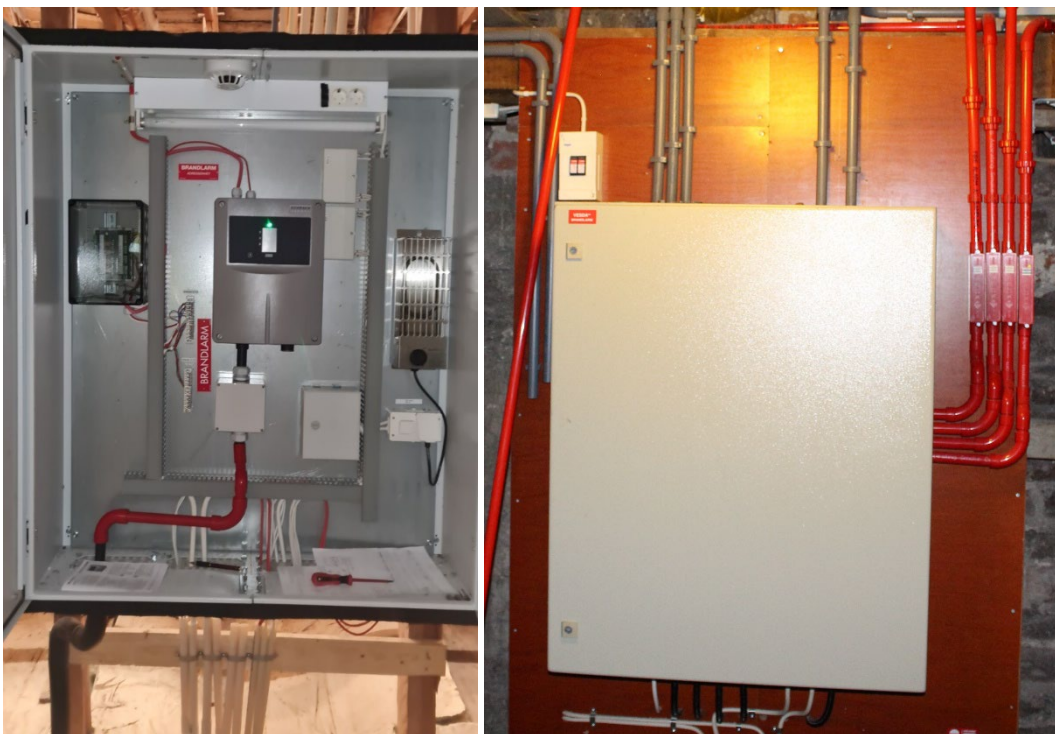
Figur 84 Skåp för detektorenhet och fläkt för aspirerande system installerat på två större kyrkvindar. Här kan noteras att skåpet till vänster har en punktdetektor för detektion av brand i själva skåpet. Foto: Tomas Godby, Brandskyddsbesiktning T Godby AB och Magnus Arvidson, RISE.
