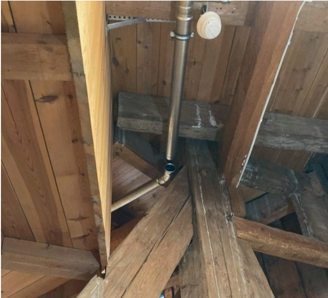
Figur 42 Presskoppling som gick isär vid en provtryckning av ett sprinklersystem utfört av rostfritt stål installerat i en kulturhistoriskt värdefull byggnad. Foto: Anders Lusth, Byggconstruct.
