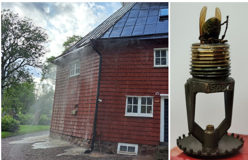
Figur 61 Vattenbegjutning av fasad på en kyrka från en sektion med öppna sprinkler. Igensättning av ett öppet sprinklarmunstycke från samma anläggning där en geting krupit in genom munstyckets utloppsöppning. Igensättningen uppmärksammades när systemet provades vid en revisionsbesiktning och inget vatten distribuerades från munstycket. Foto: Magnus Arvidson, RISE och Tomas Godby, Brandskyddsbesiktning T Godby AB.
