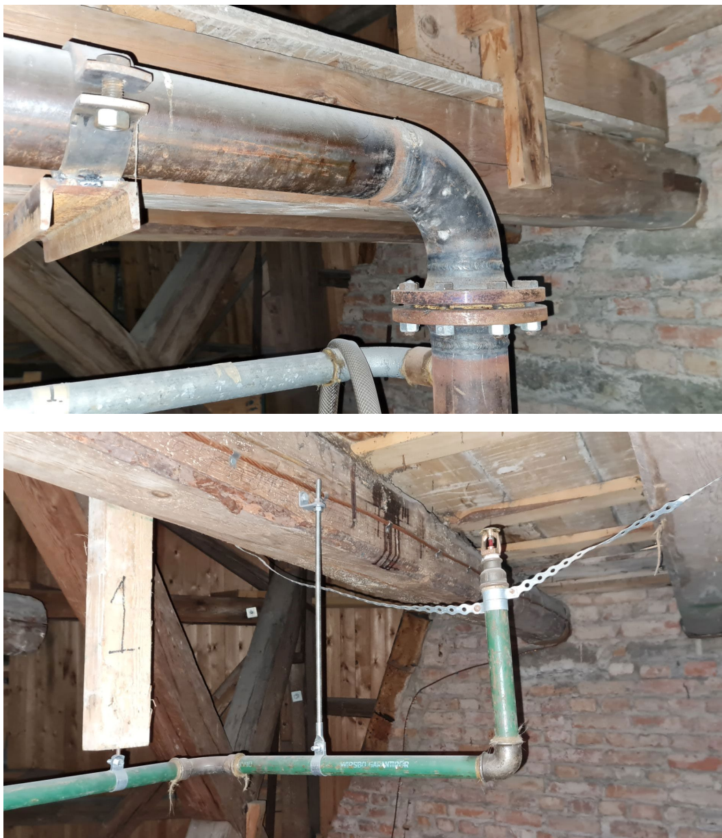
Figur 37 Ett torrörssystem installerat i ett kyrktorn år 1965 där svarta stålrör använts (övre fotot). Rören har kraftigt fall som förhindrar kvarstående vatten vilket medfört att det inte varit problem med invändig korrosion. Röret är sammanfogat med flänsförband. Här kan också den kraftiga smidesinfästningen noteras. Det nedre fotot visar så kallade gröna gängade handelsrör på samma torrörssystem sammanfogade med aducerade (gjutna) rördelar. Foto: Tomas Godby, Brandskyddsbesiktning T Godby AB.
