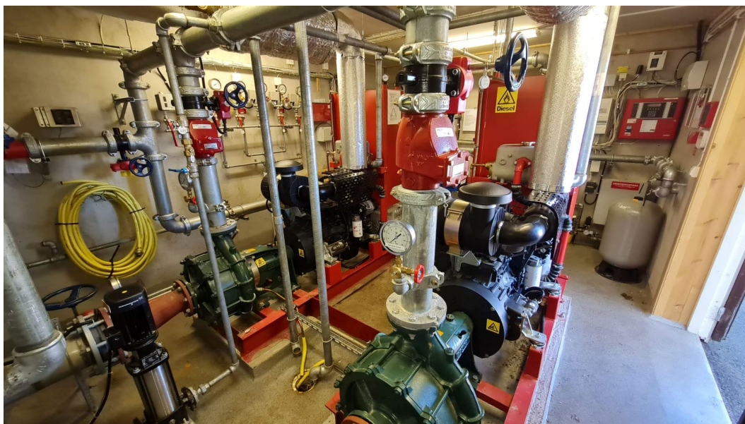
Figur 15 Två dieselmotordrivna pumpaggregat placerade i teknikbyggnaden för en mindre kyrka. Foto: Tomas Godby, Brandskyddsbesiktning T Godby AB.
