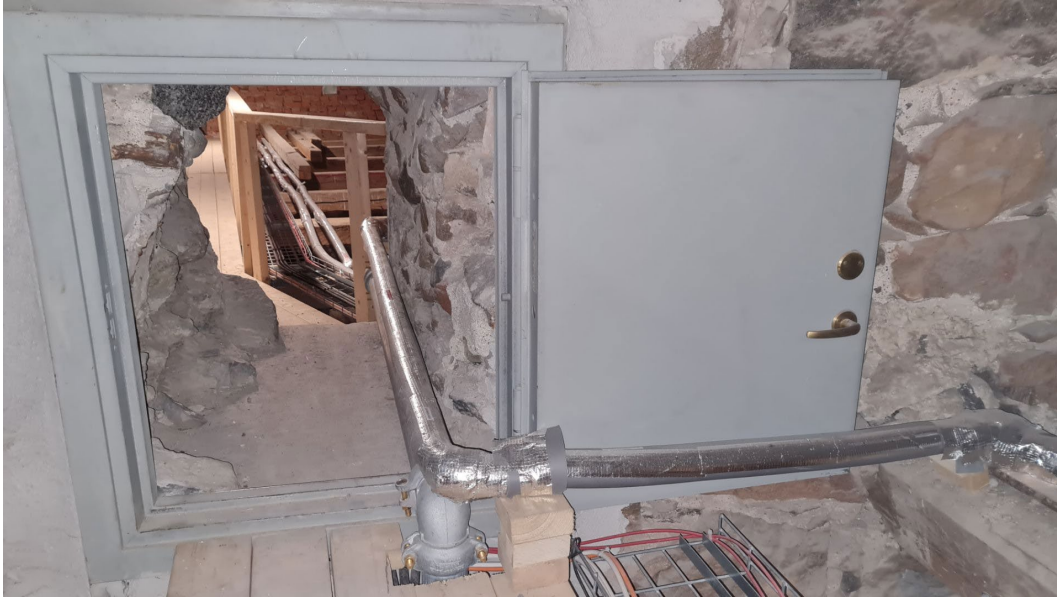
Figur 98 Förläggning av samplingsrör och sprinklerrör genom en mindre branddörr så att den inte går att stänga. Detta försämrar det passiva brandskyddet. Foto: Tomas Godby, Brandskyddsbesiktning T Godby AB.
