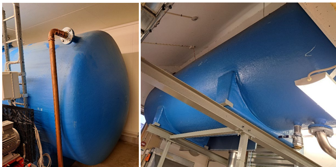
Figur 10 Liggande cylindriska vattentankar med automatisk påfyllning i två olika kyrkor. Den till vänster är placerad på golvet i teknikbyggnaden och rymmer 15 m 3 vatten. Den till höger rymmer 5 m 3 vatten och är placerad på ett stativ i teknikbyggnaden som ger ett positivt inloppstryck till sprinklersystemets pumpenhet som är placerad på golvnivå. Foto: Magnus Arvidson, RISE.
