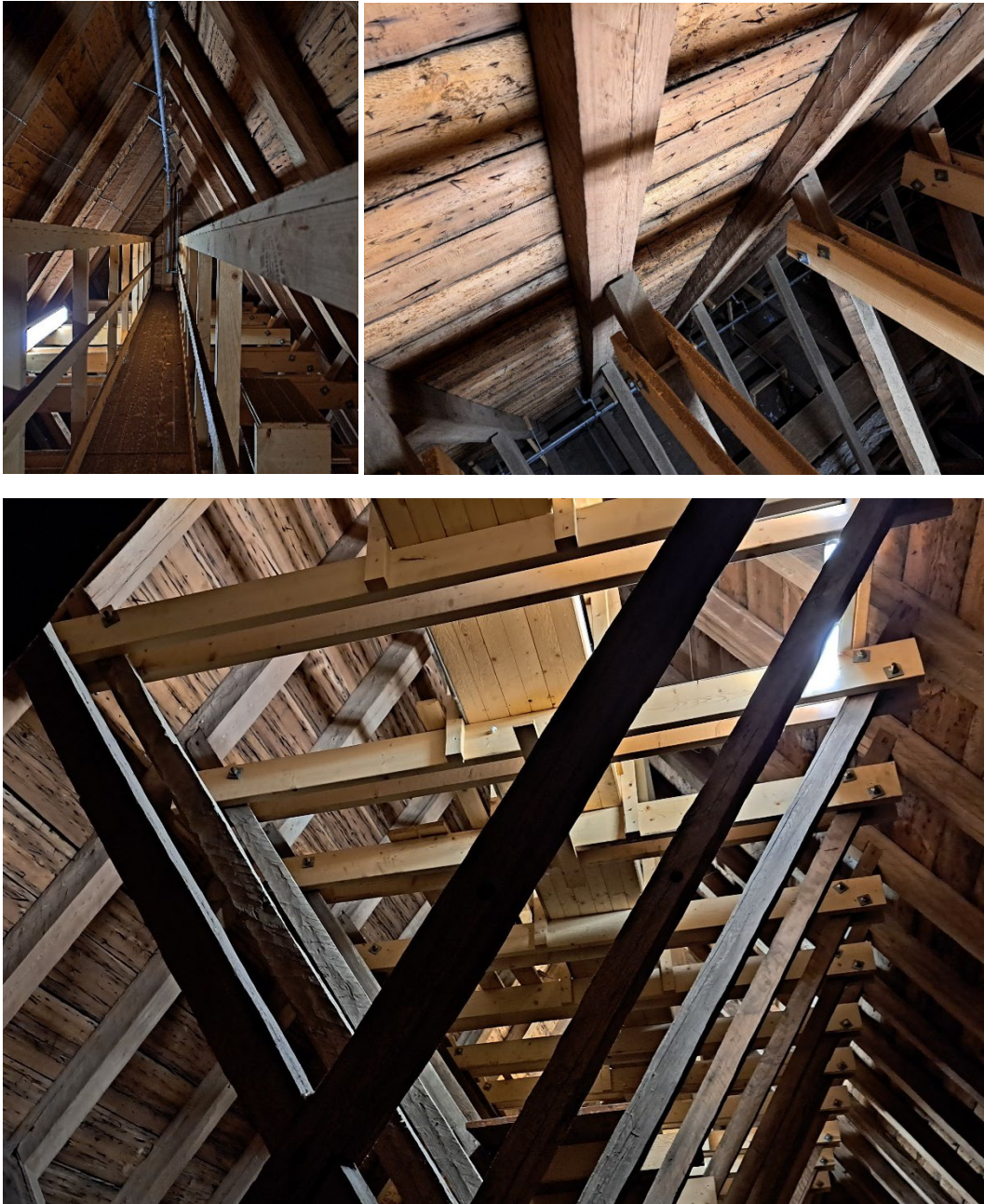
Figur 70 Exempel på gångbrygga konstruerad av trä för att ge åtkomst till rörsystem, sprinkler och branddetektorer installerade vid taknock. Gångbryggan har ordentliga räcken och dess bärbalkar har en skonsam infästning. Bärbalkarnas fästpunkt har inte genomgående bultar, i stället är de klämda runt takstolarnas tvärbalkar. Foto: Magnus Arvidson, RISE.
