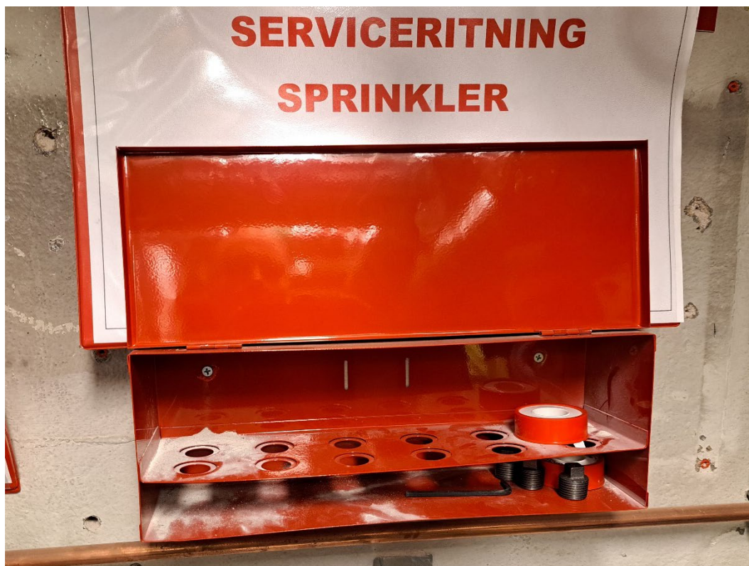
Figur 57 Reservsprinklerskåp i en kyrka där reservsprinkler helt saknas. När fotot togs hade anläggningen varit i drift i omkring 5 år. Foto: Magnus Arvidson, RISE.
