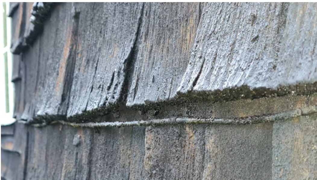
Figur 92 Värmedetektkabel på en tjärad träfasad där det finnas anledning att byta ut kabeln på grund av beläggning av trätjära eftersom det inte uppfyller fabrikantens anvisningar. Foto: Tomas Godby, Brandskyddsbesiktning T Godby AB.
