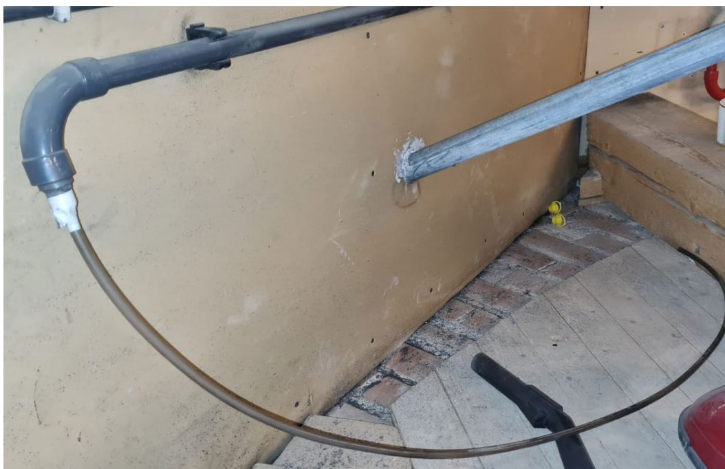
Figur 87 Samplingsrör med slang tänkt att vara neddragen till ett kyrkorum. Slangen har dragits upp vid byte av belysningsarmatur men har sedan inte återmonterats, vilket uppmärksammades vid en revisionsbesiktning. Foto: Tomas Godby, Brandskyddsbesiktning T Godby AB.
