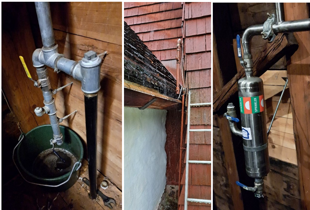
Figur 25 Till vänster visas två dräneringsventiler för ett torrörssystem i samma kyrka, en ventil invändigt i kyrkan och en ventil placerad utvändigt kyrkan. Mellan två avstängningsventiler finns en rörvolym som fylls till hälften med frostskyddsvätska (ofta spolarvätska). Avsikten är att kondensvatten i sprinklersystemet ska ansamlas i denna volym som dräneras och fylls på med frostskyddsvätska regelbundet. Fotot till höger visar en dräneringsventil med kärl tillverkat av rostfritt stål. Foto: Magnus Arvidson, RISE.
