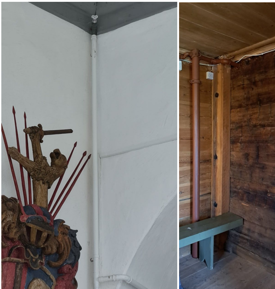
Figur 34 Exempel på inmålning av synliga sprinklerrör för att göra dem diskreta. Foto: Tomas Godby, Brandskyddsbesiktning T Godby AB och Magnus Arvidson, RISE.
