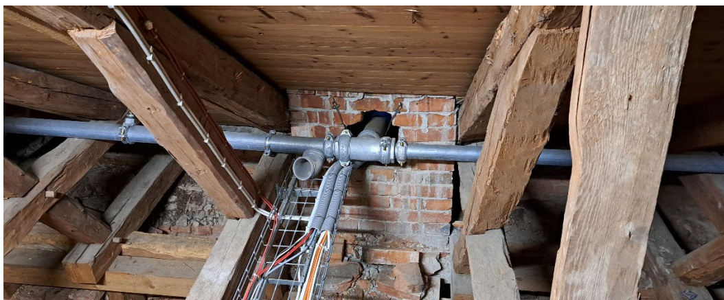
Figur 32 Exempel på förläggning av distributionsrör från en sprinklercentral placerad i ett tidigare pannrum och till kyrkvinden genom den forna skorstenen. Foto: Magnus Arvidson, RISE.
