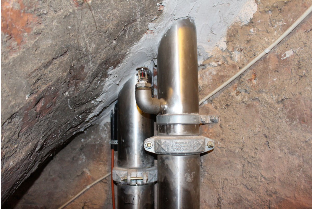
Figur 33 Så kallad skyddssprinkler på en matarledning som passerar en osprinklad yta. Foto: Magnus Arvidson, RISE.
