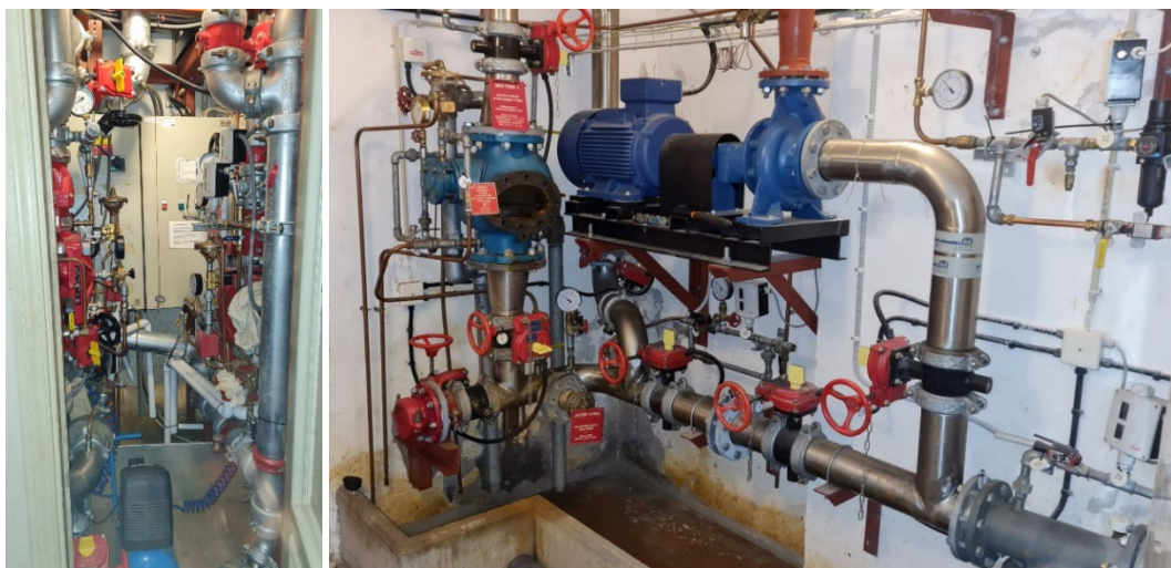
Figur 8 Extremt trång sprinklercentral i en stadskyrka (vänster) med två larmventiler och en elmotordriven pump ovanför och en sprinklercentral med elmotordriven pump och en larmventil (höger) i annan kyrka. Foto: Tomas Godby, Brandskyddsbesiktning T Godby AB.
