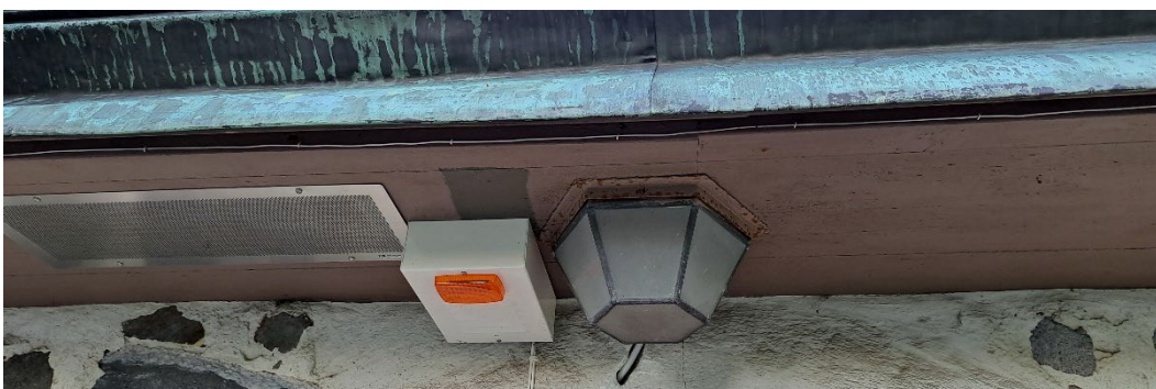
Figur 93 Linjär värmedetektor med tunt sensorrör som är fyllt med vanlig luft (atmosfärstryck) under takfoten på en kyrka. Foto: Magnus Arvidson, RISE.
