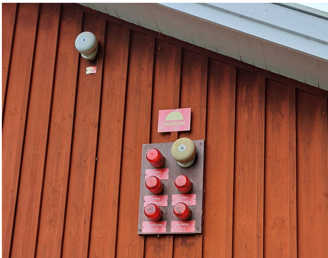
Figur 30 Elektriskt larmdon med blixtljus på fasad på teknikbyggnad. Foto: Magnus Arvidson, RISE.
