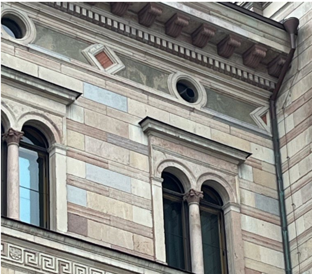
Figur 77 På fotot syns ett av utloppen för släckvatten från ett sprinklersystem som är installerat på vinden på Nationalmuseum. Från gatunivån är dock utloppet knappt synligt för blotta ögat. Foto: Staffan Bengtson, Brandskyddslaget AB.
