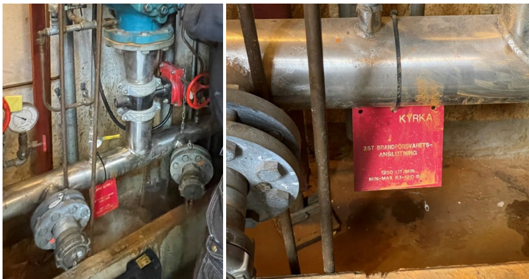
Figur 56 Brandkårsanslutningar och dess skyltning i en större stadskyrka. Foto: Emil Egeltoft, Brandskyddslaget AB.
