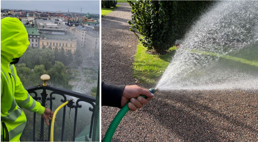
Figur 60 Funktionsprov av ett pre-actions-system via slang som anslutits till provningsventil (placerad i det hydrauliskt sämsta läget i rörsystemet) i ett kyrktorn respektive ett biutrymme i kyrksal. I slangens ände sitter en sprinkler med en munstycksöppning motsvarande de minsta sprinklerna som är installerade i sprinklersektionen. Foto: Tomas Godby, Brandskyddsbesiktning T Godby AB och Emil Egeltoft, Brandskyddslaget AB.
