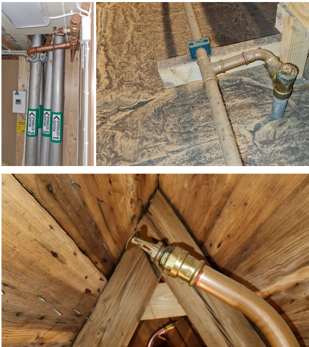
Figur 49 Väggsprinkler i litet utrymme på ett grenrör av koppar som är anslutet till matarledning av rostfritt stål i ett våtrörssystem, ett grenrör av koppar i ett torrörssystem som ansluter till en så kallade torrörssprinkler samt sprinkler vid taknocken på en vind. Foto: Tomas Godby, Brandskyddsbesiktning T Godby AB.
