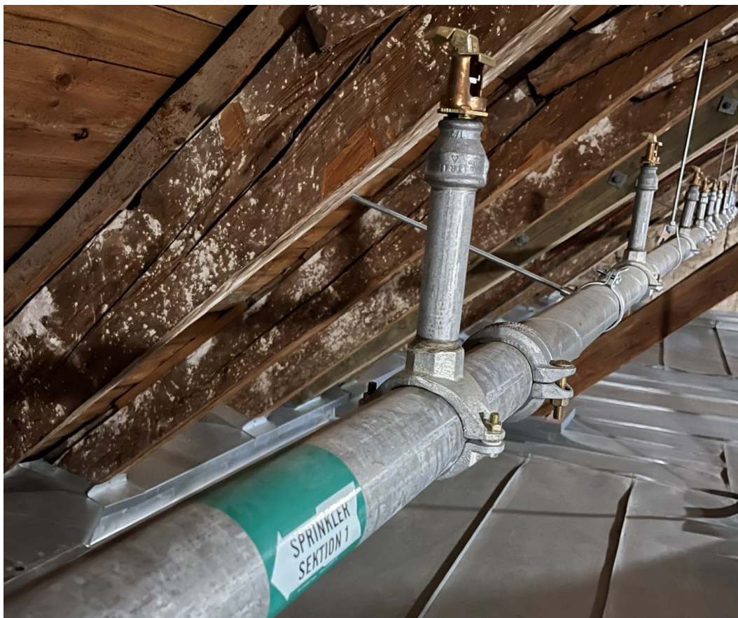
Figur 65 Så kallade vindssprinkler installerade i en kulturhistoriskt värdefull byggnad. Här kan också noteras att bjälklaget har ett ytskikt av falsad takplåt och att släckvatten från sprinkler leds till byggnadens utsida. Foto: Johan Hanberger, Statens fastighetsverk.
