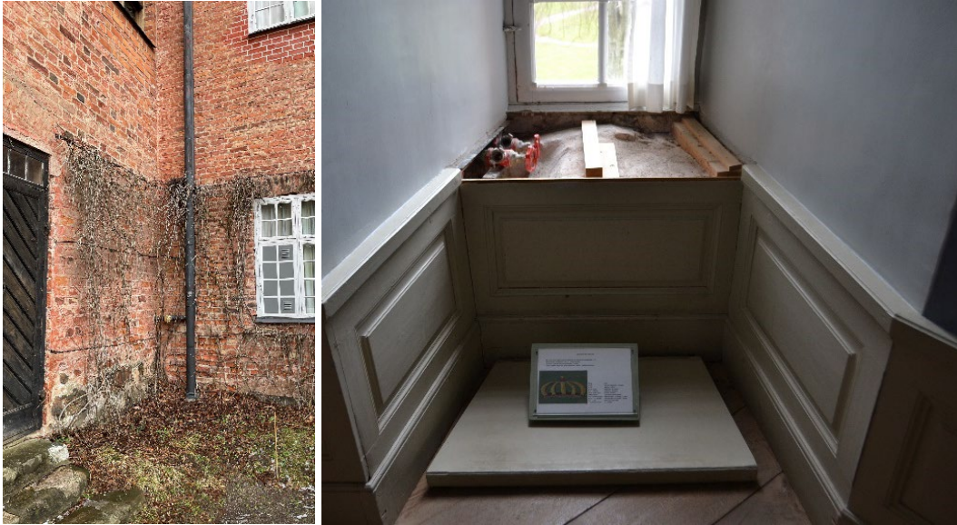
Figur 69 Stigarledning gömt bakom stuprör med dolda uttag under bänk. Foto: Emil Egeltoft, Brandskyddslaget AB och Jim Sjöberg.
