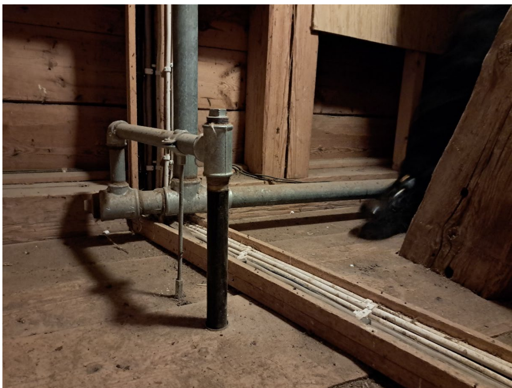
Figur 20 En av de så kallade torrörssprinkler som är installerade genom vindsbjälklaget och som är anslutna till ett rörsystem på kyrkvinden. Foto: Magnus Arvidson, RISE.
