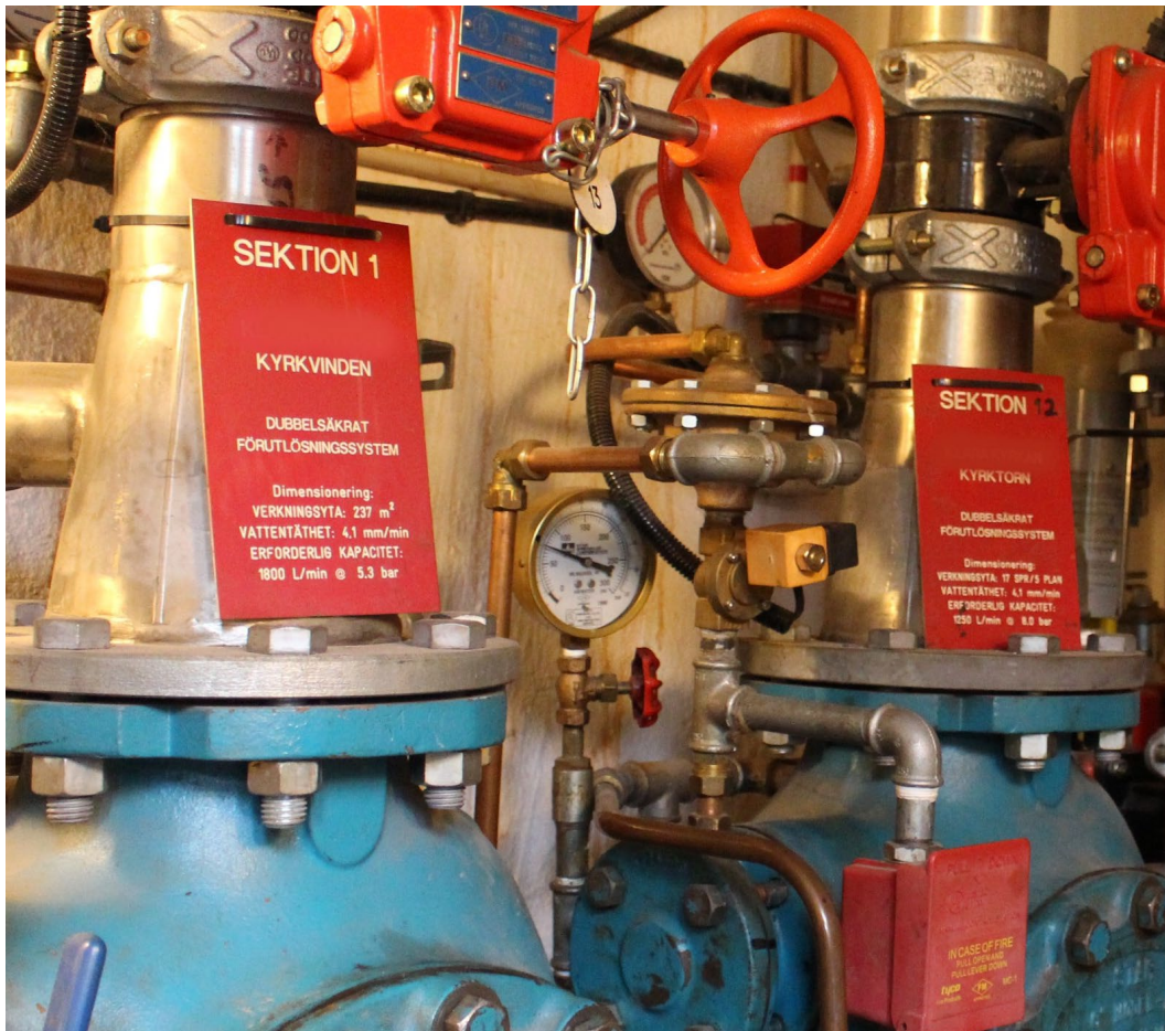
Figur 54 Bra exempel på skyltar vid larmventiler som anger typ av system, vilka delar av byggnaden som sektionen skyddar och dimensioneringsdata. Foto: Magnus Arvidson, RISE.
