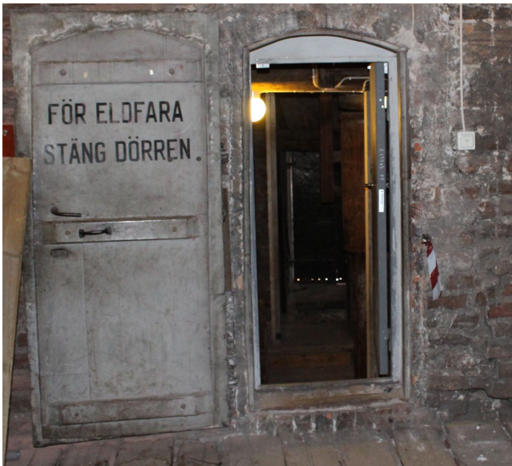
Figur 97 En illustration av äldre passivt brandskydd i en större stadskyrka. Här kan noteras att dörröppningen och dess äldre branddörr har kompletterats (möjligen till och med helt ersatts men sparats på sin plats) med en modern branddörr. Foto: Magnus Arvidson, RISE.
