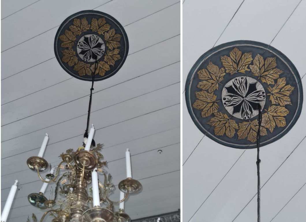
Figur 85 Förläggning av samplingsrör (slang) för ett aspirerande system vid genomföringen för staget och elkabeln för en ljuskrona. Samplingsöppningen är helt osynlig från golvnivå. Foto: Tomas Godby, Brandskyddsbesiktning T Godby AB.
