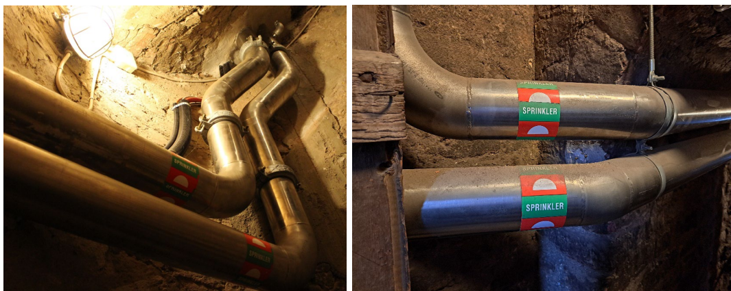
Figur 45 Distributionsrör av rostfritt stål som är sammanfogade både med mekaniska rörkopplingar och svetsning. Installationen har krävt flera rörböjar som inte är 90°. Foto: Magnus Arvidson, RISE.
