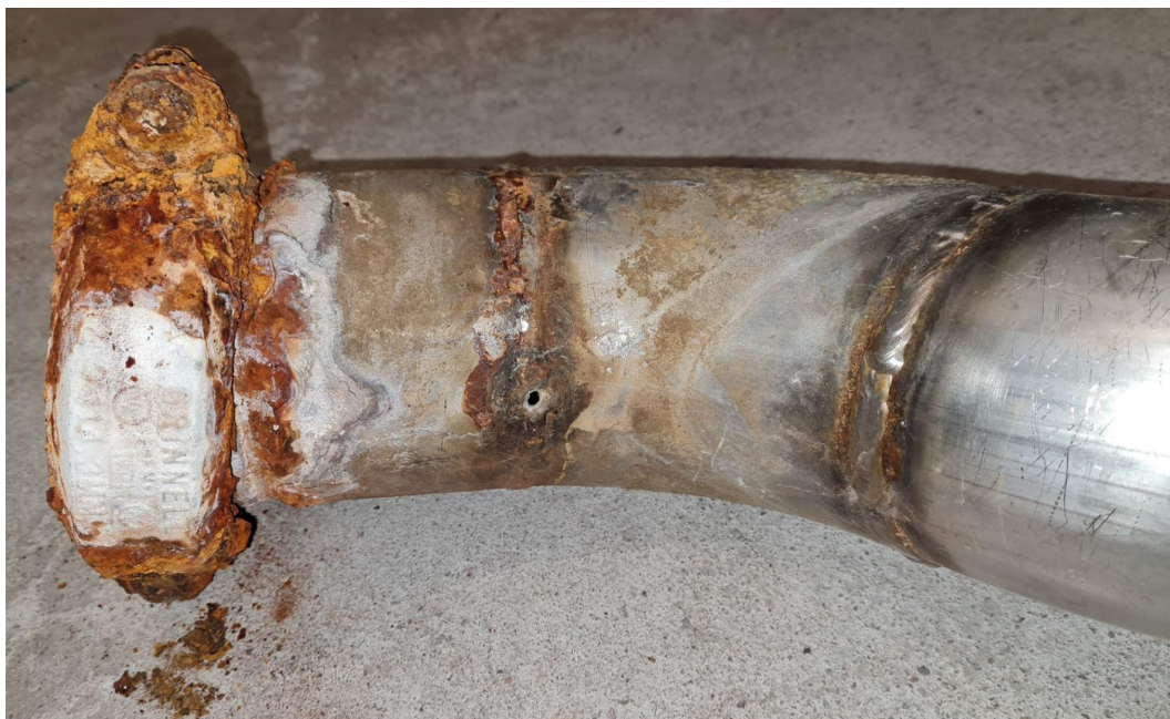
Figur 46 Rör av rostfritt stål med mekanisk rörkoppling av galvaniserat stål vilket har resulterat i galvanisk korrosion. Röret har varit installerat i en bassäng och har därmed varit konstant exponerat för vatten. Foto: Tomas Godby, Brandskyddsbesiktning T Godby AB.
