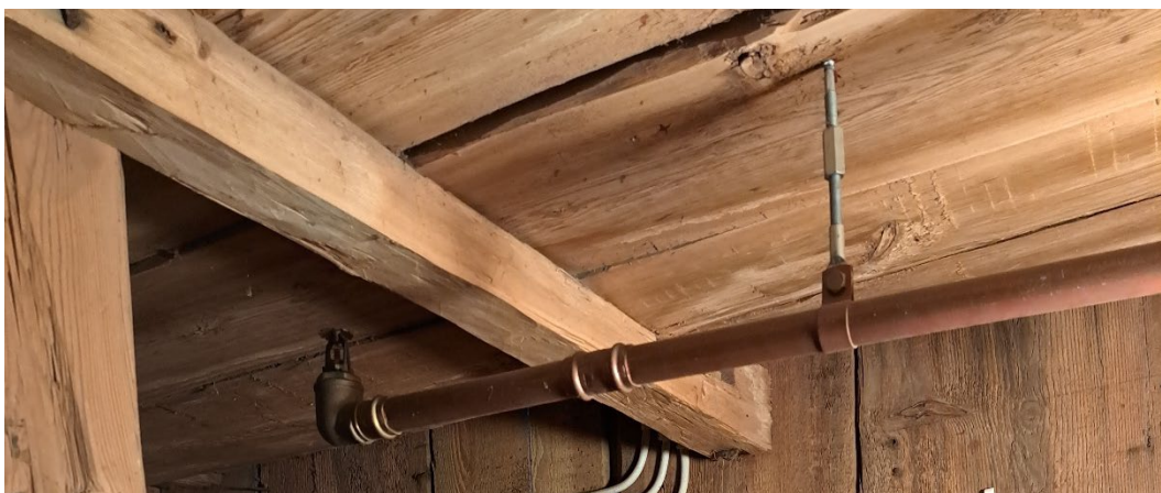
Figur 48 Installation med kopparrör i en kyrka med en horisontell väggssprinkler respektive uppåtriktad sprinkler. Här kan noteras att rörsvepet är av koppar. Foto: Emil Egeltöft, Brandskyddslaget AB och Magnus Arvidson, RISE.
