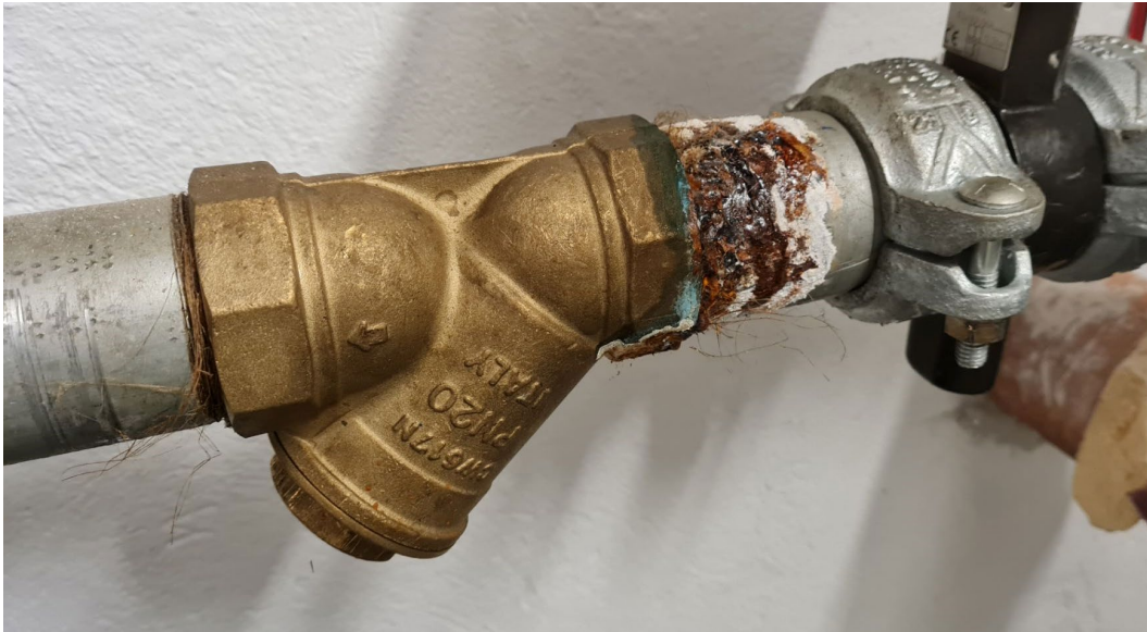
Figur 41 Kraftigt lokalt utvändigt korrosionsangrepp (galvanisk korrosion) i ett våtrörssystem med galvaniserade stålrör med en sil i mässing. Troligen har ett mindre vattenläckage bidragit till en elektrolyt vilket är en förutsättning för galvanisk korrosion. Nedströms silen är gänganslutningen tät och det galvaniserade röret oskadat. Foto: Tomas Godby, Brandskyddsbesiktning T Godby AB.
