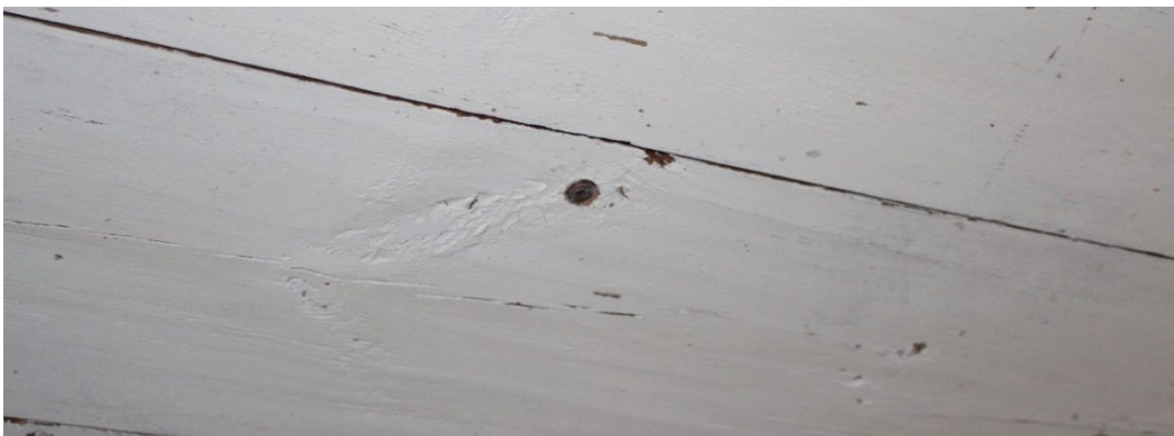
Figur 86 Dold förläggning av samplingsrör för ett aspirerande system i ett golvbjälklag med samplingsöppning till röret genom takplankan. Denna förläggning kräver att golvplankor på våningen ovanför demonteras. Foto: Magnus Arvidson, RISE.
