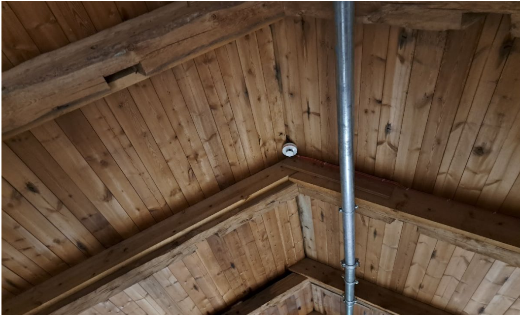
Figur 83 Rökdetektor installerad vid taknocken på en kyrkvind som dessutom har ett torrörssystem. Foto: Magnus Arvidson, RISE.
