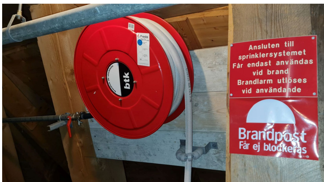
Figur 6 Invändig inomhusbrandpost som är ansluten till sprinklersystemet (torrörssystem) på en kyrkvind. Om brandposten används så aktiveras brandlarmet i byggnaden. Vintertid är det viktigt att rörsystemet dräneras efter en insats för att förhindra frysning av kvarstående vatten. Foto: Tomas Godby, Brandskyddsbesiktning T Godby AB.
