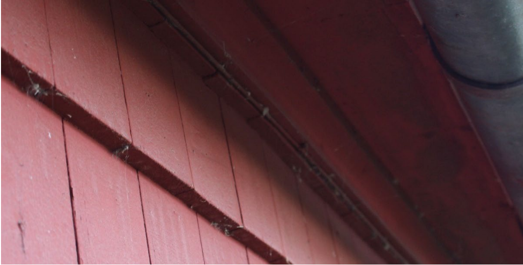
Figur 90 Värmedetektionskabel installerad under takfoten på 1600-tals träkyrka. Detta är en diskret förläggning men ej optimalt för tidig detektion eftersom kabeln ligger direkt mot underlaget, nära fasaden och dessutom är övermålad. Foto: Magnus Arvidson, RISE.
