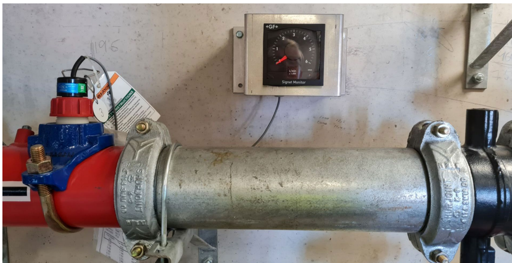
Figur 9 Fast installerad flödesmätare för kapacitetsprov i en kyrka. Foto: Tomas Godby, Brandskyddsbesiktning T Godby AB.
