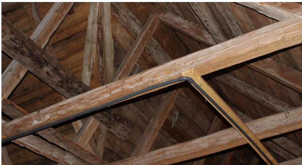
Figur 88 Förläggning av samplingsrör för ett aspirerande system i ett vindsutrymme. Samplingsröret är placerat ett stycke ned från taknocken eftersom varmare luft kan ansamlas i höjdpunkter och ge en temperaturskiktning som fördröjer detektion av brand. Foto: Magnus Arvidson, RISE.
