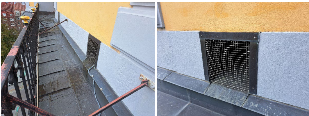
Figur 75 Avledning av vatten till yttertak och vidare ned i hängrännor och stuprör sker via gallerförsedda öppningar i kyrktornets fasad. Foto: Magnus Arvidson, RISE.
