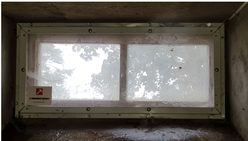
Figur 96 Säkerhetsfönster av polykarbonat installerat innanför ett källarfönster i en kyrka. Foto: Tomas Godby, Brandskyddsbesiktning T Godby AB.
