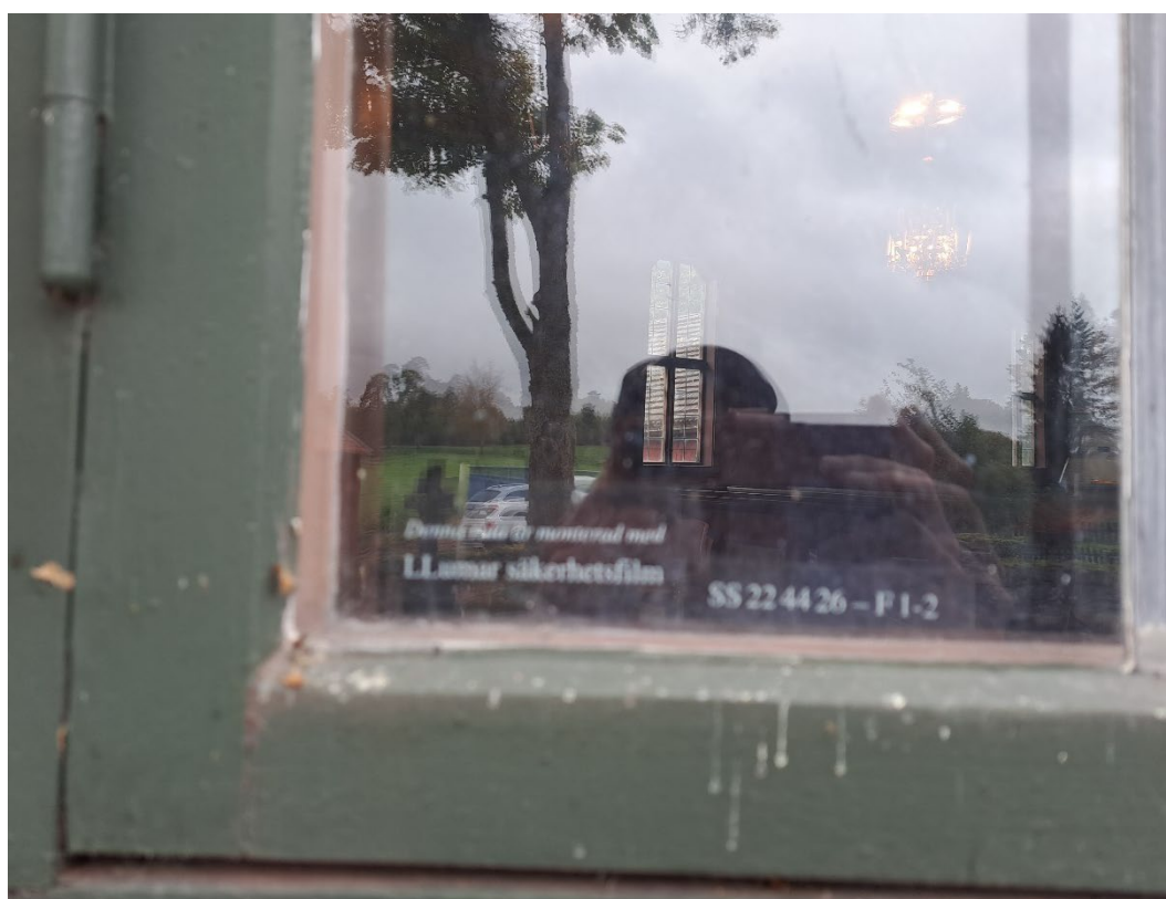
Figur 95 Kyrkfönster förstärkt med säkerhetsfilm för att försvåra inbrottsförsök eller skadegörelse. Foto: Magnus Arvidson, RISE.
