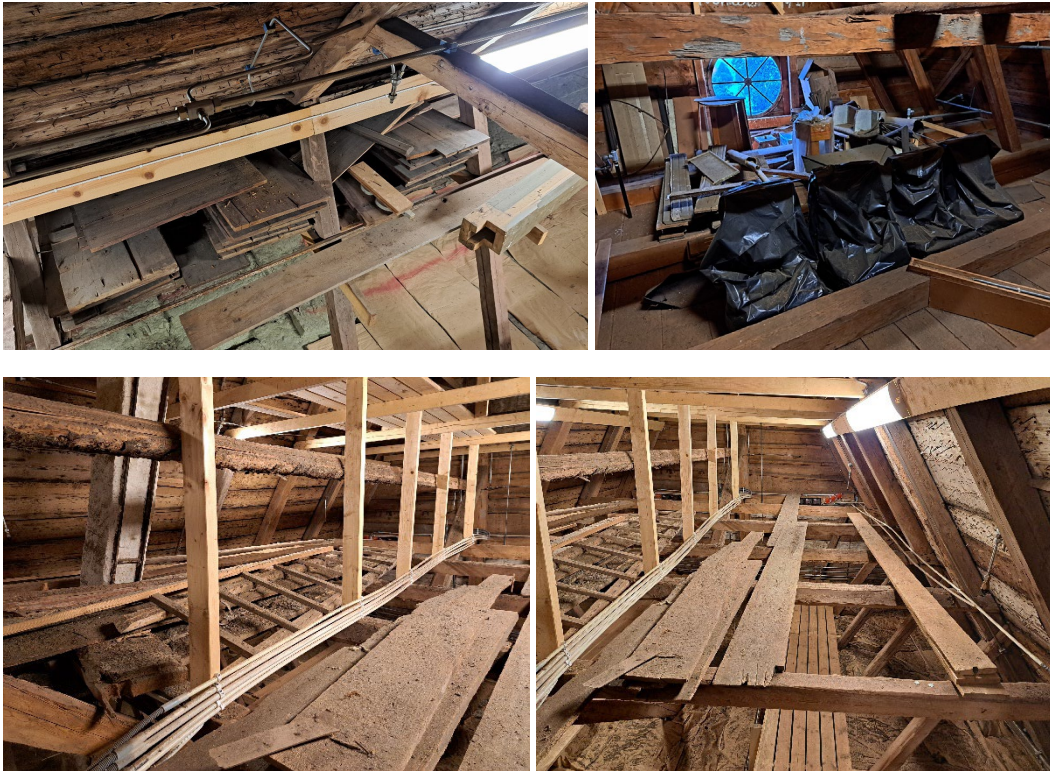
Figur 78 Exempel på lagring av brännbart material på vindar. Foto: Magnus Arvidson, RISE.
