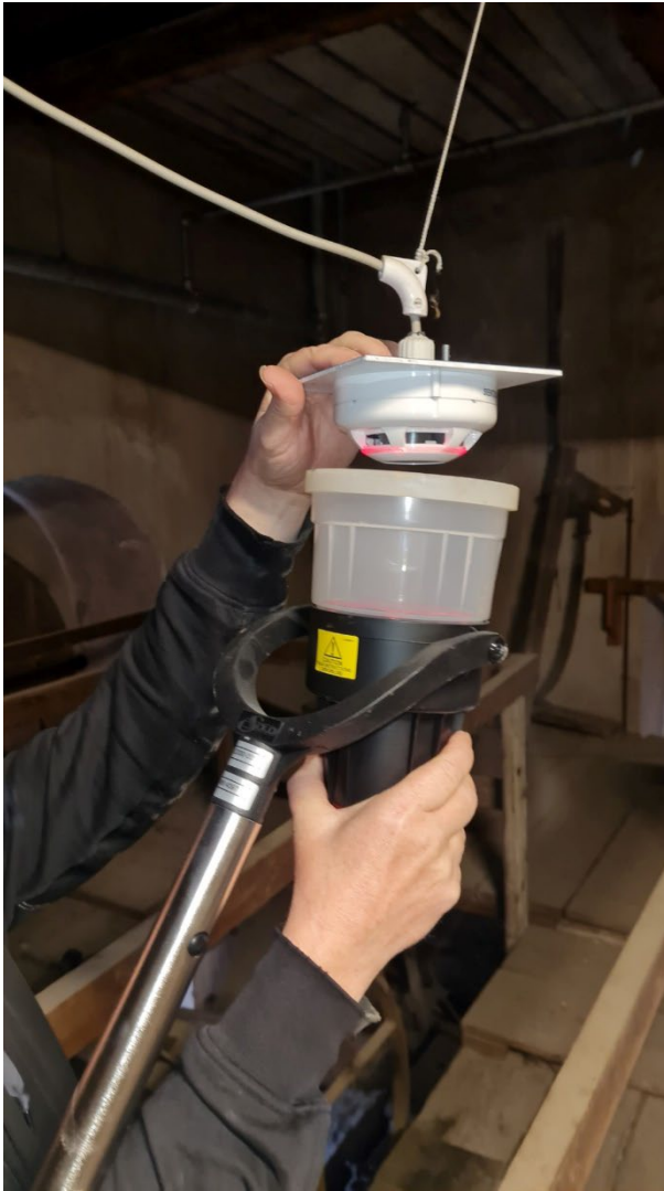
Figur 82 En rökdetektor med hissanordning installerad på en kyrkvind med hög takhöjd. För att underlätta provning går detektorn att sänka ned till golvnivå. Vanligt fel vid användning av hissanordning är att detektorn inte återförs till den höjd (nedpendling) där detektionen förväntas ske utan hamnar för långt ner. Eller att det i utrymmen med hög takhöjd saknas stopp som gör att detektorn blir erforderligt nedpendlad. Foto: Tomas Godby, Brandskyddsbesiktning T Godby AB.
