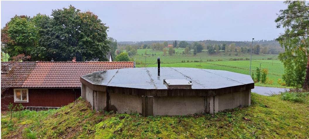
Figur 12 Vattenbassäng (fullvolymbassäng) tillverkad av betong för ett sprinklersystem i en kyrka driftsatt år 2012. Bassängen är placerad i en slänt ovanför teknikbyggnaden vilket ger självfall till sprinklerpumparna. Problem med sediment i bassängen har förekommit. Foto: Magnus Arvidson, RISE.
