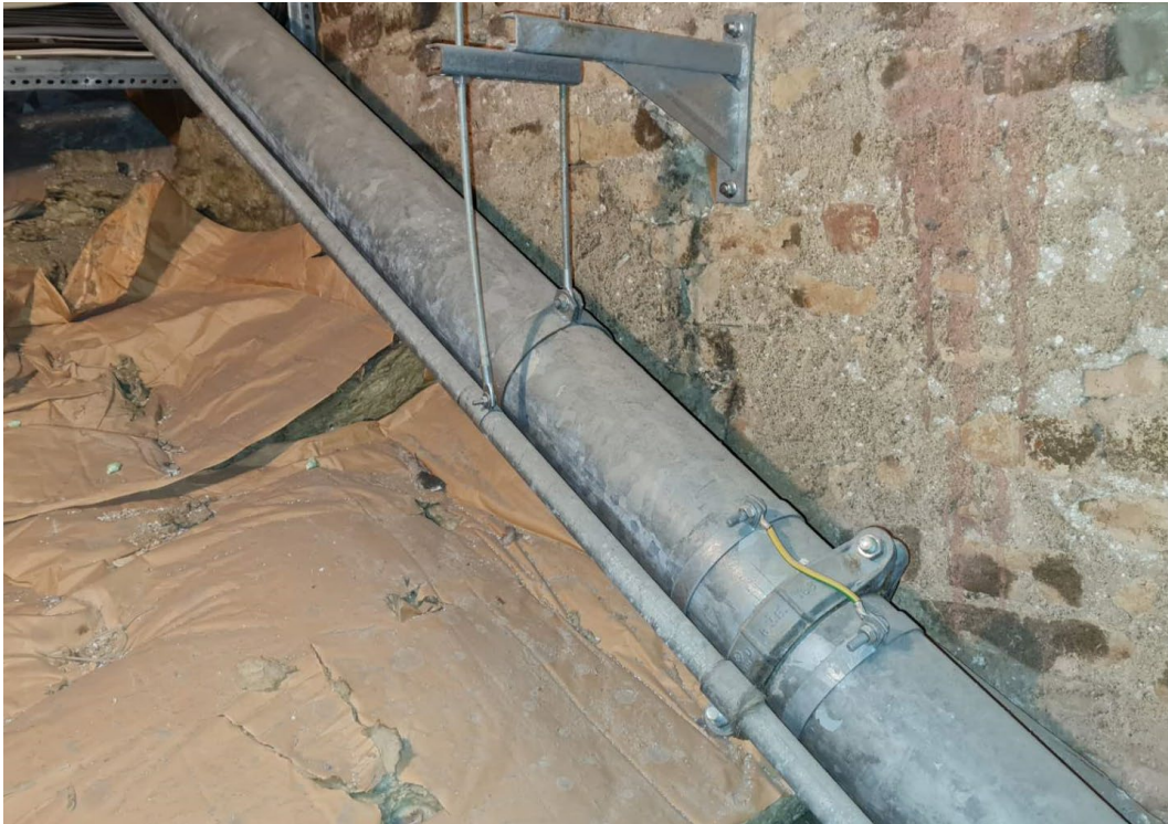
Figur 27 Exempel på en returledning med mindre dimension dragen parallellt med ett distributionsrör till sprinklercentralen där provningsventilen installeras. Sprinklerröret har mekaniska rörkopplingar (rillkopplingar) och jordflätor för att säkerställa god potentialutjämning av hela rörsystemet. Foto: Tomas Godby, Brandskyddsbesiktning T Godby AB.
