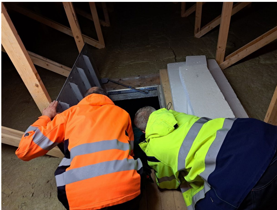
Figur 11 Inspektion av en vattenbassäng (fullvolymbassäng) tillverkad av betong för ett sprinklersystem i en kyrka driftsatt år 2006. Bassängen är placerad i en separat teknikbyggnad som är uppvärmd. Foto: Magnus Arvidson, RISE.
