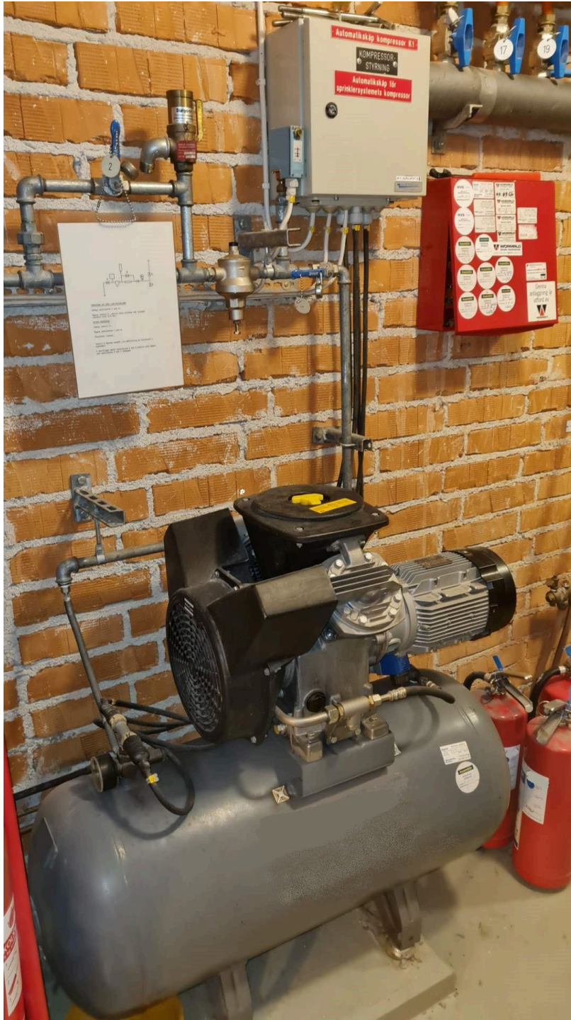
Figur 16 Luftkompressor av hög kvalitet för ett torrörssystem i en kyrka. Kompressorn har varit i drift i närmare 30 år. Luftarrangemang med larm för lågt lufttryck uppströms luftregulatorn ger en mycket tidig signal om något fel uppstår på lufttillförseln.
