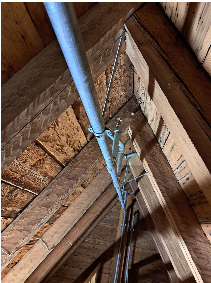
Figur 63 Exempel på en rad med uppåtriktade spraysprinkler placerade nära taknock på en kyrkvind på mycket brant taklutning. Foto: Magnus Arvidson, RISE.
