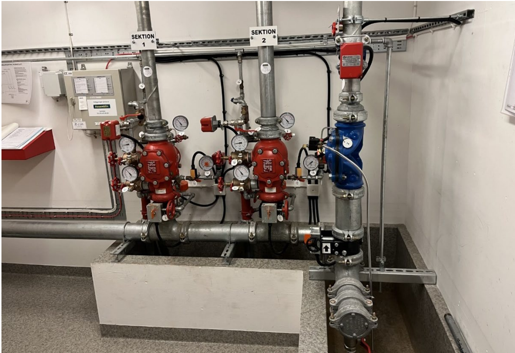
Figur 51 Tydlig skyltning av tillhörande sektioner för torrörsalarmventiler installerade i en kulturhistoriskt värdefull byggnad. Här skulle skyltarna kunna kompletterats med text om vad varje sektion omfattar och sprinklersektionens erforderliga behov för den sämsta verkningsytan. Noterbart är att sprinklersystemet är förberett för en eventuell utökning med fler alarmventiler. Det kan också sägas att alarmventilerna är placerade i ett nybyggt och värmeisolerat utrymme på byggnadens vind. Det gör att rördragningen till respektive sprinklersektion blir mindre omfattande och att systemets fördröjningstider reduceras. Foto: Johan Hanberger, Statens fastighetsverk.
