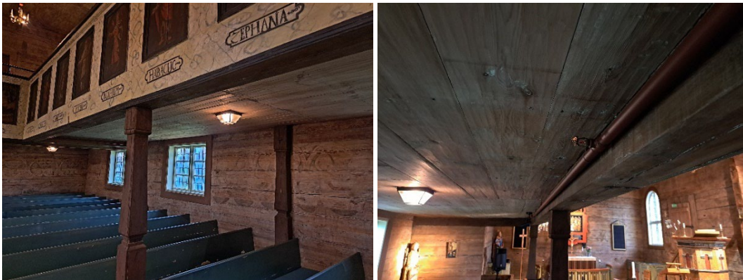
Figur 18 Under läktaren längs långväggen är sprinklerröret förlagt bakom en bärande träbalk och är inte synligt från mittgången i kyrkan. Systemet har horisontella väggsprinkler. Foto: Magnus Arvidson, RISE.
