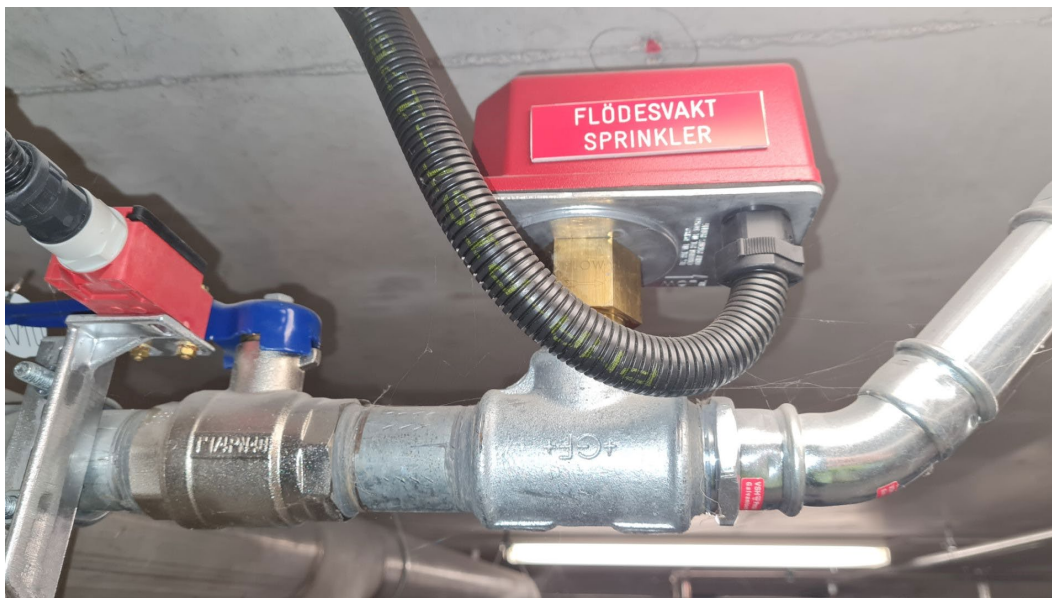
Figur 31 Traditionell typ av flödesvakt som har en "plastpaddel" som rör sig när vatten börjar att flöda i röret. Rörelsen fångas upp av en elektrisk brytare som ger en signal till ett larm. Foto: Tomas Godby, Brandskyddsbesiktning T Godby AB.
