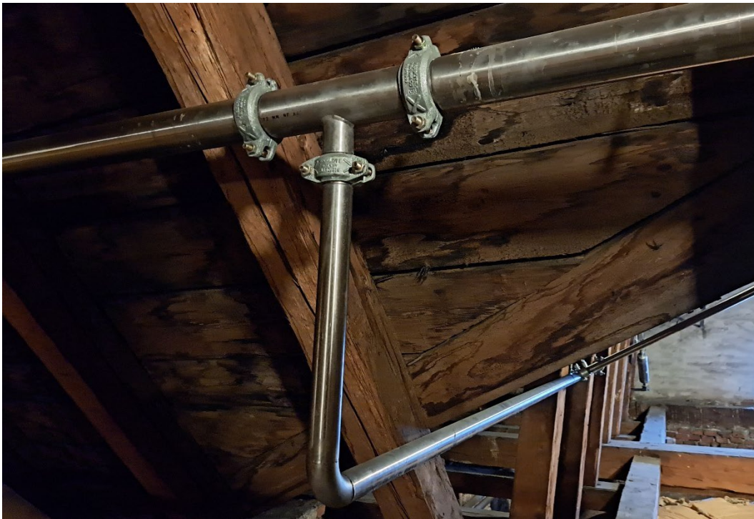
Figur 44 Rostfritt sprinklerrör som är sammanfogat både med mekaniska galvaniserade rörkopplingar (rillkopplingar) och svetsning. Foto: Magnus Arvidson, RISE.
