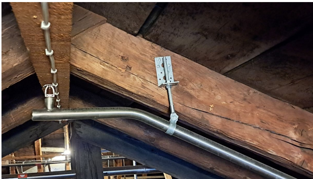
Figur 36 Grenrör av rostfritt stål i ett torrörssystem i en större stadskyrka. Här ses den infästning som ska ge mindre åverkan på trätakstolen än en traditionell infästning med fransk träskruv. Foto: Magnus Arvidson, RISE.
