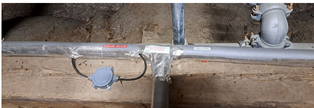
Figur 89 Termisk isolering med tillhörande värmekabel för ett samplingsrör som är förlagt på en kyrkvind som suger in luft från ett uppvärmt kyrkorum. Foto: Magnus Arvidson, RISE.
