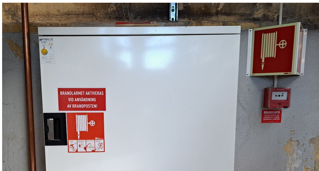
Figur 5 Invändig inomhusbrandpost som är ansluten till sprinklersystemet (våtrörssystem) i byggnaden. Om brandposten används så aktiveras brandlarmet i byggnaden. Till höger om brandposten finns dessutom en larmknapp för brandlarmet. Foto: Magnus Arvidson, RISE.
