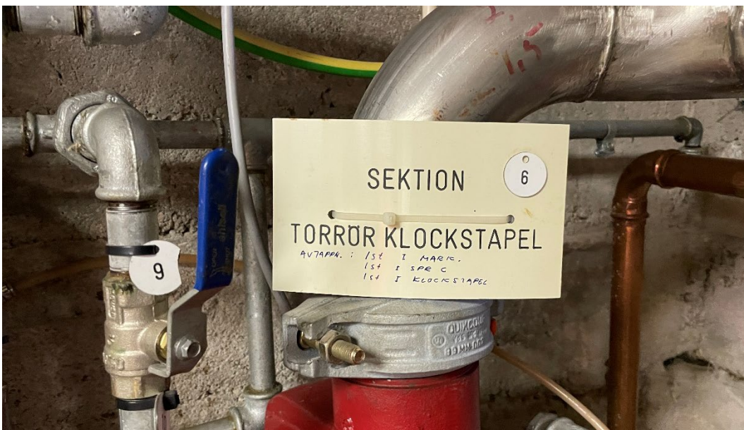
Figur 52 Skyltning av torrörsalarmventil för en klockstapel där information lagts till av anläggningsskötarna om var systemets dräneringsventiler är belägna. Detta är ett exempel på att användaren kan vara den som bäst ser behovet av vilken information som behövs och var den ska finnas. Foto: Emil Egeltøft, Brandskyddslaget AB.
