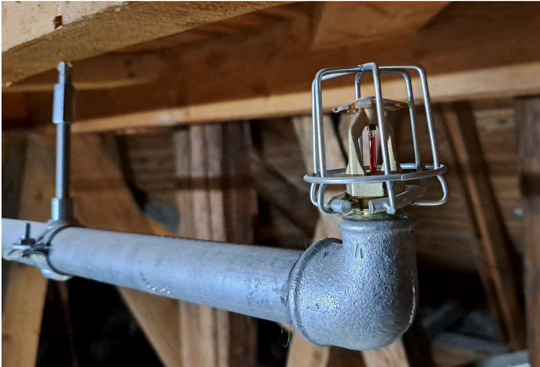
Figur 24 Sprinkler med skyddskorg i en sprinklerinstallation på en kyrkvind. Här kan noteras att den uppåtriktade sprinklern inte är installerad enligt kraven, det vill säga att sprinklerokets plan ska vara parallell med röret. Foto: Magnus Arvidson, RISE.
