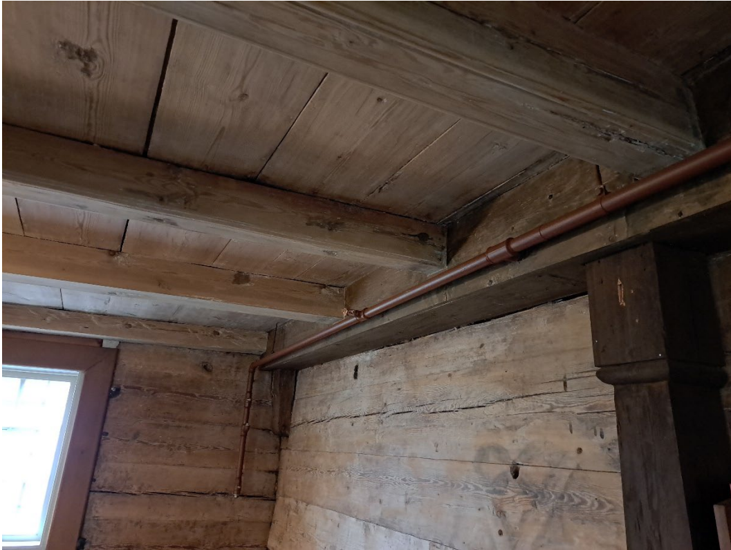
Figur 17 Under kyrkans orgelläktare är rören synliga (men inmålade) och har horisontella väggsprinkler. Vid hörnet syns en av systemets dräneringsventiler. Notera sprinklerörets lutning mot dräneringsventilen. Foto: Magnus Arvidson, RISE.
