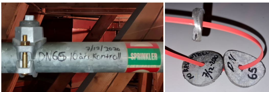
Figur 59 Invändig rörkontroll i ett torrörssystem installerat på vinden i en större stadskyrka. Rörsystemet är byggt av galvaniserade stålrör och kontrollen har gjorts genom att borrhävar tagits från olika delar av rörsystemet. Systemet installerades år 1996 och rörsystemet var utan anmärkning efter närmare 25 års drifttid. Här kan anmärkas att det varit bättre om borrhävar tagits från botten av röret där korrosion ofta förekommer i just torrörssystem. Foto: Tomas Godby, Brandskyddsbesiktning T Godby AB.
