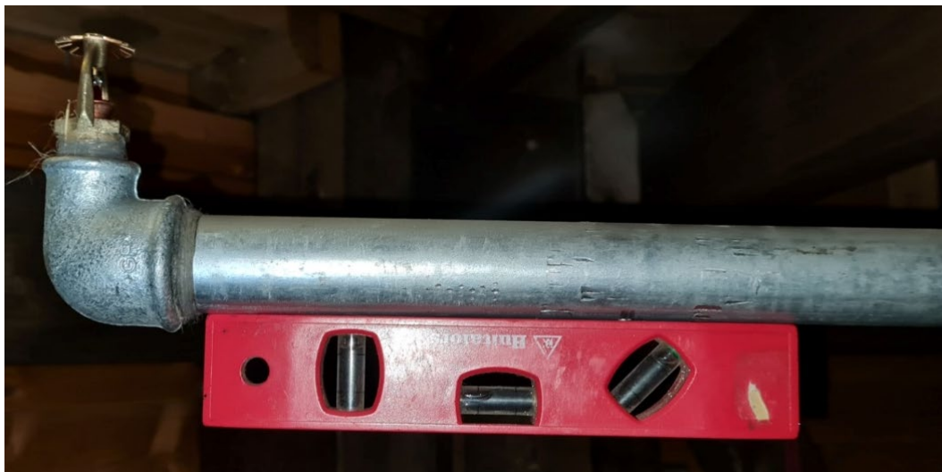
Figur 35 Lutning av grenrör i torrörssystem på en kyrkvind. I detta fall är rörlutningen korrekt. Här kan noteras att den uppåtriktade sprinklern inte är installerad enligt kraven, det vill säga att sprinklerokets plan ska vara parallell med röret. Foto: Tomas Godby, Brandskyddsbesiktning T Godby AB.
