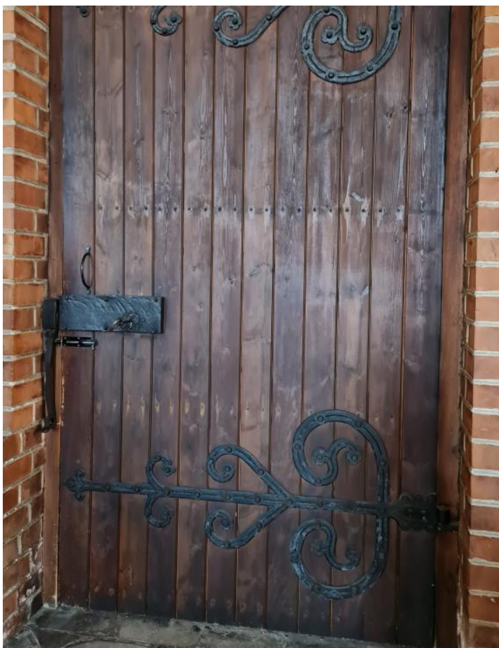
Figur 19. Beslagning av inåtgående dörrar för utrymning.
