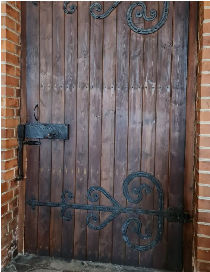
Figur 24. Beslagning av inåtgående dörrar för utrymning.
