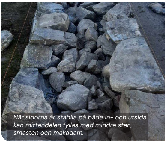
Före-bild på murens skick, när renoveringen startade i november 2024.
