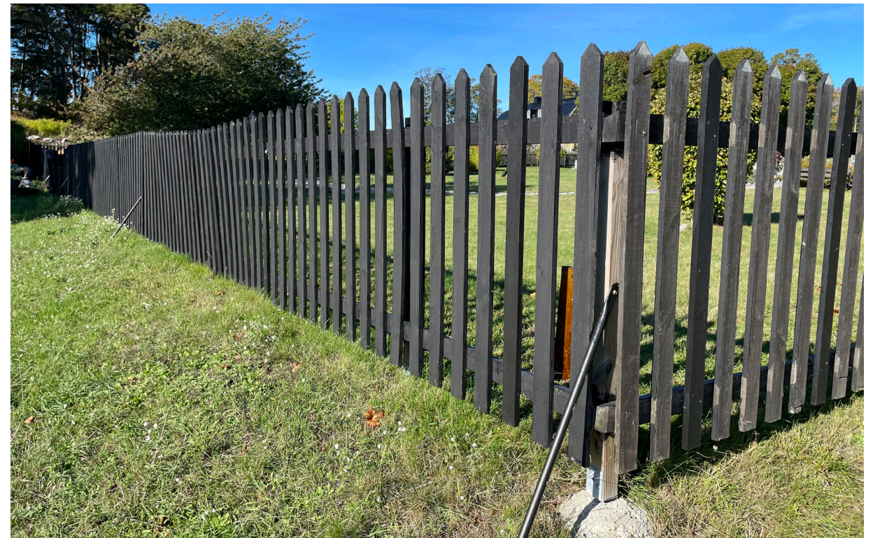
Kyrkogården omgärdas av ett trästaket som vid den södra och östra sträckningen har stöttats upp med järnstolpar. Staketet sviktar utåt eller inåt på flera ställen och är i behov av att tjäras om.
