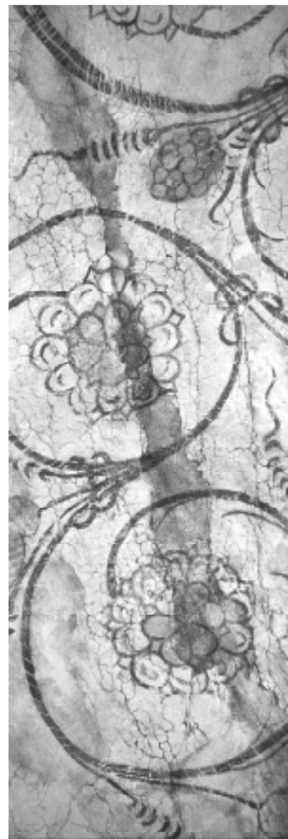
Fuktskador på kalkmåleri, Strängnäs. Foto: L. Göthberg.
