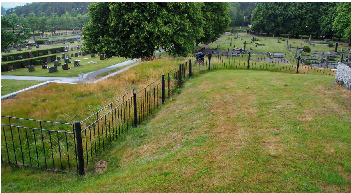
Staket/skyddsräcke ovanför bårhuset i kvarter 4.
