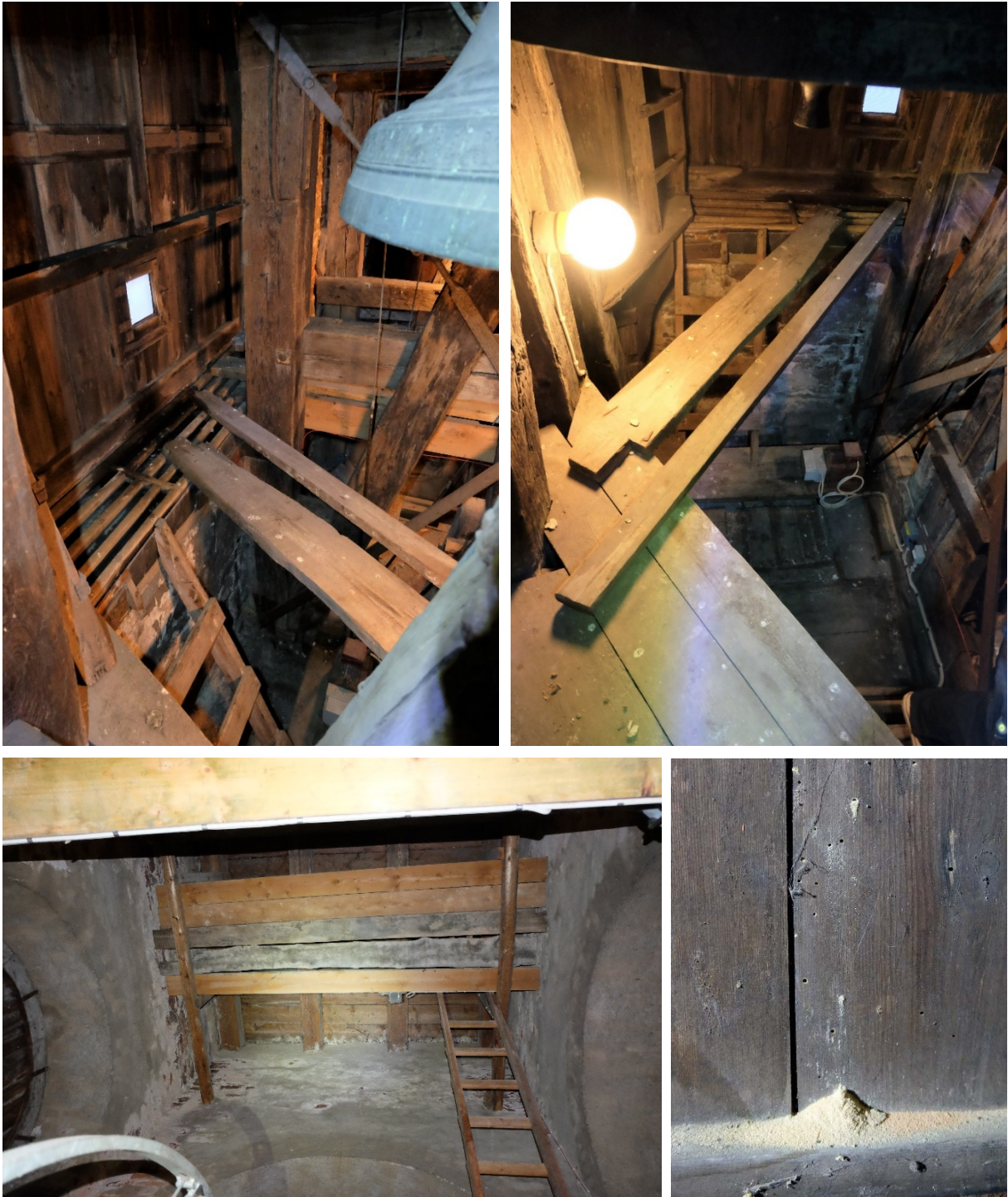
Figur 44 - Överst fr. v: Översiktsbilder från det norra tornets klockrum. Underst fr. v: Det ovanliggande, kläna bjälklaget. Hög med bormjöl från angrepp av strimmig trägnagare, tyder på att angreppen är aktiva.
