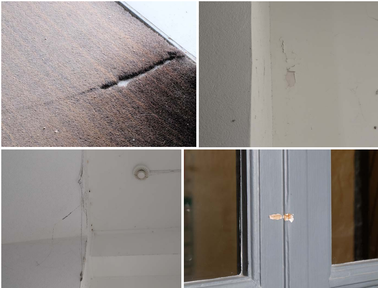
Figur 12 - Överst fr. v: Slitningsskada i golvs kokosmatta. Färgflagnings på vägg. Underst fr. v: Spindelväv i taket. Färgskav på pardörren in till förhallen.
