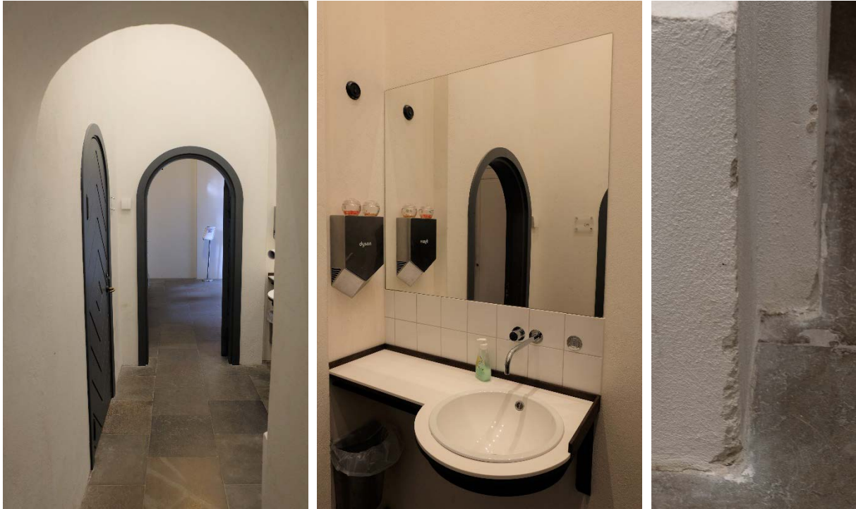
Figur 14 - Fr. v: Översiktsbild över genomgångsrummet. Utrymmet är utrustat med handfat. Stötskador i väggarnas kanter.
