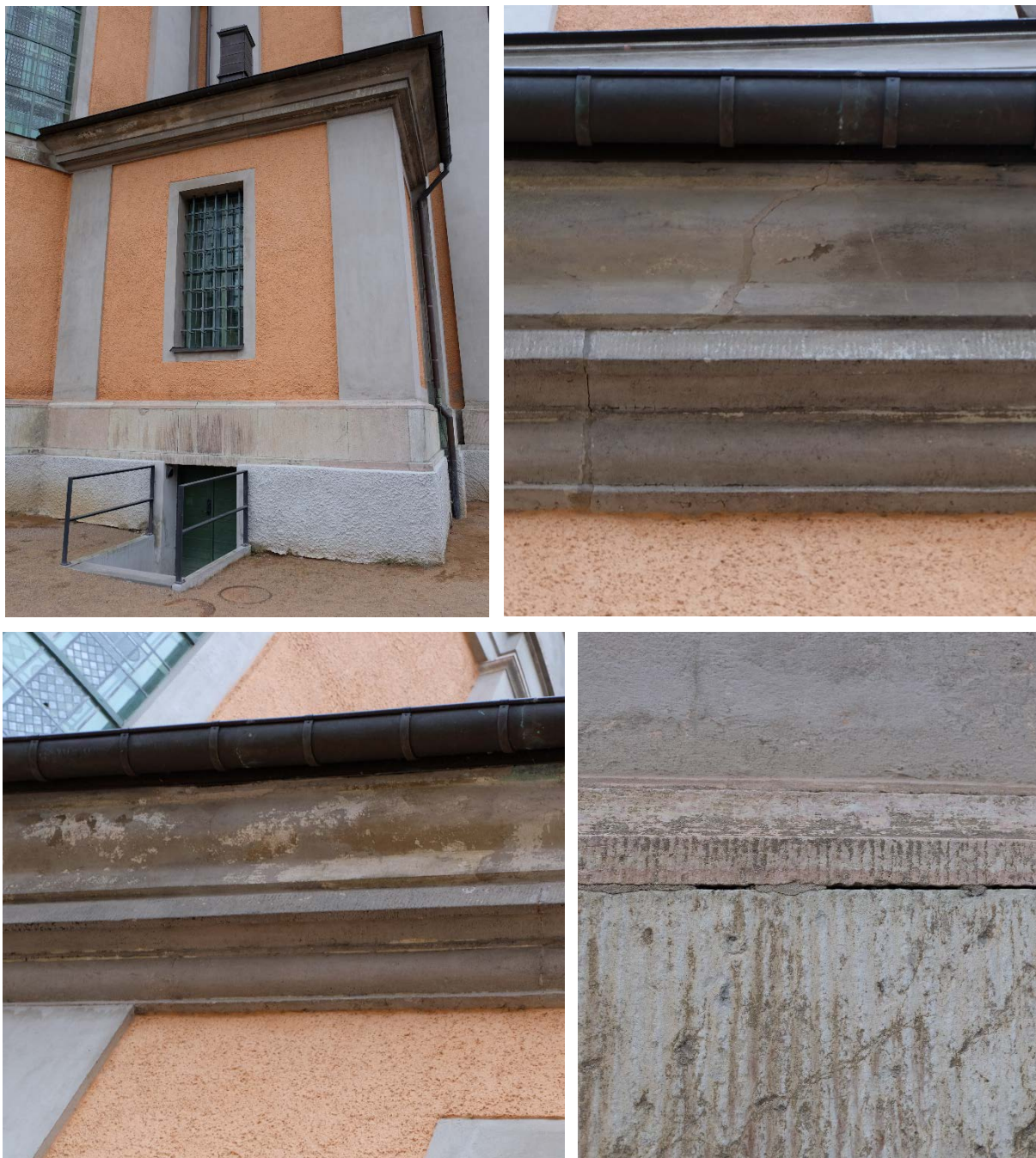
Figur 6 - Överst fr. v: Översiktsbild över den norra utbyggnaden/sakristian. Sprickor förekommer i takfotsgesimsen. Underst fr. v: Färgbortfall och flagnande bemålning på takfotsgesimsen. Fogbortfall i sockelns stenmaterial.
