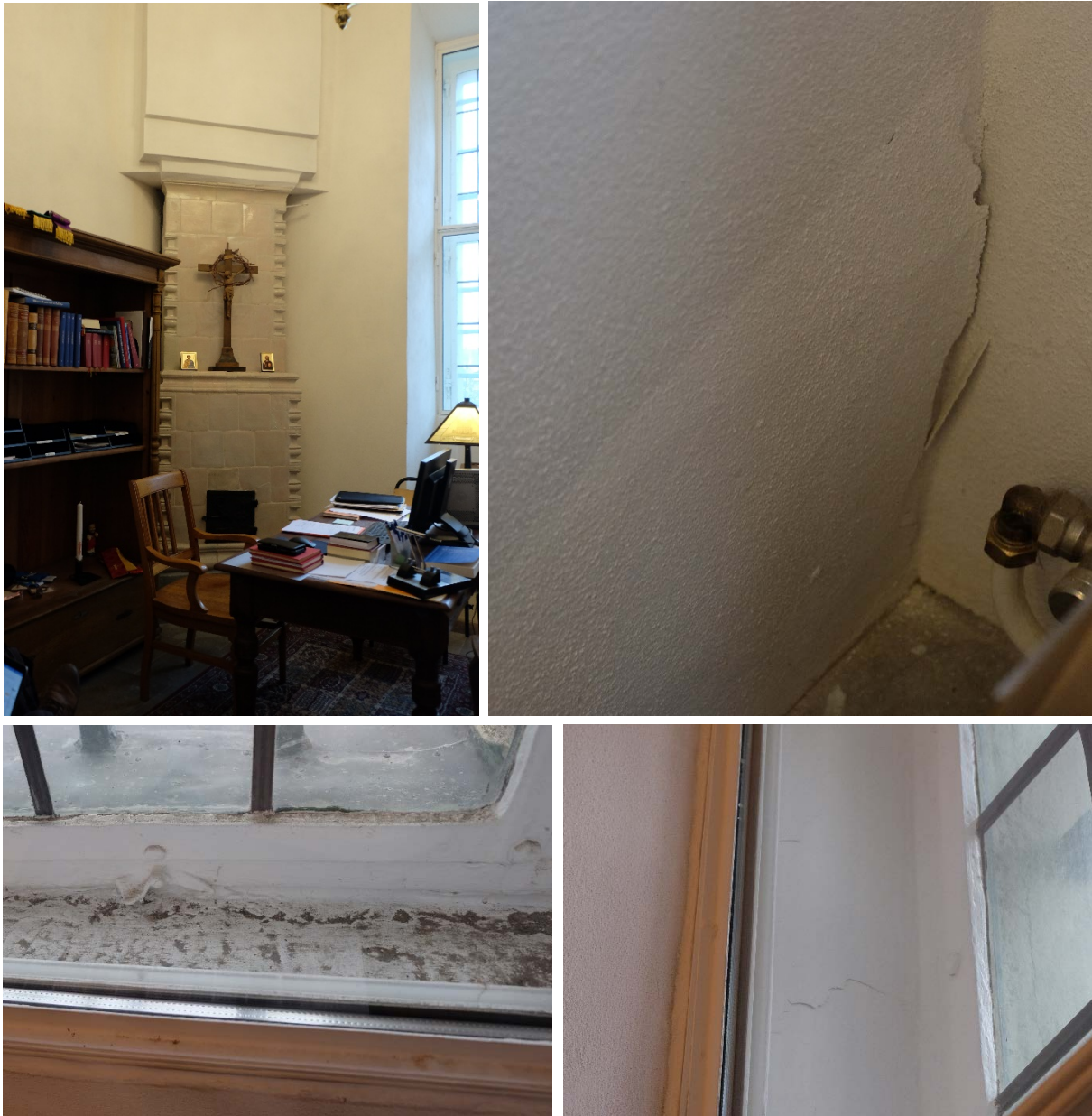
Figur 34 - Överst fr. v: Översiktsbild över konsistorierummet. Underst fr. v: Smuts mellan fönsterbågarna. Flagnande färgskikt i smygen mellan fönsterbågarna.
