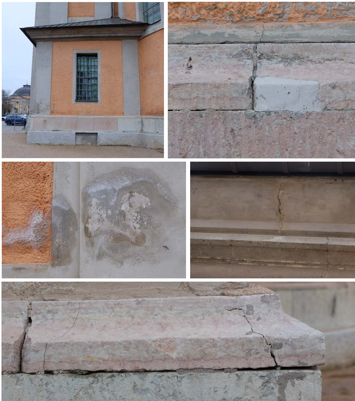
Figur 8 - Överst fr. v: Översiktsbild över den södra utbyggnaden/konsistorium. Lagning i sockelns stenmaterial. Mitten fr. v: Saltutfällningar och vittrande färgskikt. Spricka i takfotsgesimsen. Underst: Fogbortfall och sprickor i sockelns stenmaterial.
