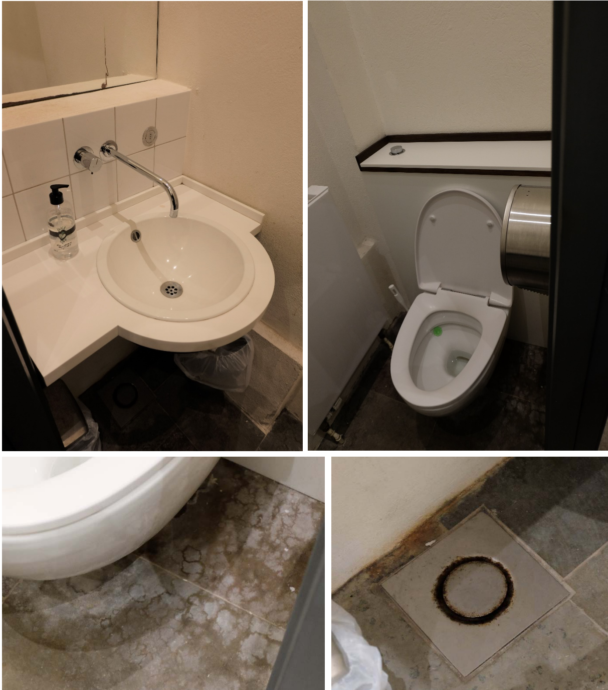
Figur 15 - Överst fr. v: Översiktsbilder på toalettutrymmet. Underst fr. v: Golvet är fläckigt vid toalettstolen. Golvbrunnen är något rostig.
