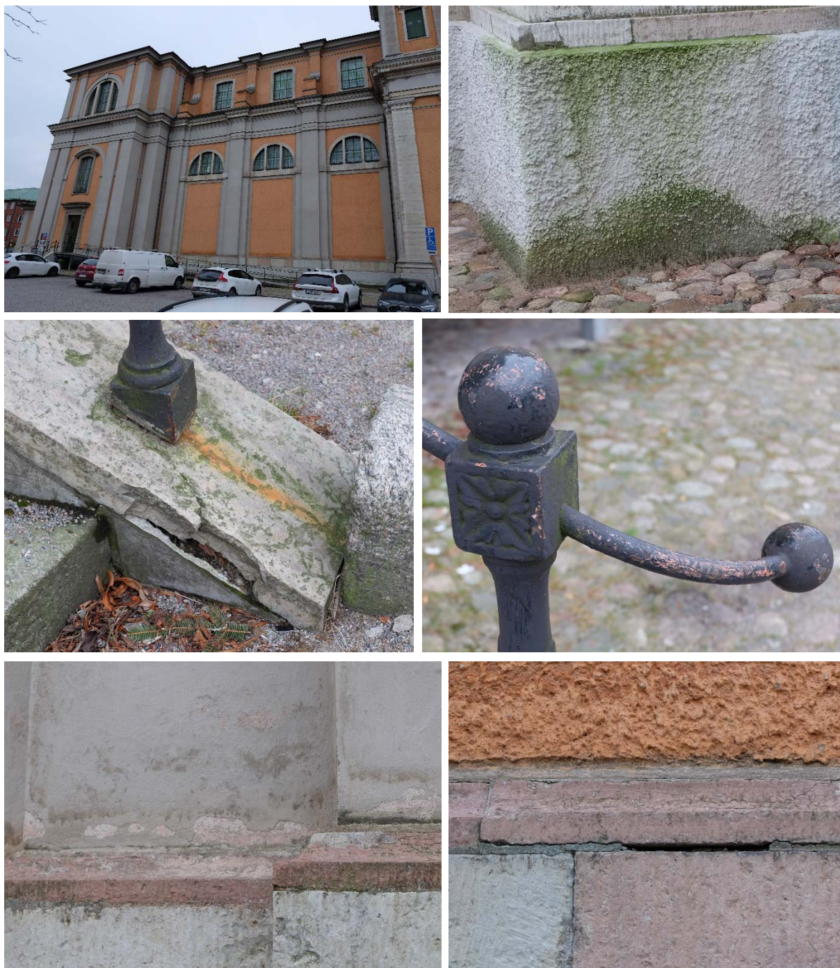
Figur 5 - Överst fr. v: Översiktsbild över den norra fasaden och den norra korsarmen. Algpåväxt på sockeln. Mitten fr. v: Skada i den norra trappans sidostycke. Den norra trappans järnräcken har sliten bemålning. Underst fr. v: Färgbortfall på slätputsat fasadparti. Enstaka fogbortfall förekommer i sockelns stenmaterial.
