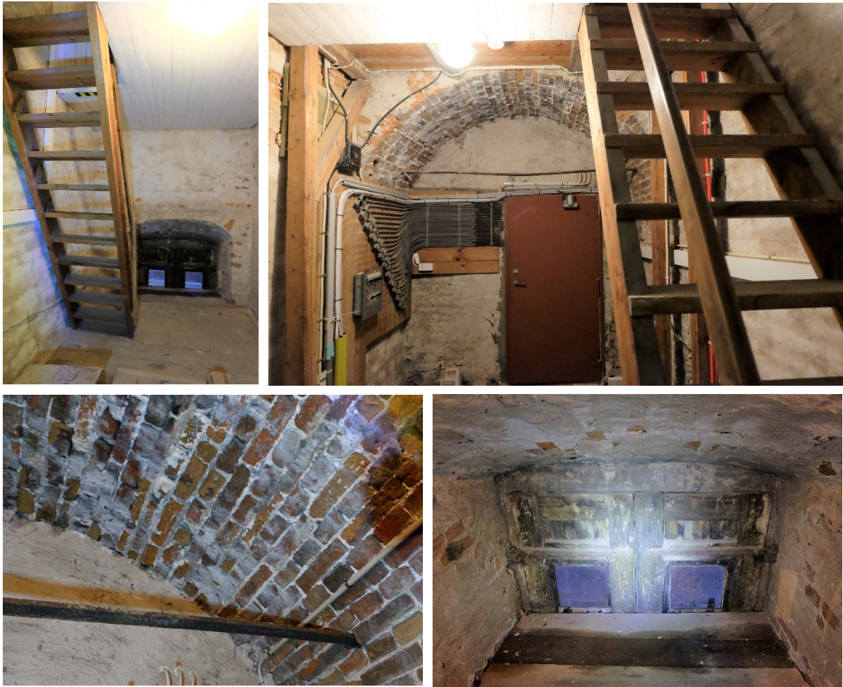
Figur 38 - Överst fr. v: Översiktsbilder över tornrum 1. Underst fr. v: Saltutfällningar i den tunnvalvda delen av utrymmet. Ljudluckorna har fuktfläckar och rostiga järndelar.
