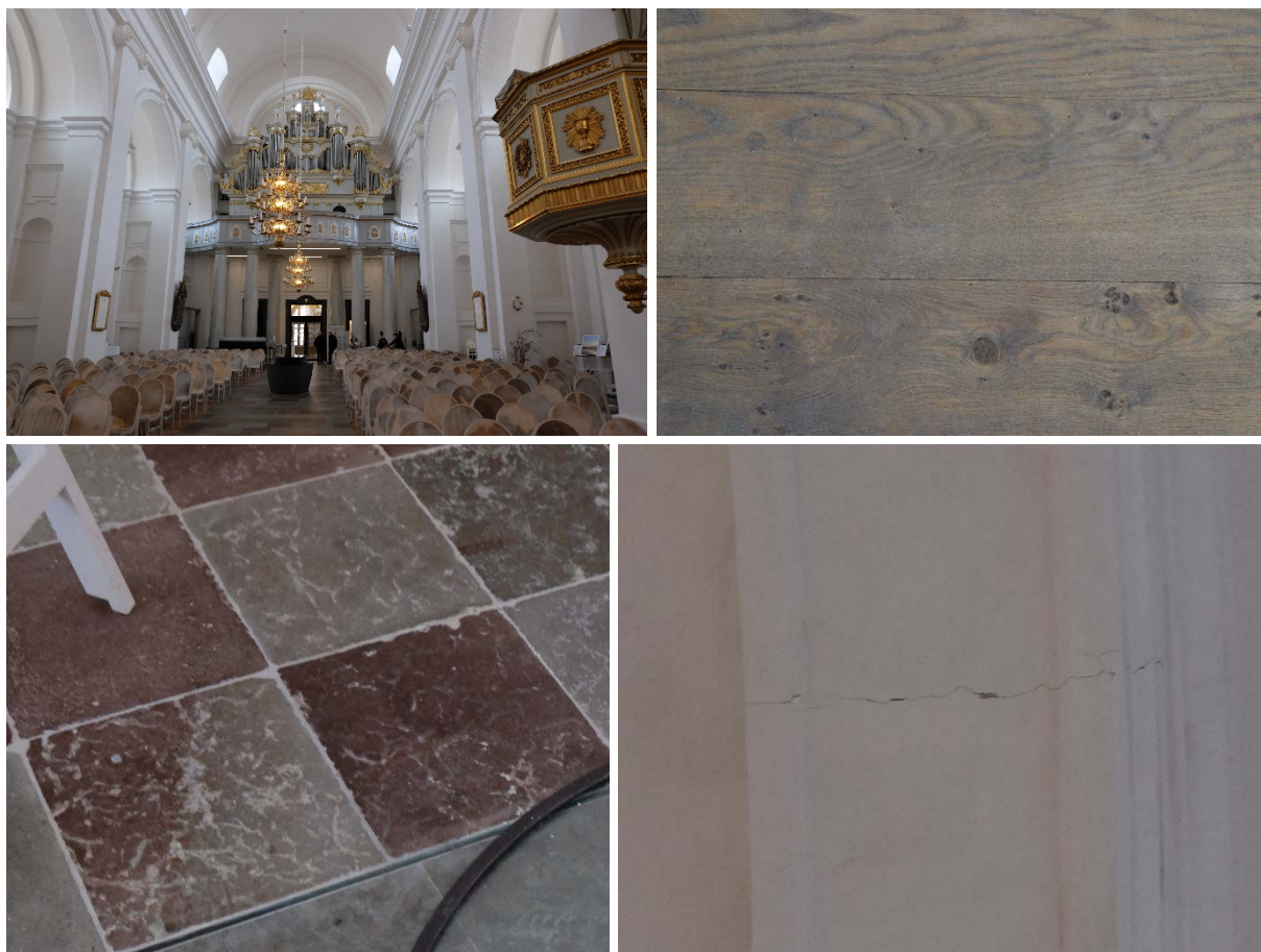
Figur 17 - Överst fr. v: Översiktsbild över långhuset. Trägolvet har ett något matt ytskikt. Underst fr. v: Något vittrat parti av kalkstensgolvet. Spricka i en av valvets gördelbågar.
