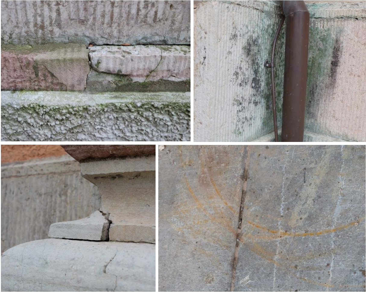
Figur 4 - Överst fr. v: Mindre lagningar och sprickor förekommer i sockeln. Missfärgningar från kopparstuprör på sockeln. Underst fr. v: Lösa delar förekommer i sockelns stenmaterial. Rostutfällningar på entrétrappans översta steg.
