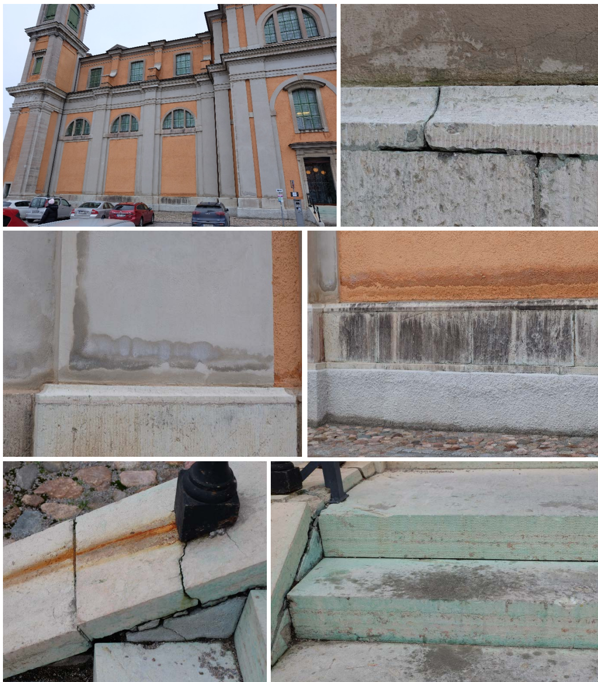
Figur 9 - Överst fr. v: Översiktsbild på den södra fasaden och korsarmen. Mitten fr. v: Saltutfällningar och fuktfläckar på slätputsat parti. Partiella missfärgningar på sockelns stenmaterial samt fuktfläckar på spritputsen. Underst fr. v: Sprickor och rostutfällningar på sidostycket till den södra korsarmens trappa. Den södra korsarmens trappa är missfärgad av koppar.
