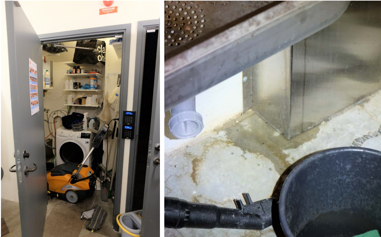
Figur 36 - Fr. v: Översiktsbild över städförrådet. Våt fläck på golvet.
