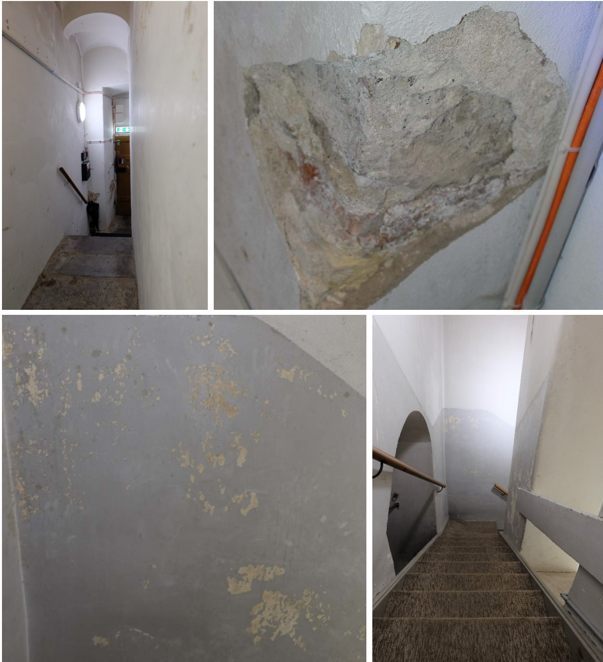
Figur 41 - Överst fr. v: Översiktsbild över det norra tornets bottenvåning. Vittrande puts i trapphusets bottenvåning. Underst fr. v: Flagnande bemålning på trapphusets väggar. Översiktsbild över trapphusets undre del.
