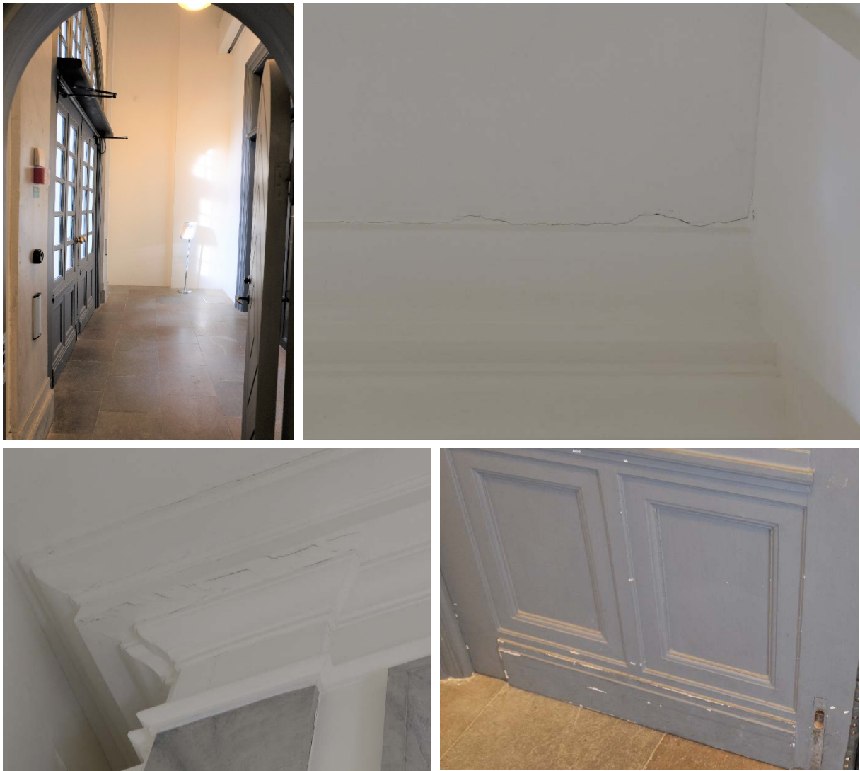
Figur 13 - Överst fr. v: Översiktbild över förhallen. Spricka i taket. Underst fr. v: Flagnande bemålning på den västra dörrens profilerade överstycke. Färgskav på den västra dörren.
