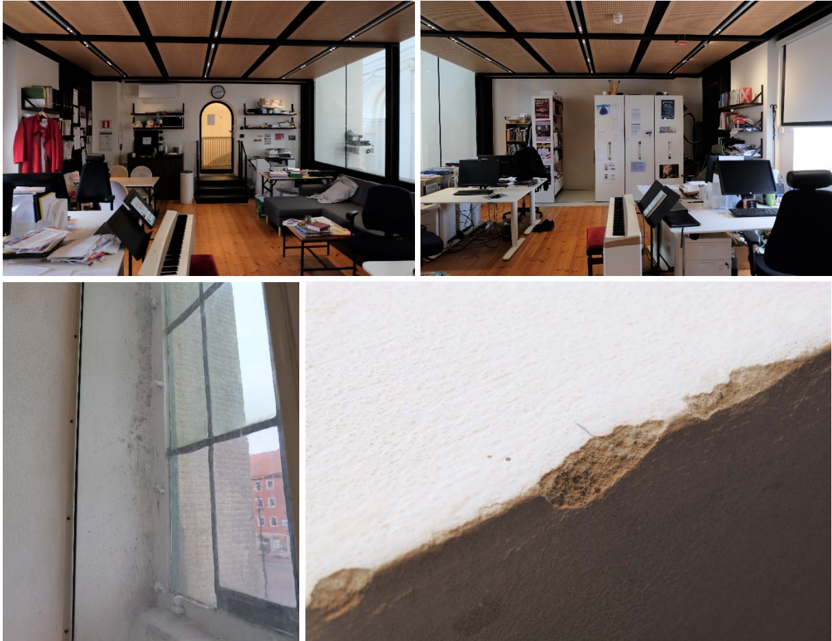
Figur 26 - Överst fr. v: Översiktbild över arbetsrummet på den södra läktaren. Underst fr. v: Mögel mellan fönsterbågarna. Fönsternischens kant är kantstött.
