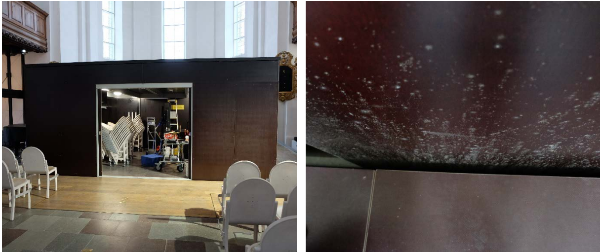
Figur 20 - Fr. v: Det höj- och sänkbara förrådet i upphöjt läge. Påväxt av mögel på förrådets utsida.
