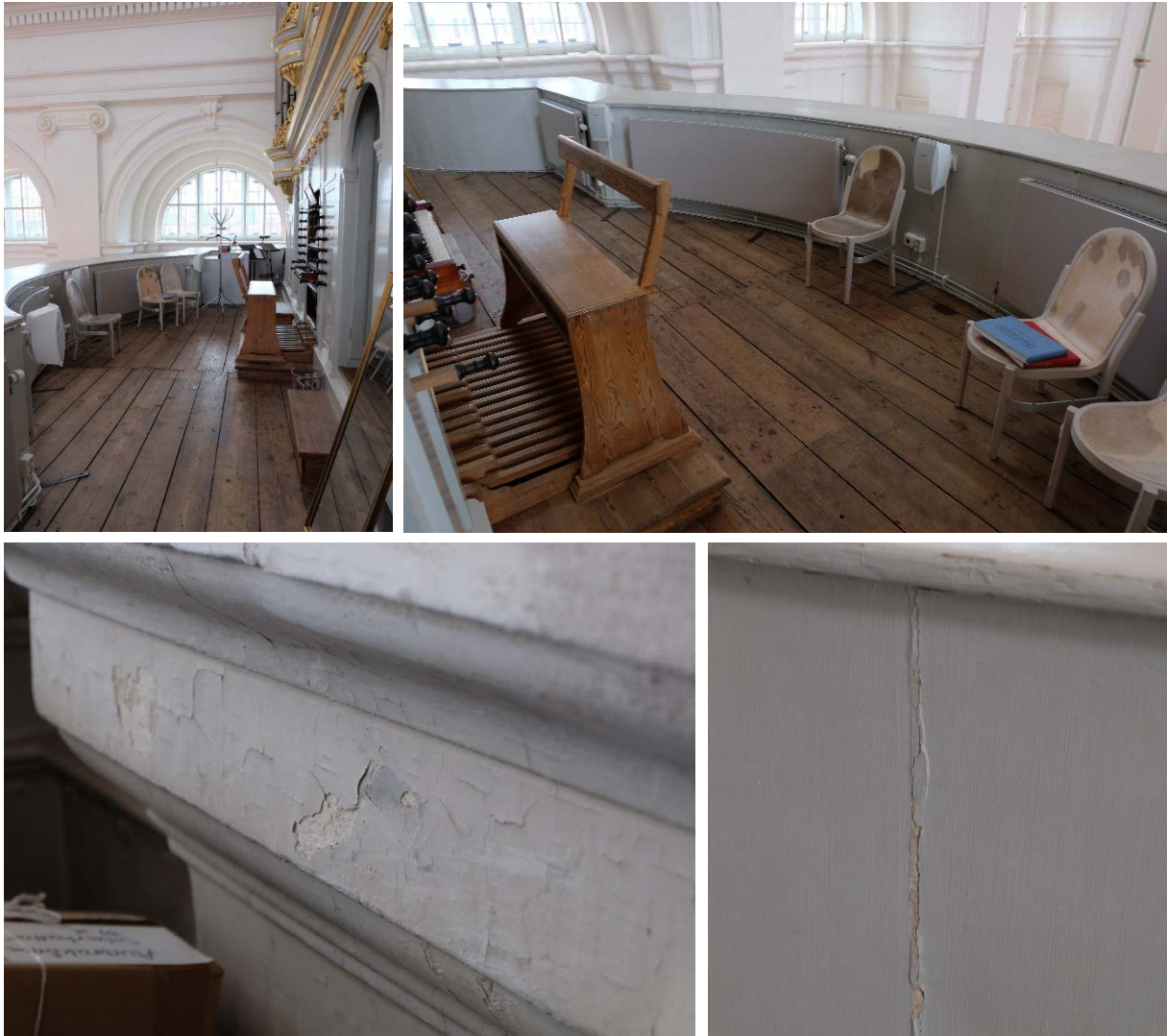
Figur 30 - Överst fr. v: Översiktsbilder över läktarens främre del. Underst fr. v: Kraftigt flagnande bemålning på väggarnas listverk. På läktarbarriären finns sprickor i bemålningen mellan trädelarnas sammanfogningar
