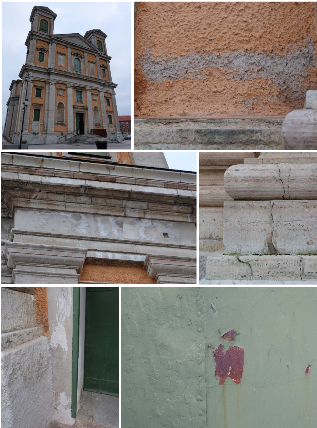
Figur 3 - Överst fr. v: Översiktsbild över den västra fasaden. Vittrad avfärgning på spritputs. Mitten fr. v: Missfärgningar och saltutfällningar på listverk. Sprickor i sockelns stenmaterial. Underst fr. v: Bortfall av avfärgning på omfattningen till det norra tornets ingång. Bortfall av färgskikt på huvudentrés port.
