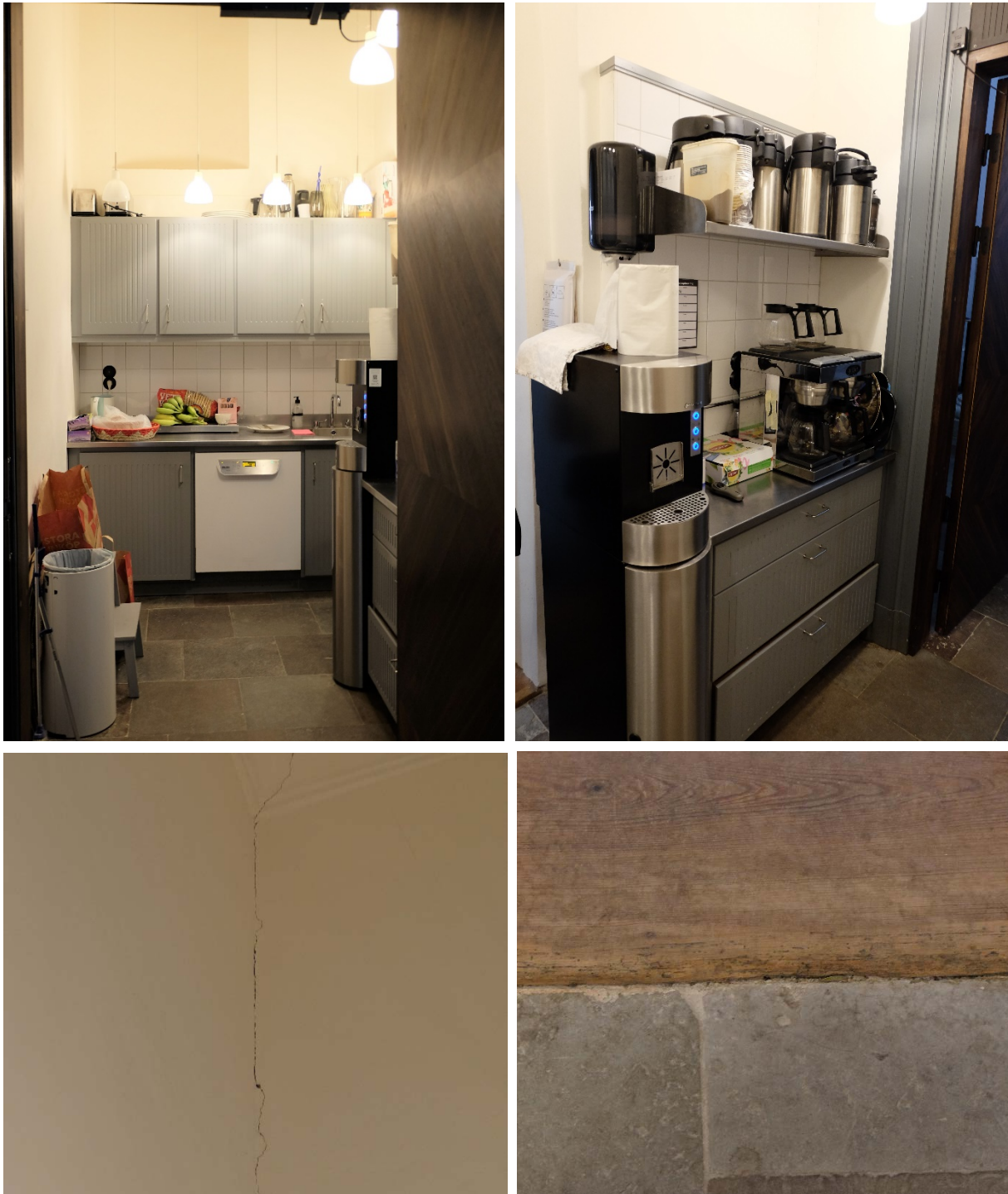
Figur 16 - Överst fr. v: Pentryt sett från öst. Pentryt sett från sydväst. Underst fr. v: Spricka i ett av hörnen i utrymmet. Spår av angrepp från strimmig trägnagare i tröskeln mellan pentryt och det norra tornet.
