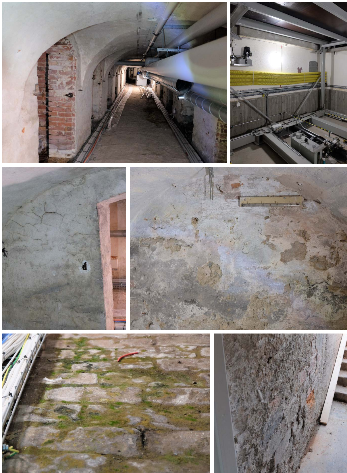
Figur 48 - Överst fr. v: Översiktsbild över korridor med gravkor. Översiktsbild över det gamla pannrummet, i vilket det hög- och sänkbara förvaringsutrymmet är placerat i, i nedsänkt läge. Mitten fr. v: Sprickbildning på vägg i gravkor. Vittrande puts på vägg i gravkor. Underst fr. v: Påväxt av alger på golvet i den norra delen av källaren. Vittrade puts på trapphalsens ena vägg.
