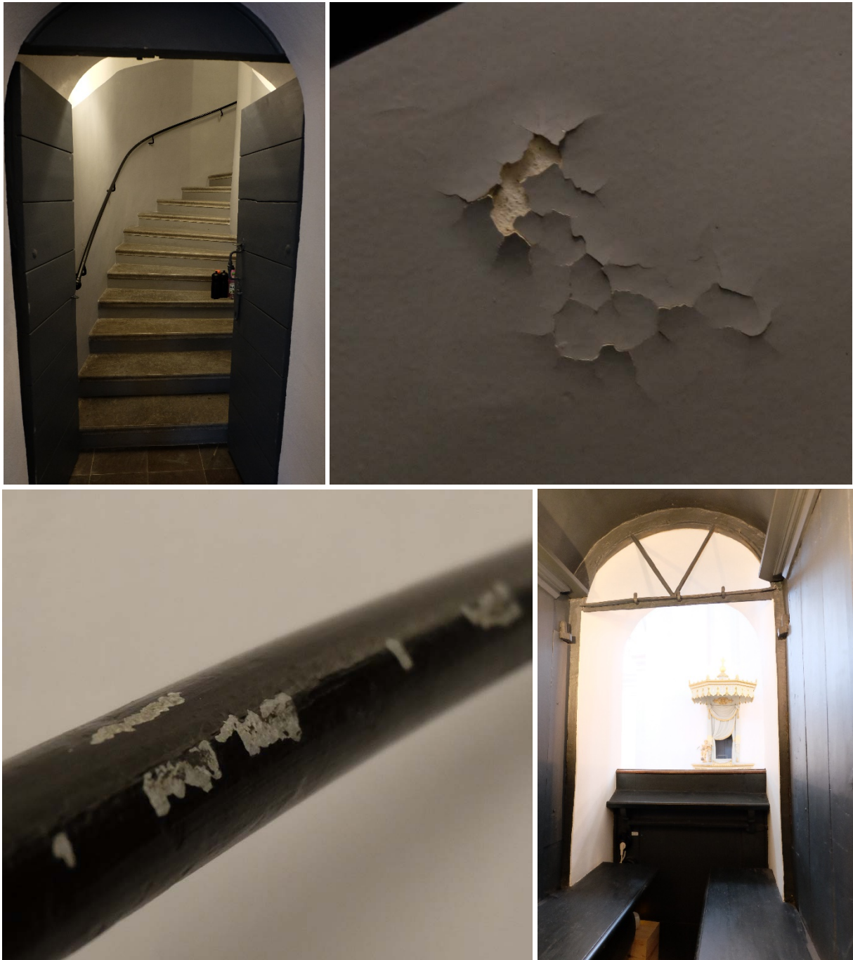
Figur 25 - Överst fr. v: Översiktsbild över den södra läktarens trapphus. Färgflagning på vägg. Underst fr. v: Handledaren har partier med bortnött bemålning. Fångkoret som vetter ut mot kyrkorummet.
