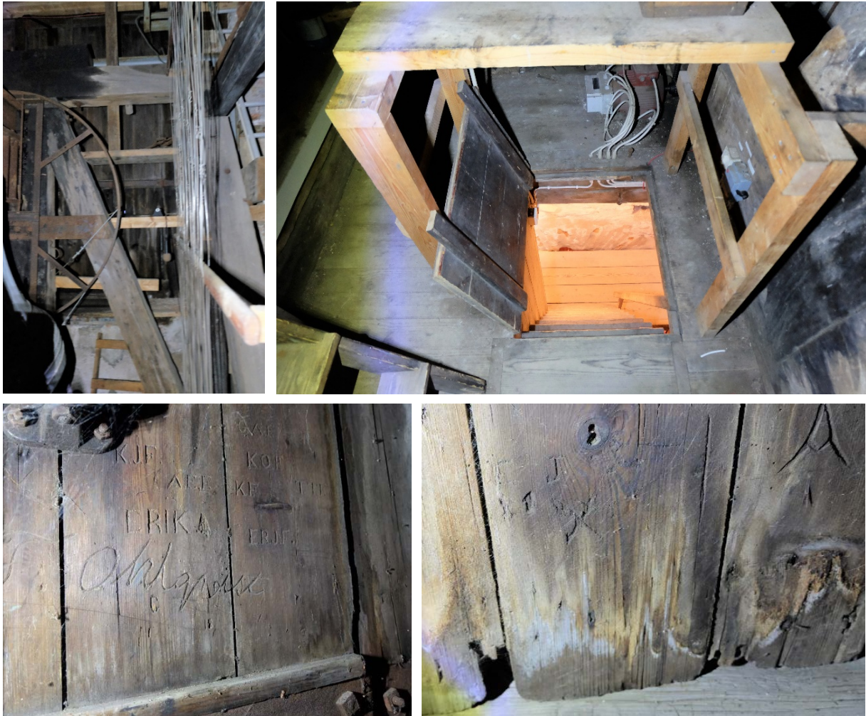
Figur 40 - Överst fr. v: Översiktsbild över klockrummet. Lucka som leder ner till tornrum 2. Underst fr. v: Ljudluckorna har inristade namn och årtal. Mindre rötskador i ljudluckornas nederkanter.
