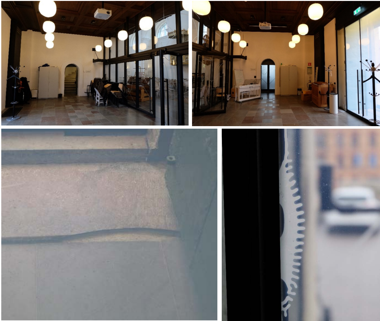
Figur 24 - Överst fr. v: Den södra korsarmen sedd från norr. Den södra korsarmen sedd från söder. Underst fr. v: I vindfånget saknas en kalkstensskärva i golvet. Filmen för insynsskydd är skadad i den södra entrén.
