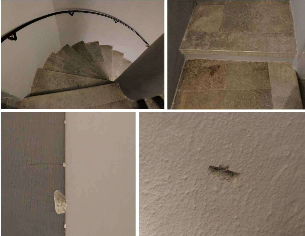
Figur 22 - Överst fr. v: Översigtsbild över den norra läktarens trapphus. Golvet är belagt med kalkstensplattor. Underst fr. v: Små stötskador i utstickande hörn. Stötskada i vägg från dörrblad tillhörande dörren som leder till den norra läktaren.
