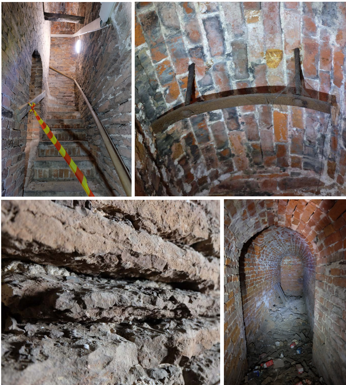
Figur 42 - Överst fr. v: Översiktsbild över den övre delen av det norra tornets trapphus. I trapphusets tak sitter rostiga smidesbeslag. Inslag av spjälkande kalksten i de tegelmurade väggarna. Tunnvälvd gång mot öst.
