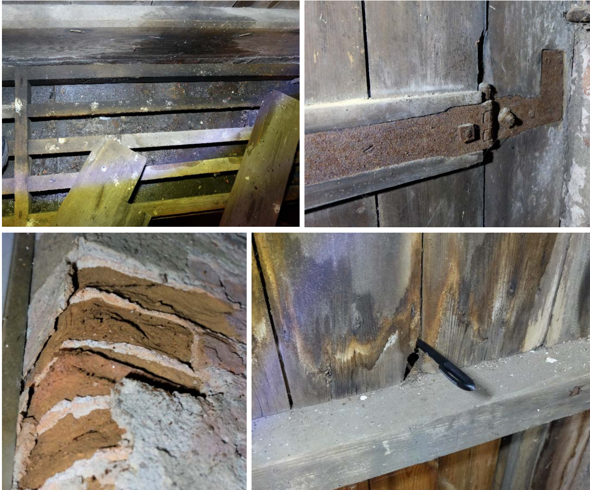
Figur 45 - Överst fr. v: Blött i anslutning till en ljudlucka. Ljudluckornas järndelar är rostiga. Underst fr. v: Skadade/vittrande tegelstenar. Rötskadat parti i en ljudlucka.
