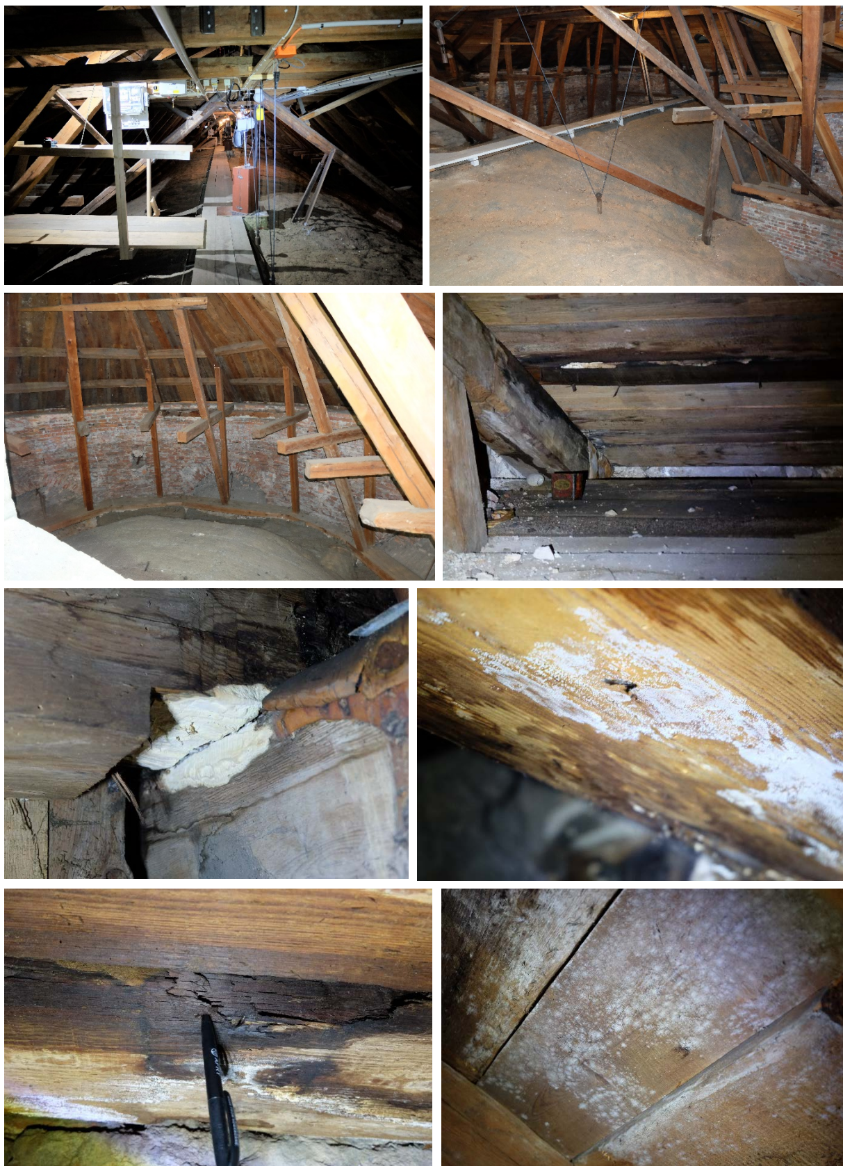
Figur 47 - Överst fr. v: Översiktsbild över långhusvinden. Översiktsbild på vinden över den södra korsarmen. Andra raden fr. v: Vinden över absiden. Svampangrepp och läckage. Tredje raden fr. v: Svampangrepp. Påväxt av mögel. Underst fr. v: Rötskada. Mögelpåväxt på takets underbrädning.
