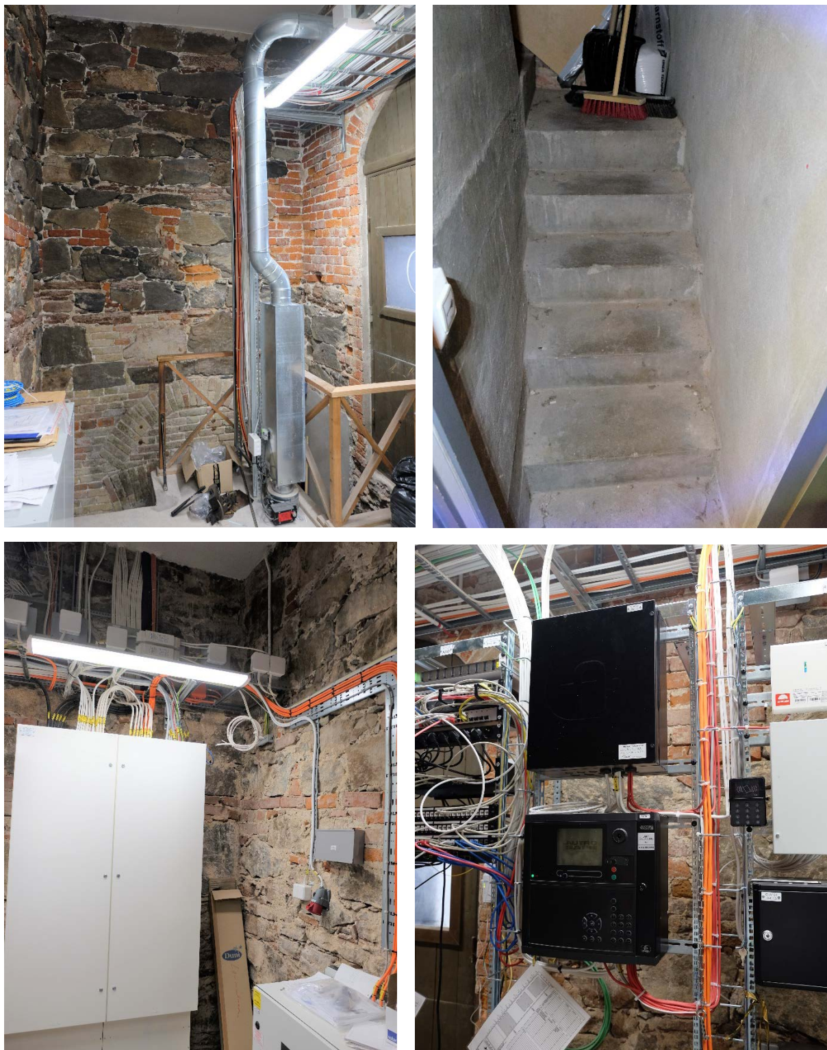
Figur 37 - Överst fr. v: Översiktsbild på teknikrummet. Trappan som leder upp till teknikrummet. Underst fr. v: Elektriska installationer.
