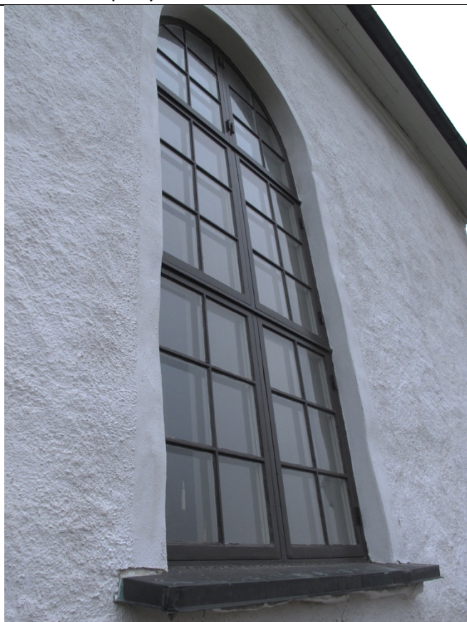
Kyrkfönster, observera den ojämna slätputsen!
