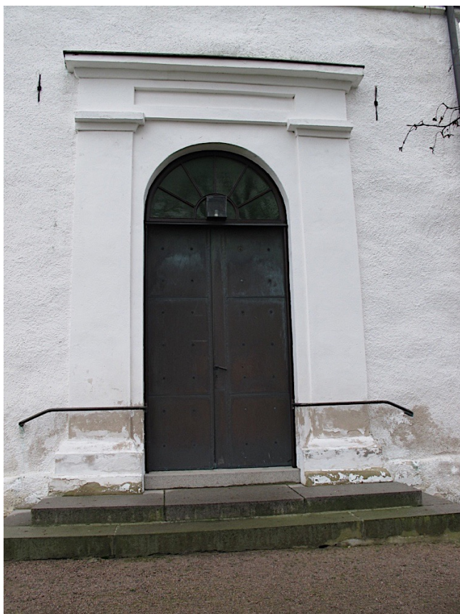
Västportalen. Obs felaktigt avskurna pilasterkapitäl.
