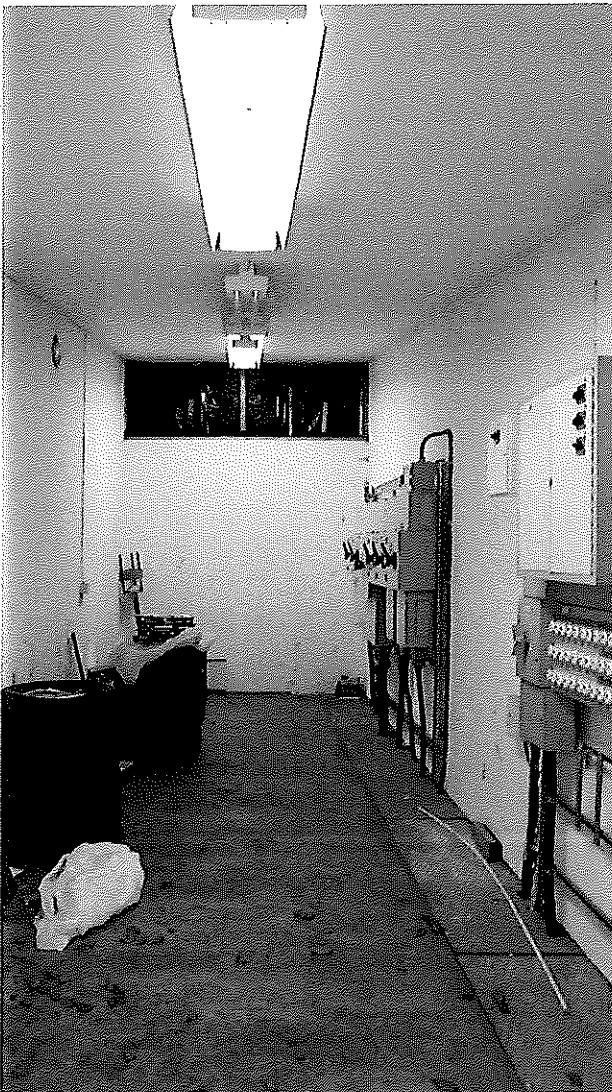
Figur 20 – Interiören till elcentralen i byggnadens norra del.
