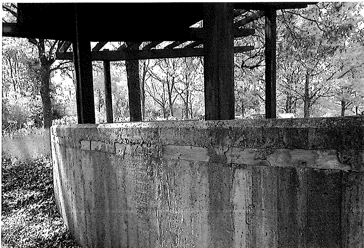
Figur 24 - Ovanpå de gjutna murarna fanns tidigare en kopparplåt. De har stulits och itne ersatts.
