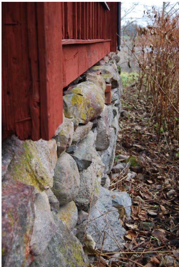
Den "kalvande" manshöga grunden på sydsidan.
