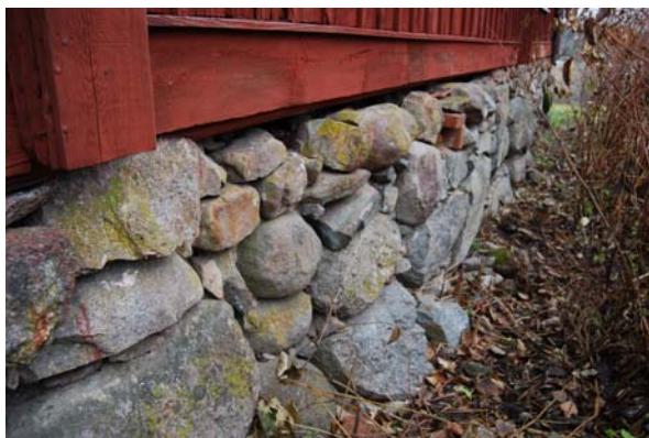
Den manshöga grunden på byggnadens baksida håller på att rasa.
