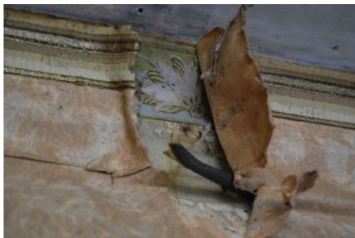
Övertapetserad elledning samt taklist i salen.
