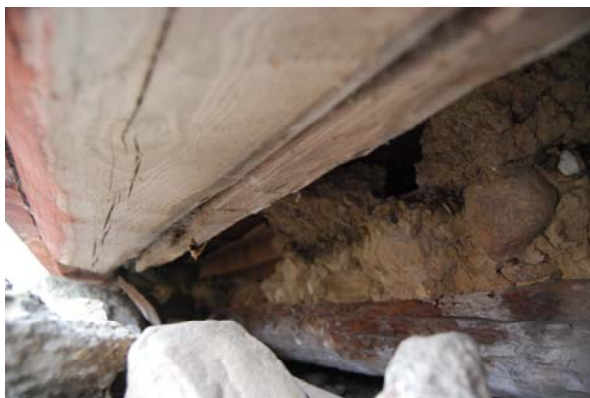
Syllen sedd underifrån på baksidan av huset, där grunden håller på att rasa ut.
