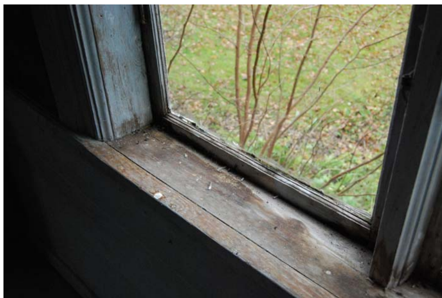
Fönstren är allmänt i stort behov av åtgärder i hela byggnaden. Här en av de fuktskadade fönsterbänkarna.
