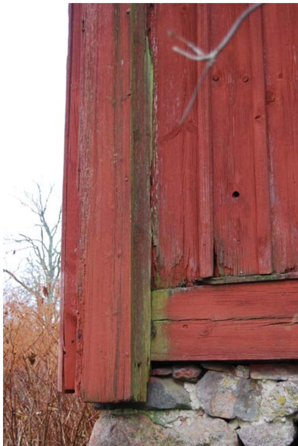
Panelen är i behov av vissa åtgärder som här vid svdöstra knuten.
