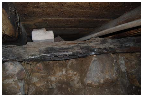
Brandskadad syllstock ovanpå den murade källarväggen.
