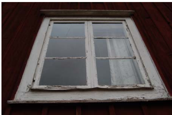
Ett av fönstren med 1800-talsbeslag på sydsidan. Fönstren är i behov av åtgärder.
