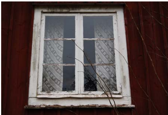
Ett av fönstren med 1800-talsbeslag, här på östra gaveln. Fönstren är allmänt i stort behov av åtgärder.
