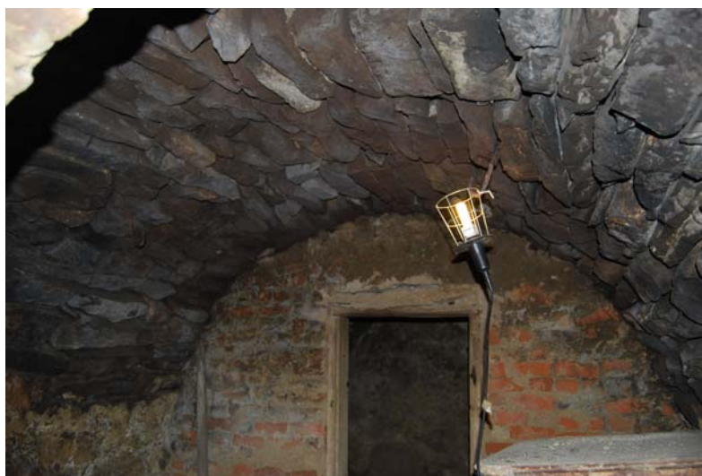
Det yttre källarutrymmet med sitt tunnvalvda tak av sten, som är mycket mörkt. Har det varit utsatt för brand eller brandrök?
