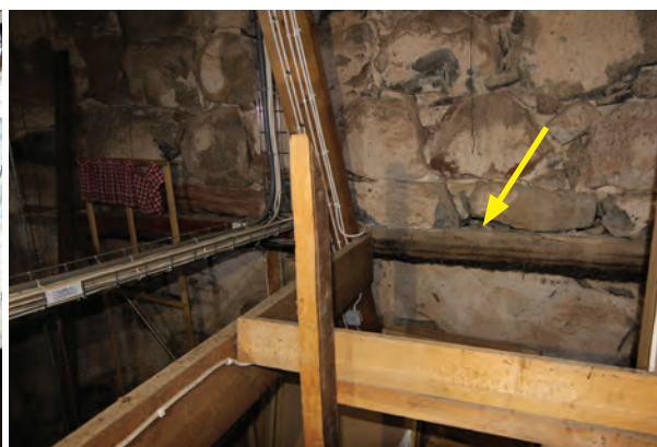
Brandpåverkad bjälke i östra väggen.
