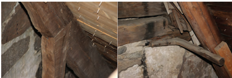
Förbindning stödben och höghen i vapenhuset till vänster och höghen förankrad i remstycke med rotben. Foto: Daniel Eriksson.
