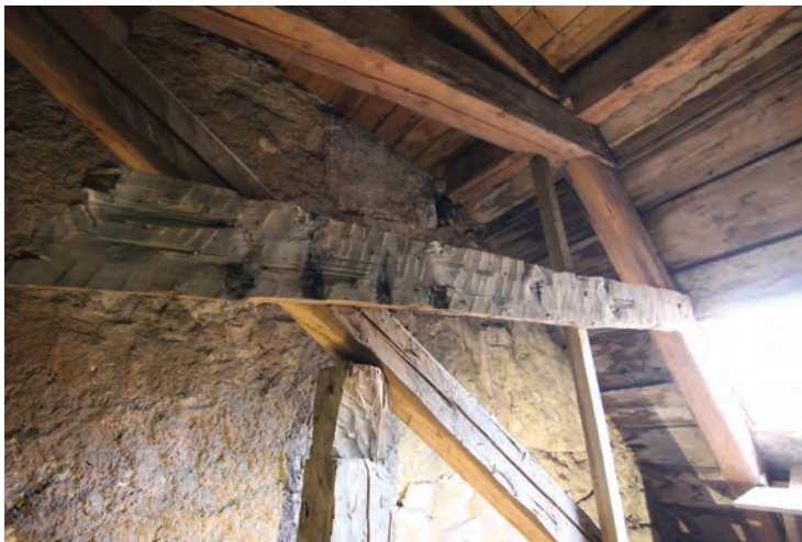
Sprättäljd och brandpåverkad f.d. taktrobräda, påspikad på en takstol nära takluckan.
