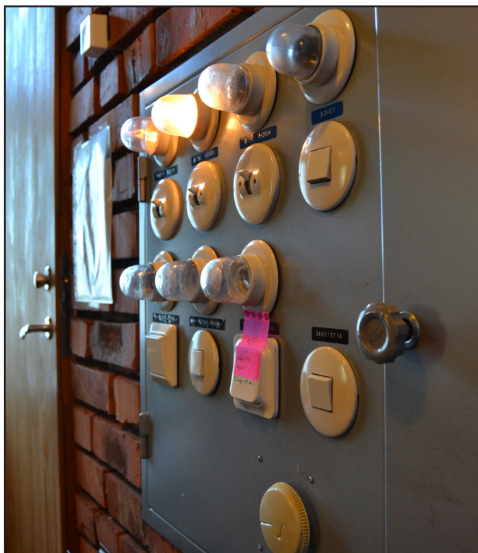
Från sakristian styrs belysningen. Panelen har indikatorlampor.
