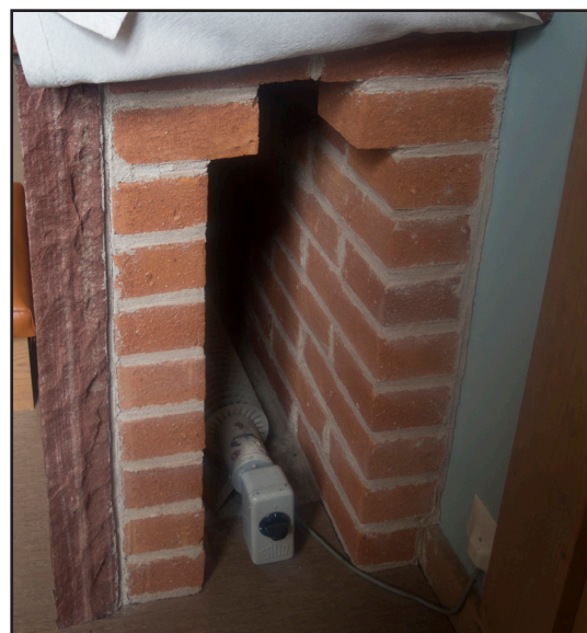
En radiator är inbyggd i altaret, som har en front av älvdalskvartsit.
