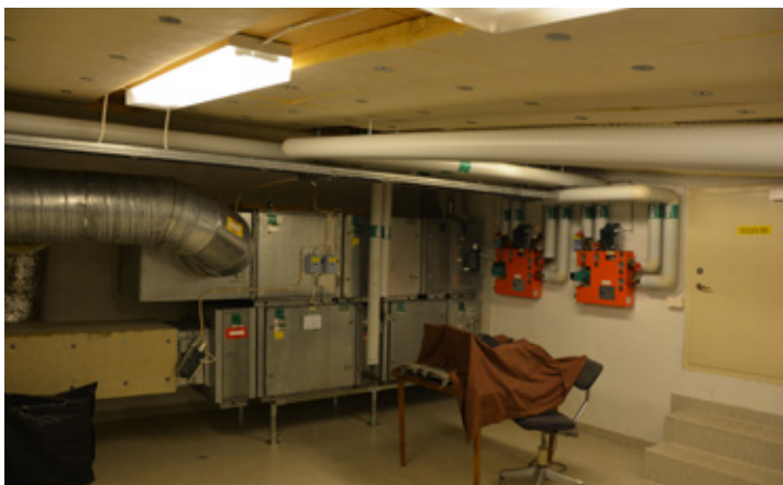
Fläktrum i tillbyggnadens vind. Vlm-modkaVB-1221.
