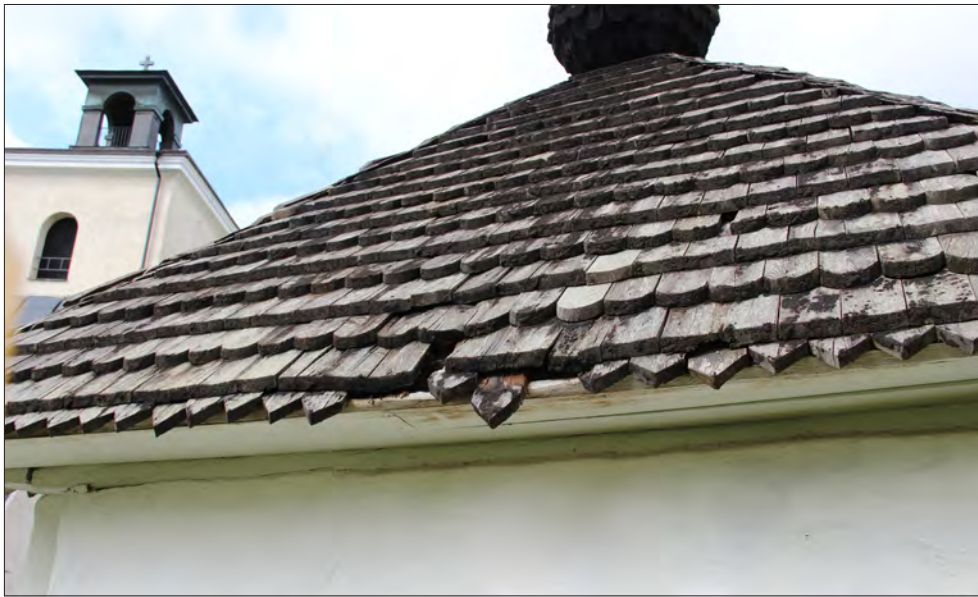
Tillberga kyrka. Rötskador i norra sticluckans spåntäckning.
