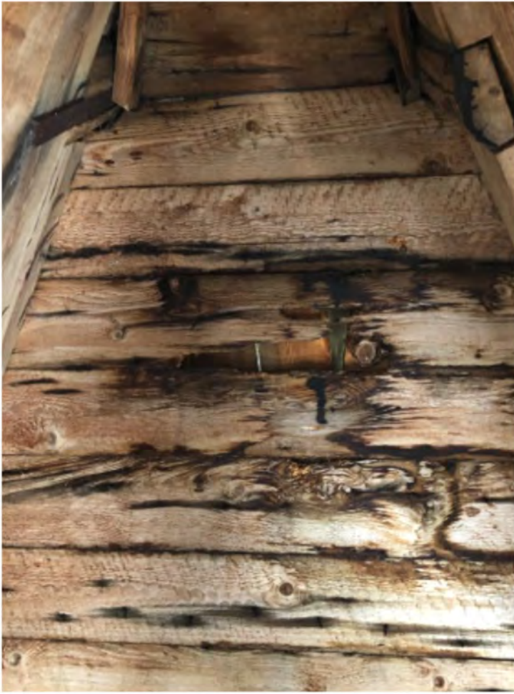
Rötskada i takhuvens undertak, norra sidan.
