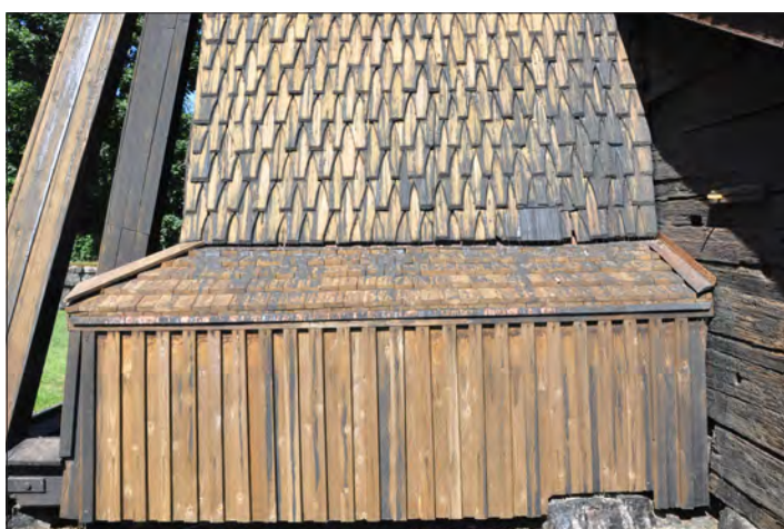
Torsågs klockstapel. Spåntäckningen på södra kragen består av maskin- hyvlade bräder, lagda efter 2015.
