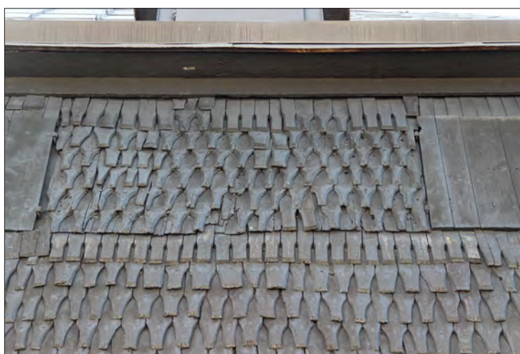
Svedvi klockstapel. Högt upp på norra fasaden i nivå med ljudluckorna finns ett extra intressant parti med olika spån. De näbbformade spånen i jämna dimensioner bedöms ha en högre ålder jämfört med övriga näbbformade spån på norra och västra fasaderna. Mellan ljudluckorna och i liv med deras underkant löper ett skift med raka spån som har fasningen inåt. Detta skift kan berätta om en tidigare utformning av stapelns exteriör men en mer noggrann undersökning skulle behöva göras.
