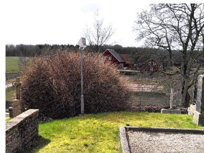
Fasadbelysning på stolpe
