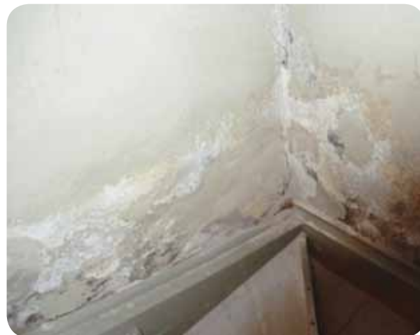
Saltskador på insidan av yttermuren.
