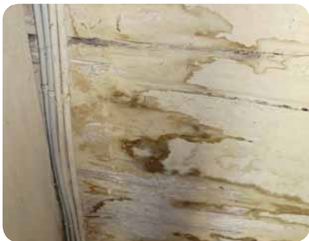
Fuktrosor i taket.
