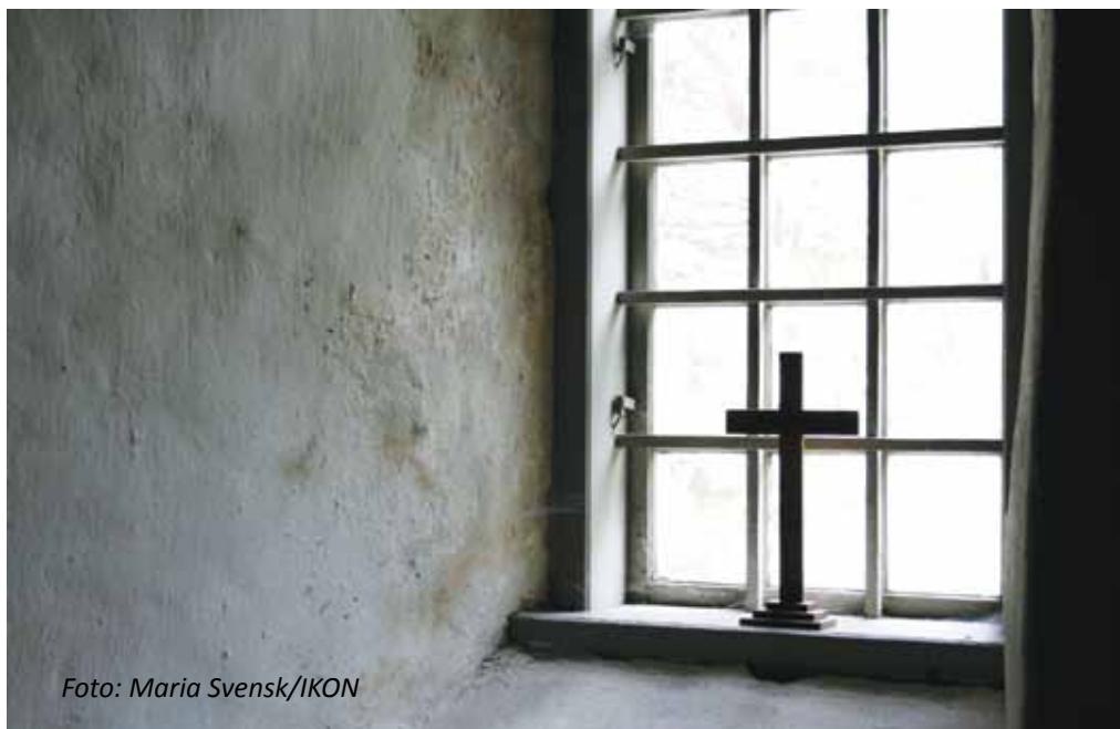
Fuktskada på vägg vid fönster.
