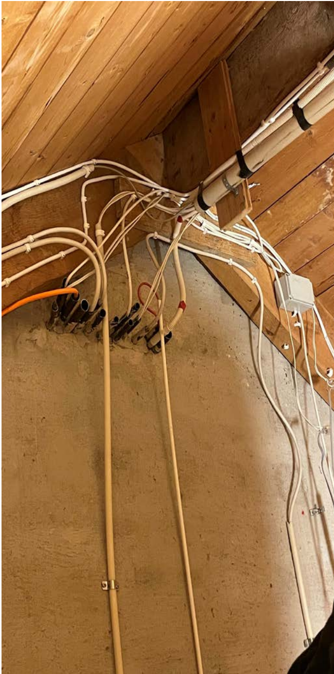
Kabelöverföring på vinden i sakristian, mot vinden ovanför kyrksalen.
