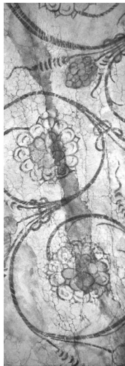
Fuktskador på kalkmåleri, Strängnäs. Foto: L. Göthberg.
