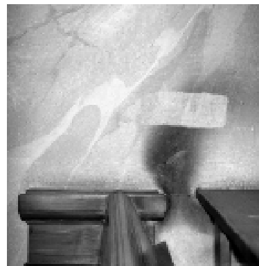
Hur smutsen avsatts på ytan avslöjar här ett elements placering. Den rena rutan är ett rengöringsprov. Hedvig Eleonora kyrka. Foto: I. Hemgren.
