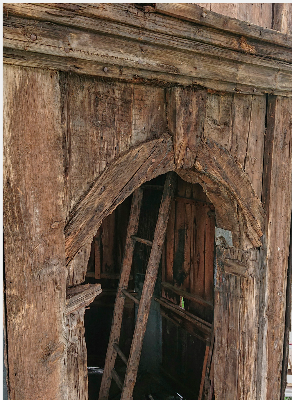
Timmer angripet av skadedjur och röta.
