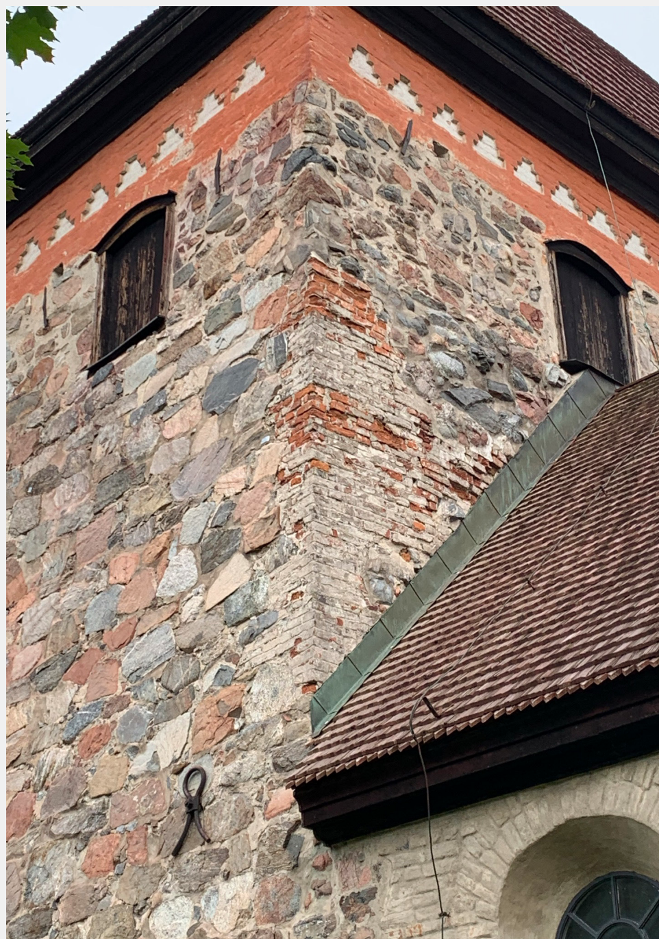
Skador på tornets fasad.
