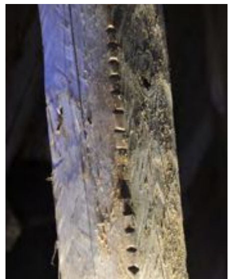
Hack i bjälke ovan koret.
