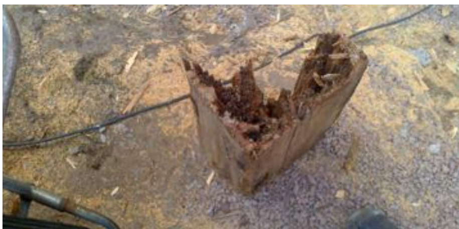
Mycket rötskadad bjälke.
