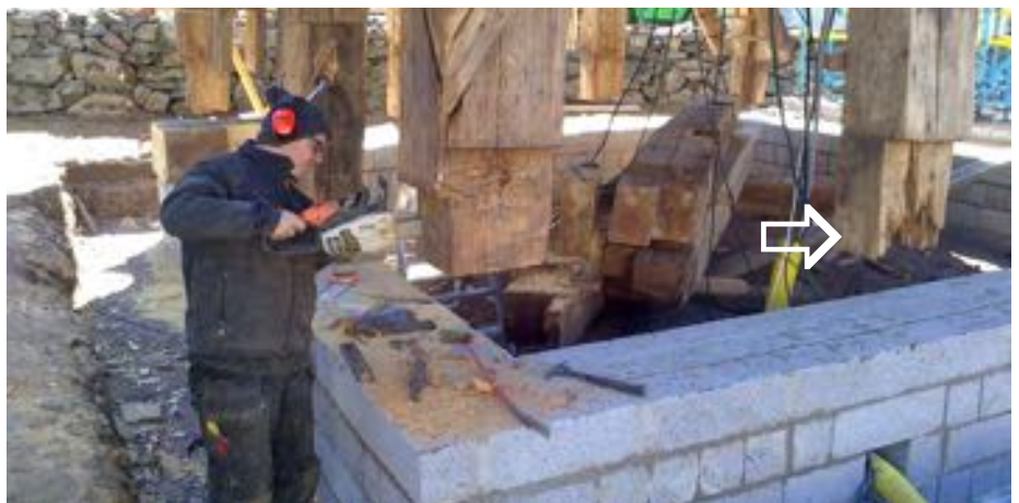
Till höger ses en av de lokala rötskador som ska lagas.
