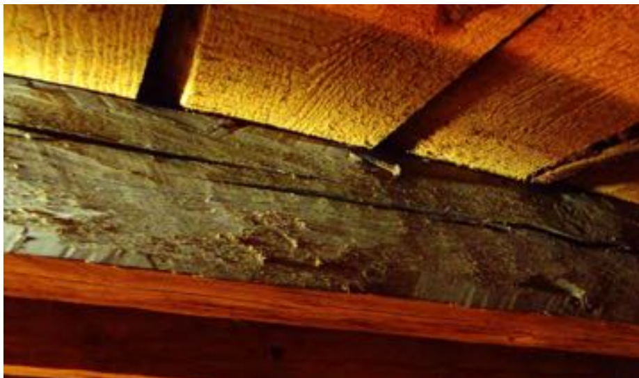
Bjälke med spår av efterbredbilning, Gökhems kyrka.
